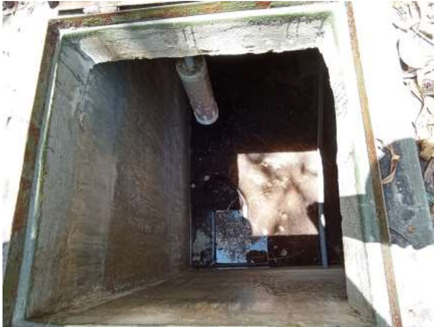
Fotografía 6. Reservorio con Hipo clorador en desuso.
