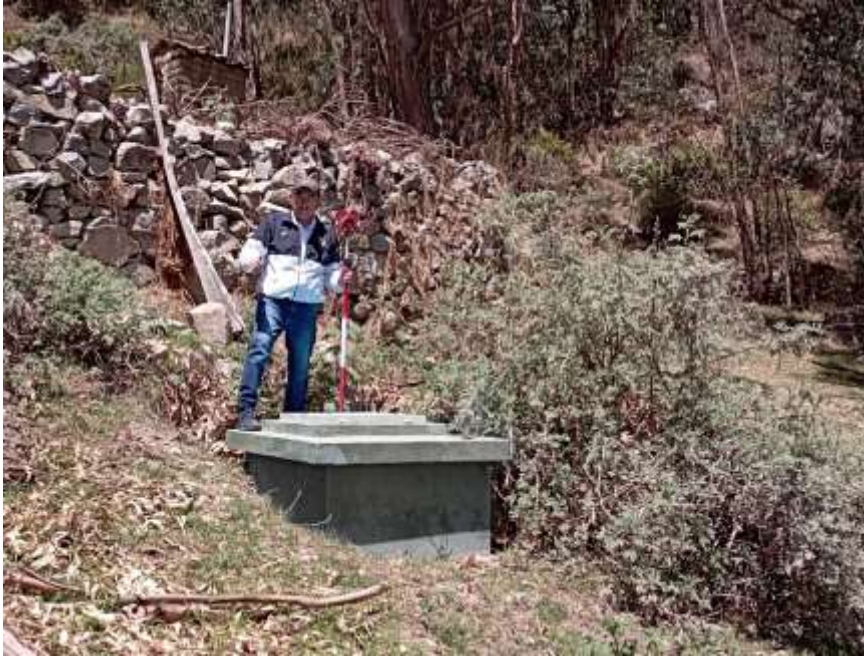
Fotografía 5. Cámara Rompe Presión.
