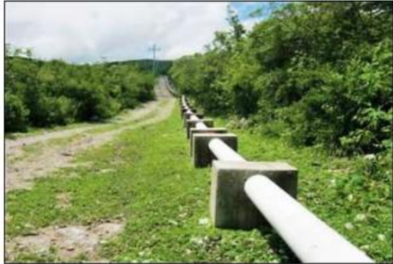
Figura 04. Línea de conducción
