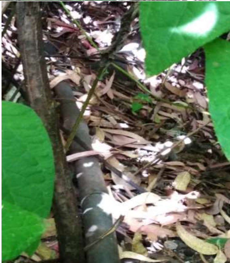
Imagen 04 y 05: aquí podemos ver las tuberías de la línea de conducción que se encuentra deteriorada y rota por lo que ya intentaron repararlo.
