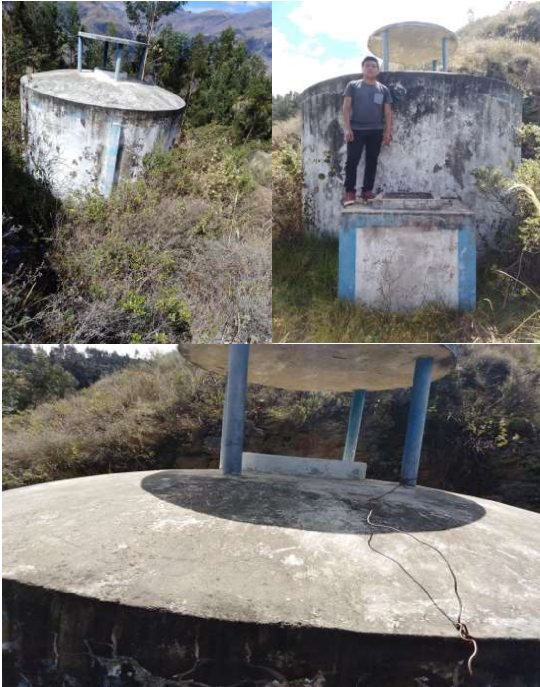
Imagen 06, 07 y 08: el reservorio como podemos apreciar en las imágenes no están en buen estado, los accesorios interiores se encuentran deteriorados y el lugar donde se encuentra sé que está un poco abandonado.
