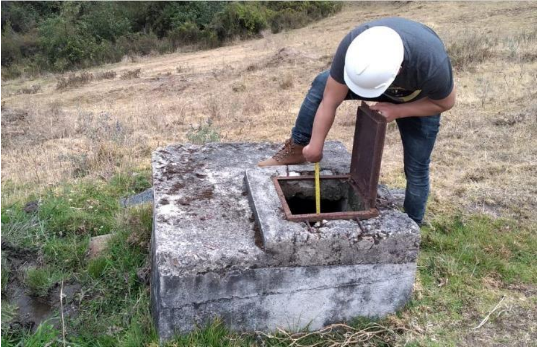
Imágen 6 Cámara rompe presión deteriorada
