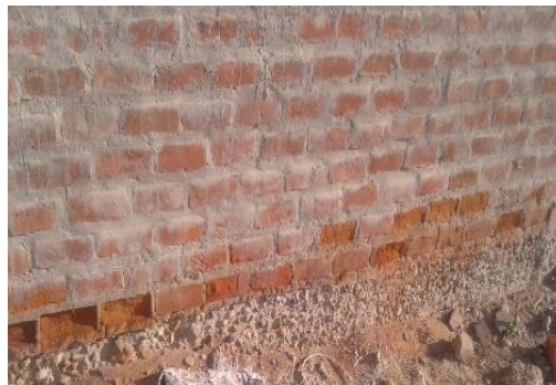
Figura 11 Erosión en muros de albañilería
