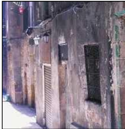
Imagen 37: Ataque Físico a edificación por ensuciamiento por lavado diferencial.
