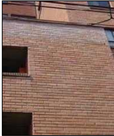
Imagen 36: Ataque Físico a edificación por ensuciamiento por depósito.
