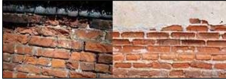
Imagen 41: Erosión en muros de albañilería.
