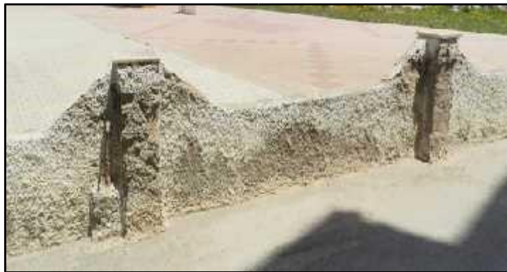
Imagen 35: Ataque Físico a edificación por erosión atmosférica.
