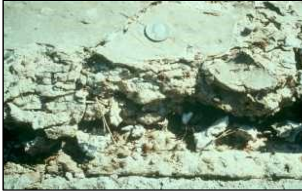
Imagen 48: Desintegración del concreto.
