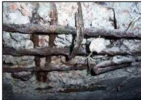
Imagen 33: Ataque por Corrosión a elementos de Concreto Armado.
