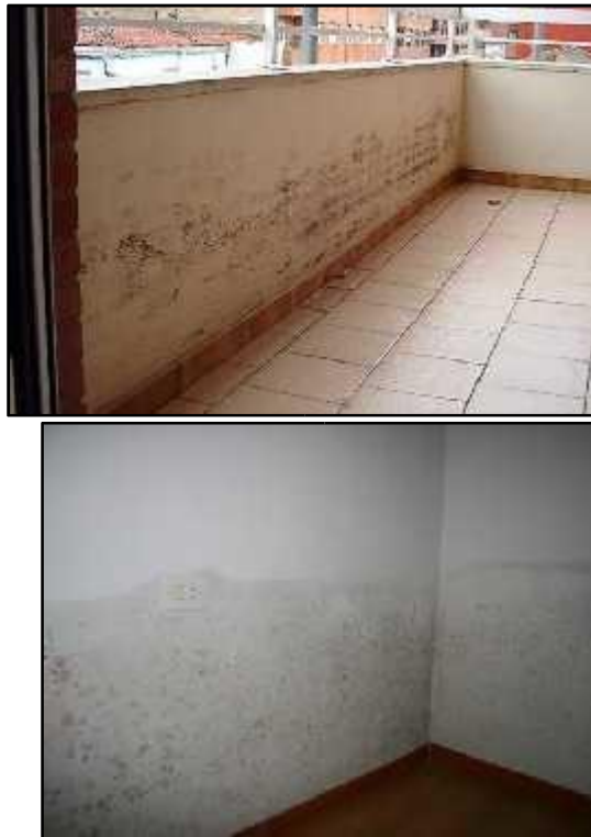
Imagen 34: Ataque Físico a edificación por Humedad de Infiltración.
