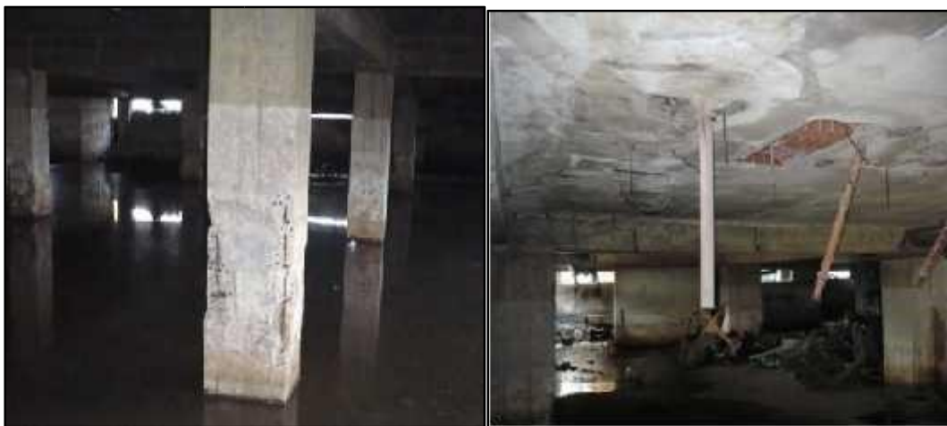
Imagen 02: Daños en columnas semisótano . Imagen 03: Daños en losa de sótano.
