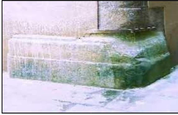
Imagen 38: Ataque biológico a estructura de concreto por biocapas.
