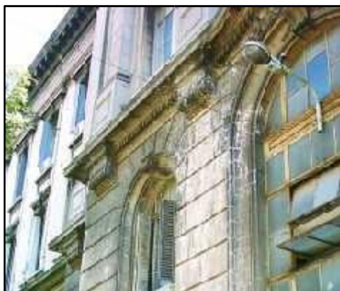
Imagen N°49: Fachada afectada por suciedad y rajaduras múltiples.
