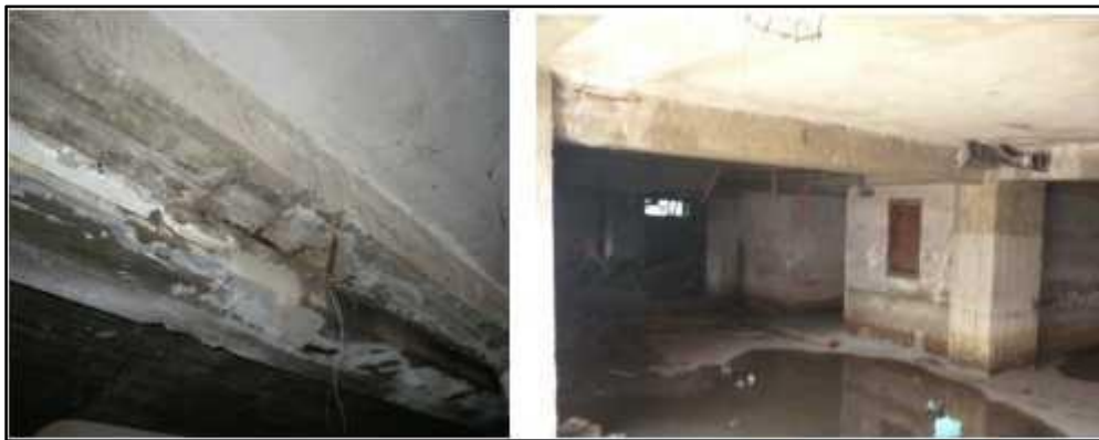
Imagen 06: Daños en vigas planta baja.
