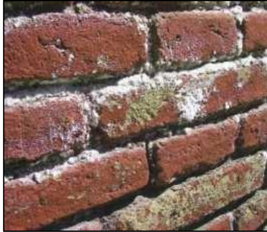
Imagen 45: Presencia de Eflorescencia (sales) en concreto y muros de albañilería.
