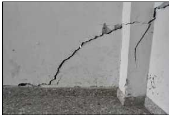
Imagen 39: Fisuración y Agrietamiento por asentamiento de la estructura.
