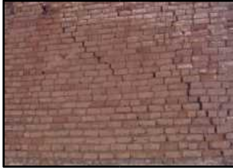
Imagen 40: Patologías presentadas en muro de albañilería.
