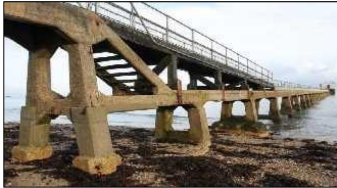
Imagen 26: Ataque químico por contacto directo en profundidades del agua de mar.
