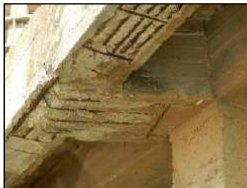
Imagen 32: Ataque por carbonatación a estructuras de C°A°.
