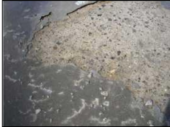
Imagen 44: Delaminación del revestimiento provocada por materiales de propiedades físicas no similares.
