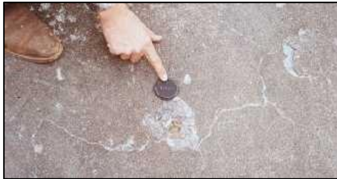
Imagen 47: Popouts O Cráteres en el concreto.
