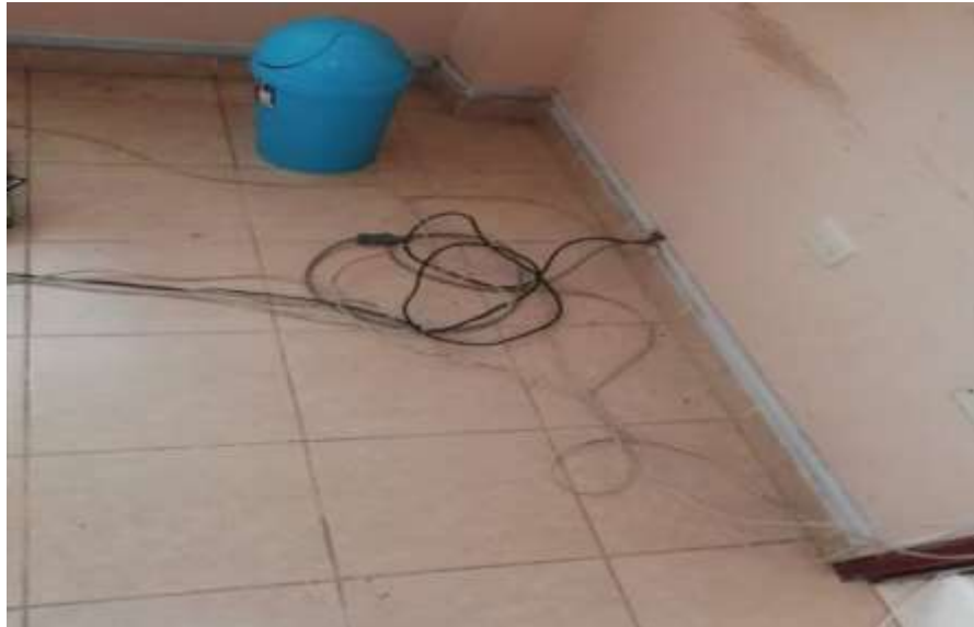
Cableado de la botica
