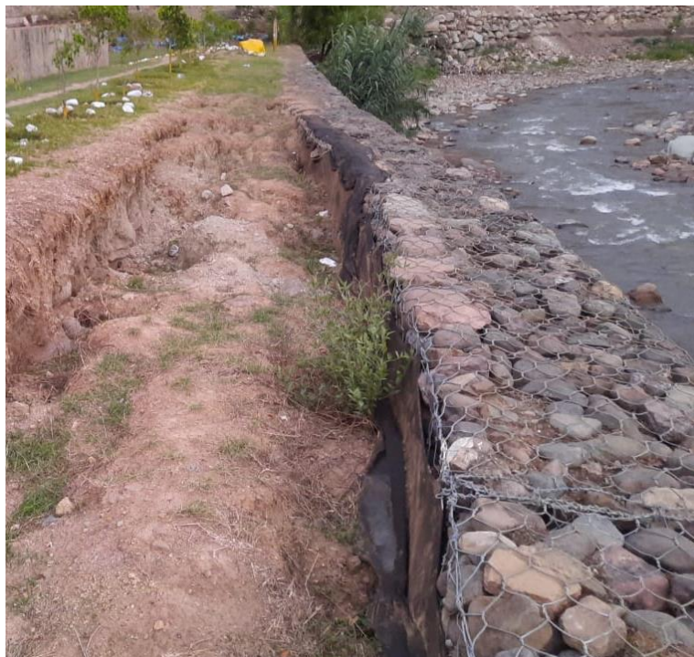
Figura 30: geomembranas desgastadas Fuente: Evidencia de campo
