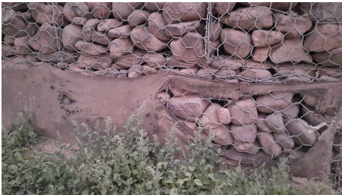
Figura 25: Identificando de geomembrana en mal estado y deflexión de mallas Fuente: Evidencia de campo
