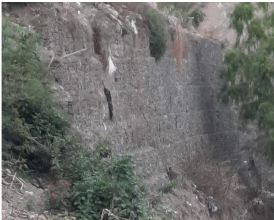
Figura 23: Presencia de desmonte y maleza en muros de gaviones Fuente: Evidencia de campo
