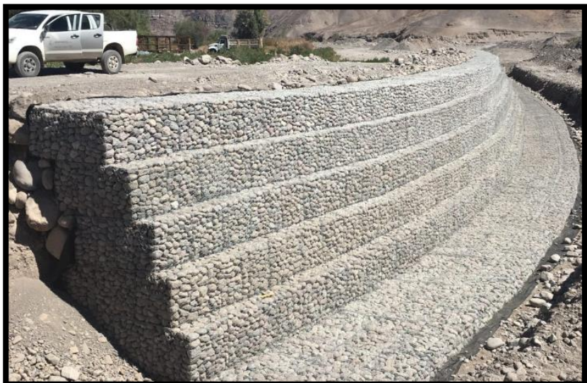
Figura 2: Muro de gaviones
