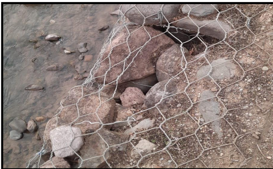
Figura 14: Se aprecia desprendimiento de mallas hexagonales
