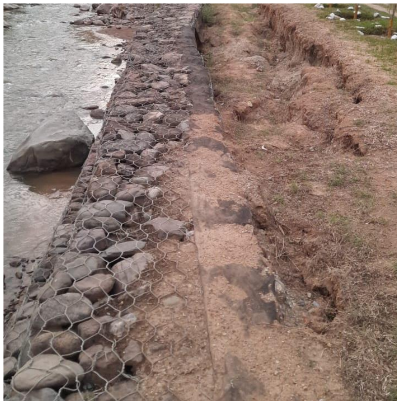
Figura 31: Vista panorámica del mal estado de geomembranas Fuente: Evidencia de campo
