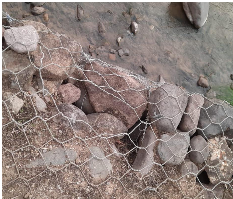
Figura 32: rotura de mallas hexagonales Fuente: Evidencia de campo
