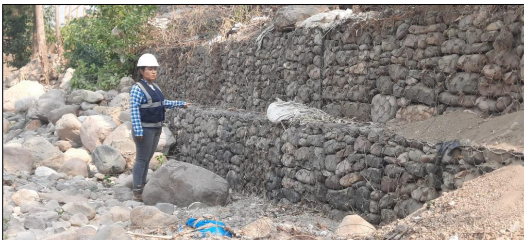
Figura 34: rotura de mallas hexagonales Fuente: Evidencia de campo
