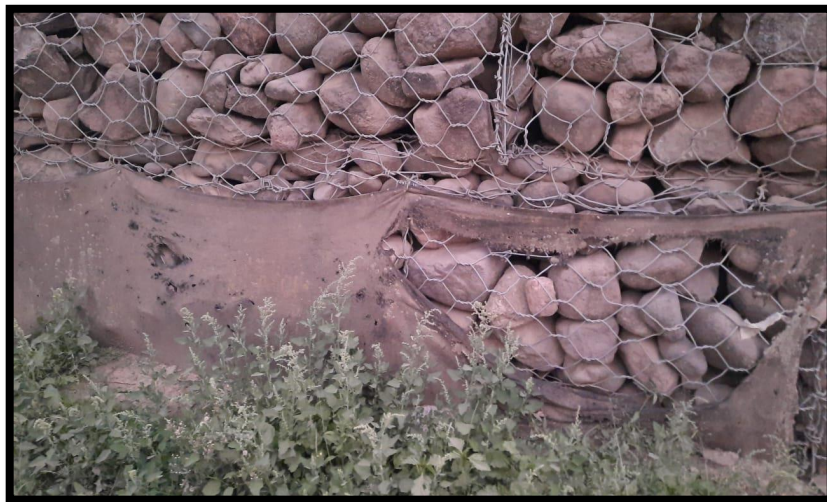
Figura 15: Se aprecia geotextiles desgastados
