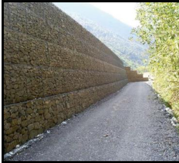
Figura 8: Muro de gaviones
