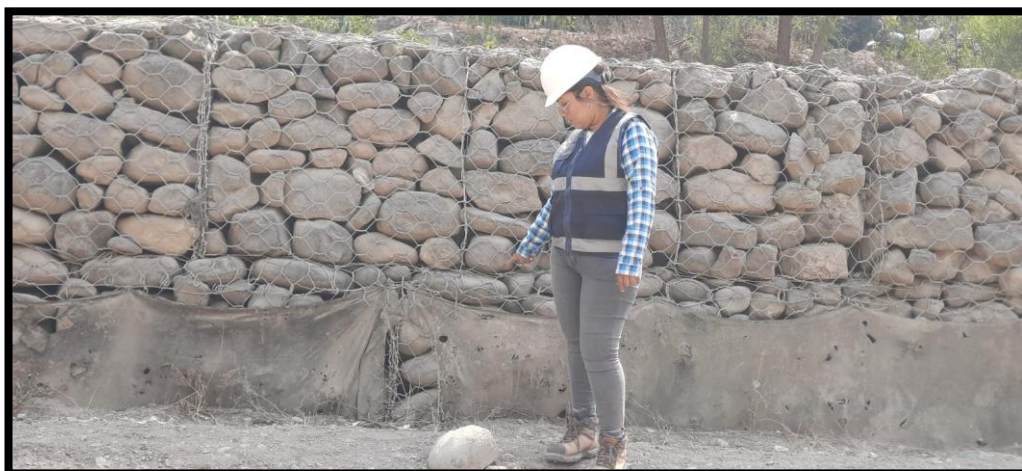
Figura 17: Se aprecia desmonte y sedimento en la cara de los gaviones
