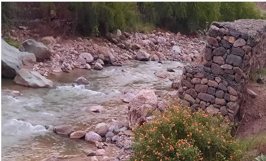
Figura 27: presencia de sedimentación y rocas en la base de los gaviones Fuente: Evidencia de campo
