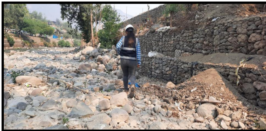
Figura 16: Se aprecia desmonte y sedimento en la cara de los gaviones
