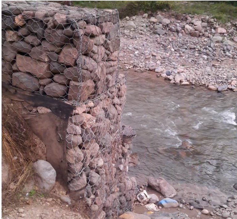
Figura 29: Identificando mal llenado de cajas de gaviones Fuente: Evidencia de campo
