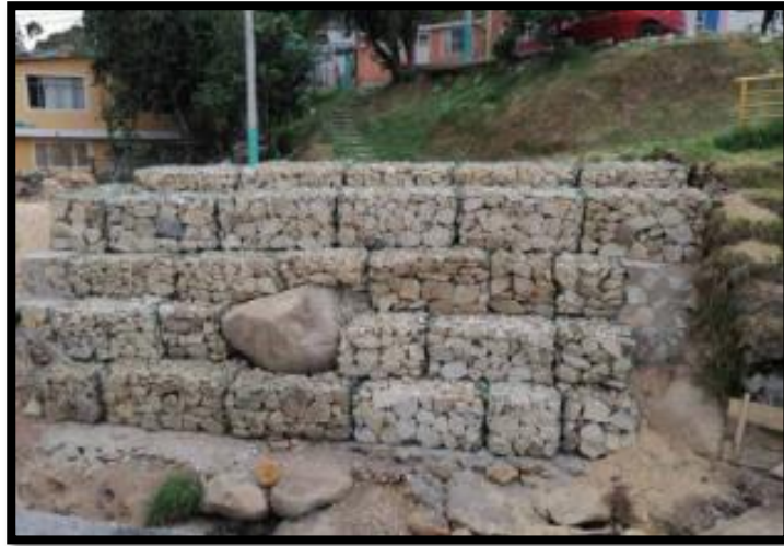
Figura 3: Fallas del muro de gaviones
