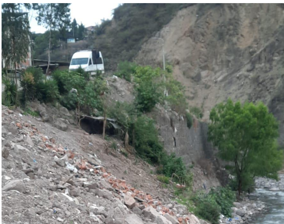
Figura 24: Empuje de talud a lo muros de gaviones Fuente: Evidencia de campo
