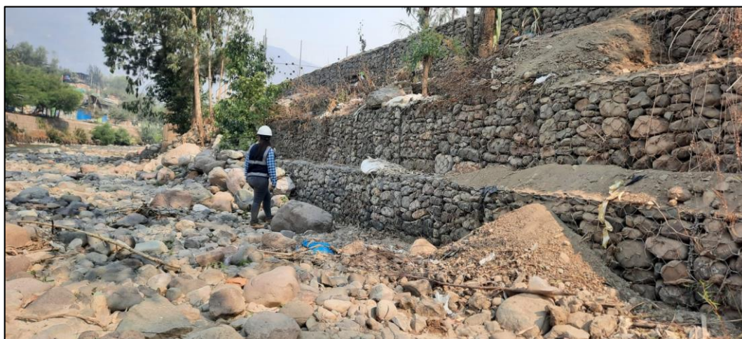
Figura 35: Se observa la presencia de maleza y residuos Fuente: Evidencia de campo
