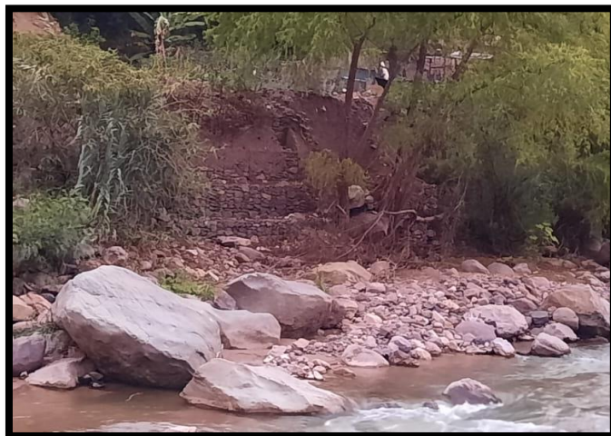
Figura 13: Vista desmonte y maleza en muros de gaviones
