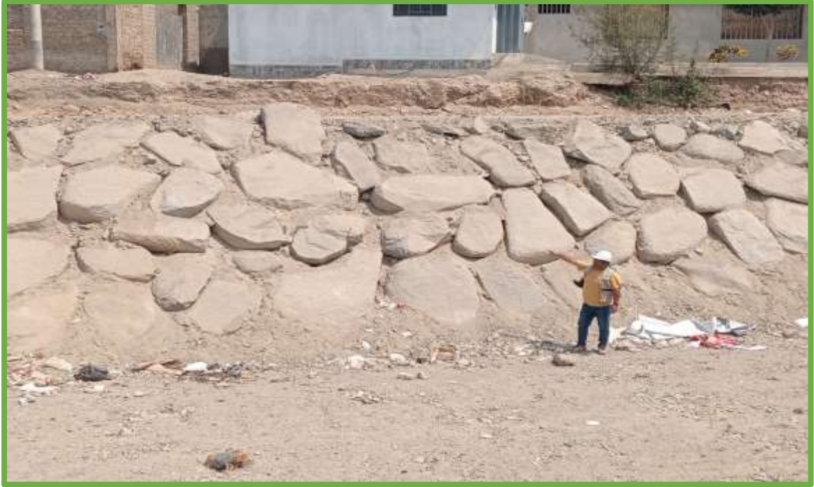
Figura 11. En la imagen se observa la toma fotográfica en la progresiva 0+120, donde se aprecia inestabilidad de enrocado.
