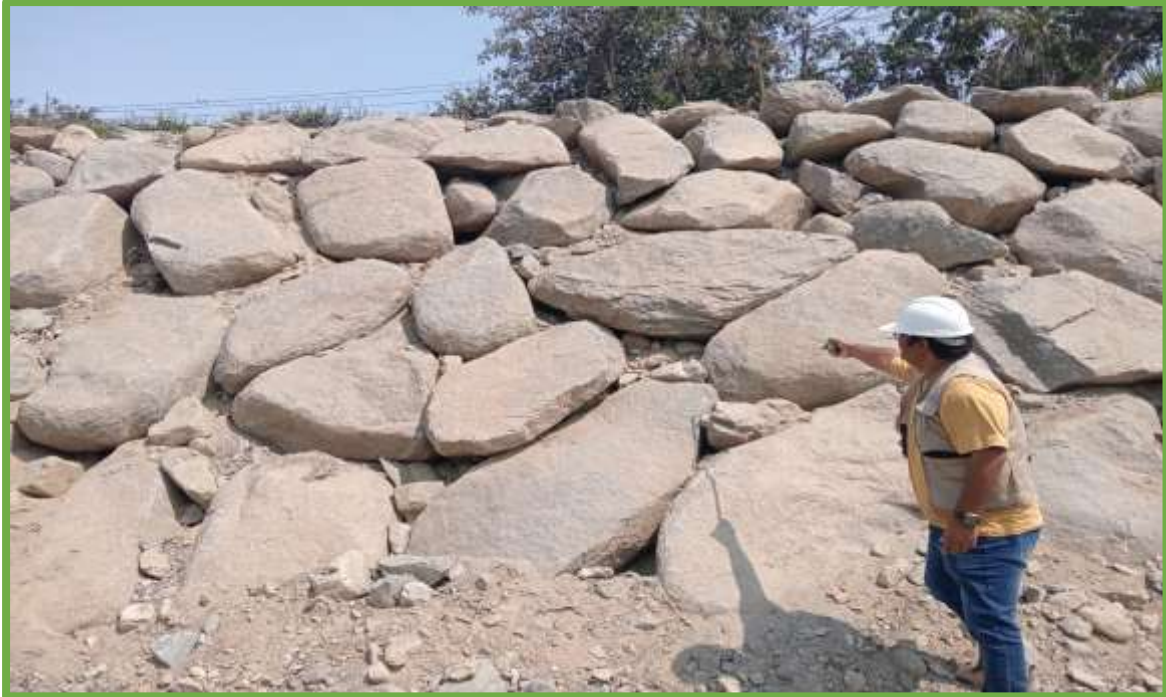
Figura 3. En la imagen se observa la toma fotográfica en la progresiva 0+030, encontrando inestabilidad en el enrocado y grandes espaciamientos en las juntas.
