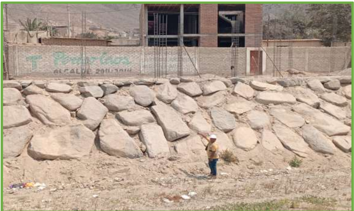
Figura 12. En la imagen se observa la toma fotográfica en la progresiva 0+140, donde presenta mala conexión de bloques de enrocado.
