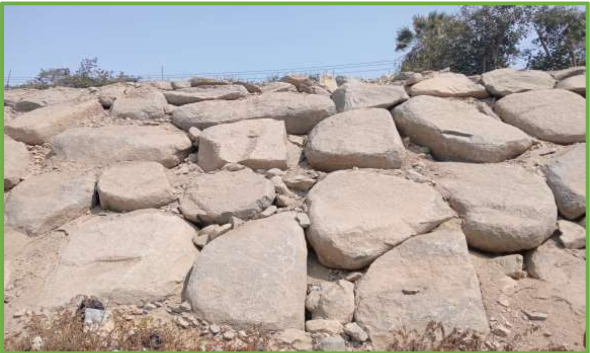
Figura 18. En la imagen se observa grandes espaciamientos entre las juntas, así como rocas inestables en la progresiva 0+0115.
