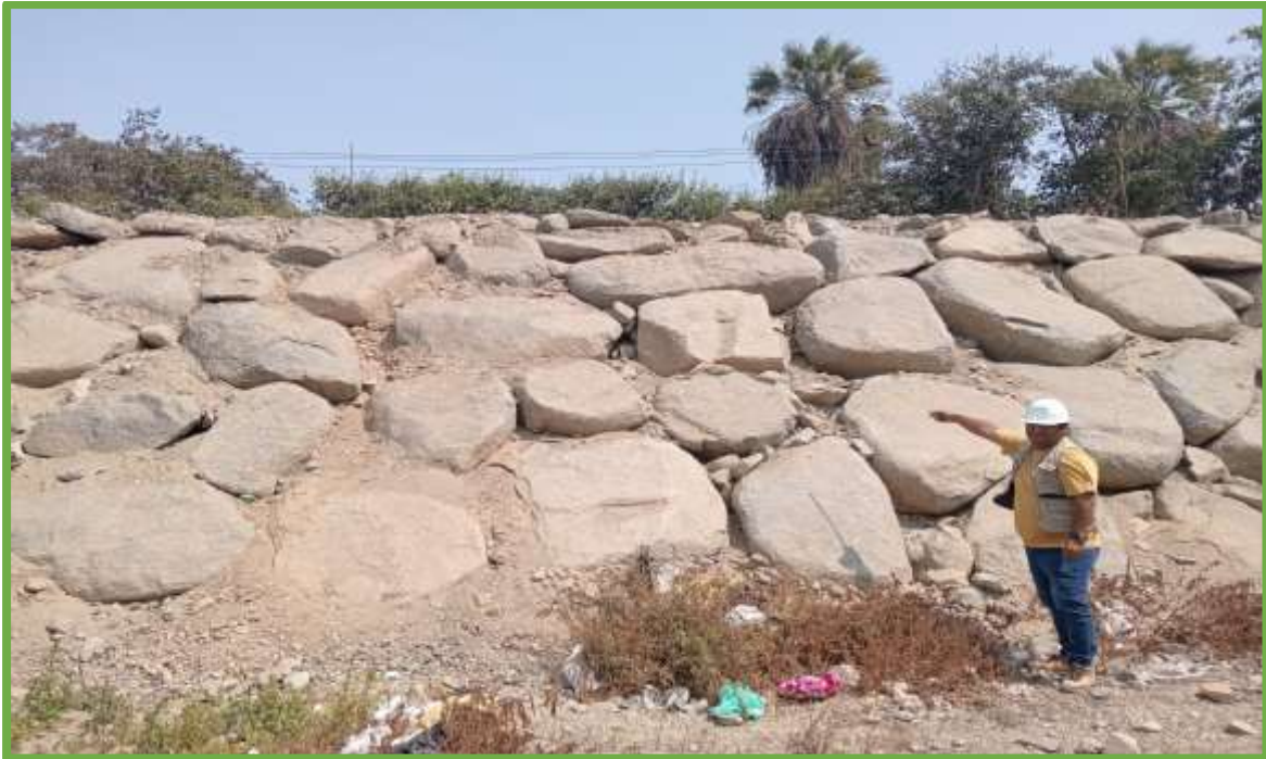
Figura 5. En la imagen se observa la toma fotográfica en la progresiva 0+070, encontrando inestabilidad en el enrocado y espaciamiento entre las juntas.
