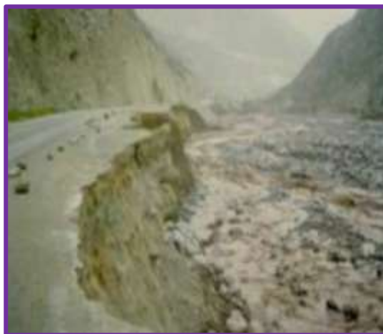
Figura 9: Socavación en la margen de un río.
