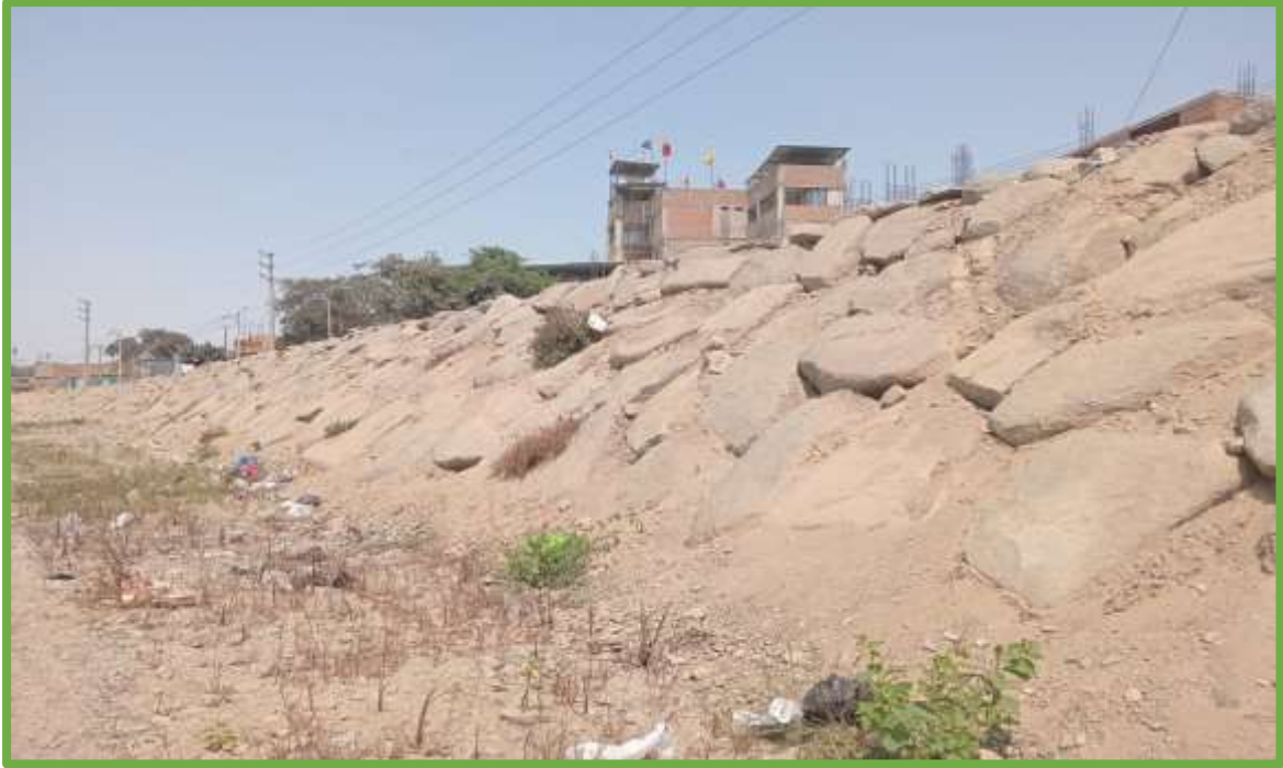
Figura 17. En la imagen se puede observar el deterioro de las juntas, de la misma manera inestabilidad en el enrocado en la progresiva 0+095.
