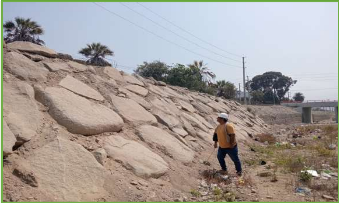
Figura 7. En la imagen se puede observar la toma fotográfica en la progresiva 0+090, encontrando presencia de vegetación en la base
