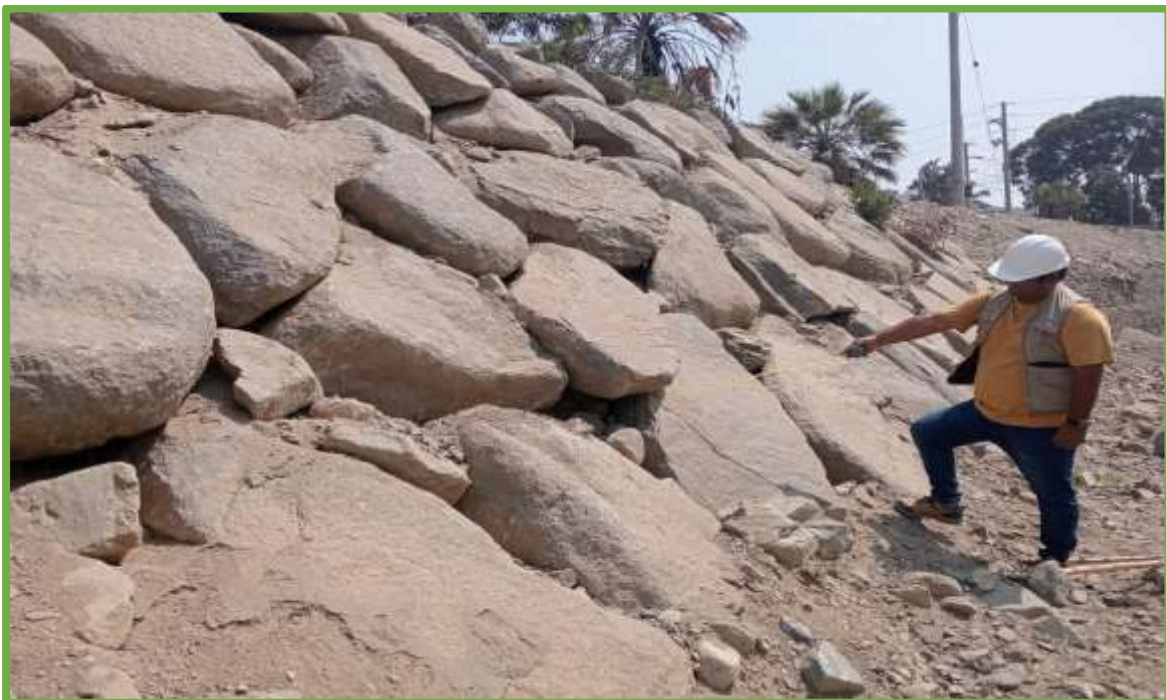
Figura 4. En la imagen se puede observar la toma fotográfica en la progresiva 0+050, encontrando inestabilidad en el enrocado.
