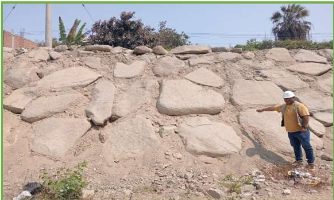
Figura 6. En la imagen se observa la toma fotográfica en la progresiva 0+080, encontrando talud erosionado.
