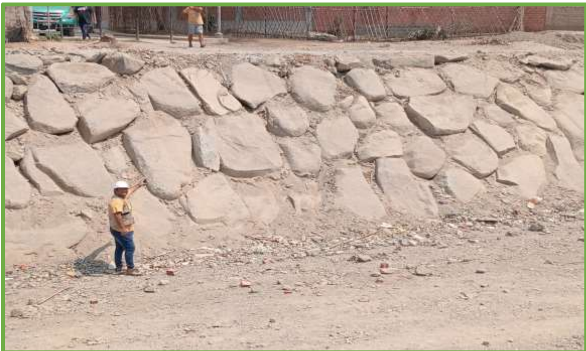
Figura 10. En la imagen se observa la toma fotográfica en la progresiva 0+0110, donde se apreció deterioró de juntas
