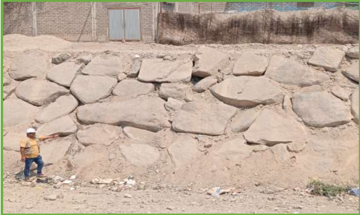
Figura 9. En la imagen se puede observar la toma fotográfica en la progresiva 0+100, donde se apreció rocas desgastadas
