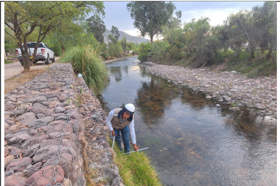
Foto N°6: se observa exceso de vegetación alrededor de la estructura
