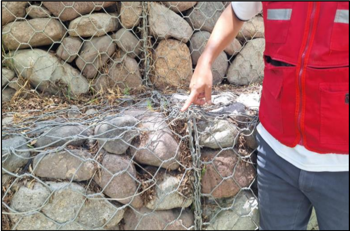
Figura 37: Estado actual de mallas del muro de gaviones
