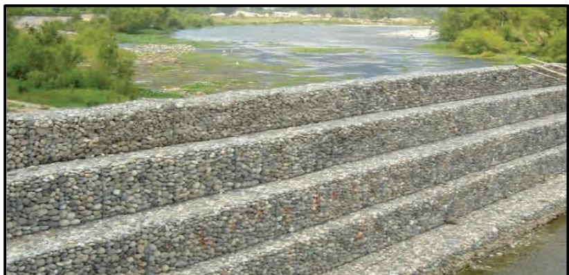
Figura 12: Muro de gaviones
