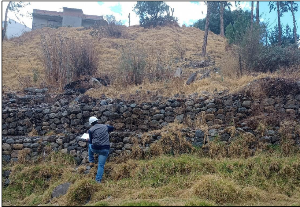
Aparentemente la presencia del pasto crecido hace que los muros tiendan a falla y deformarse, progresiva 0+515
