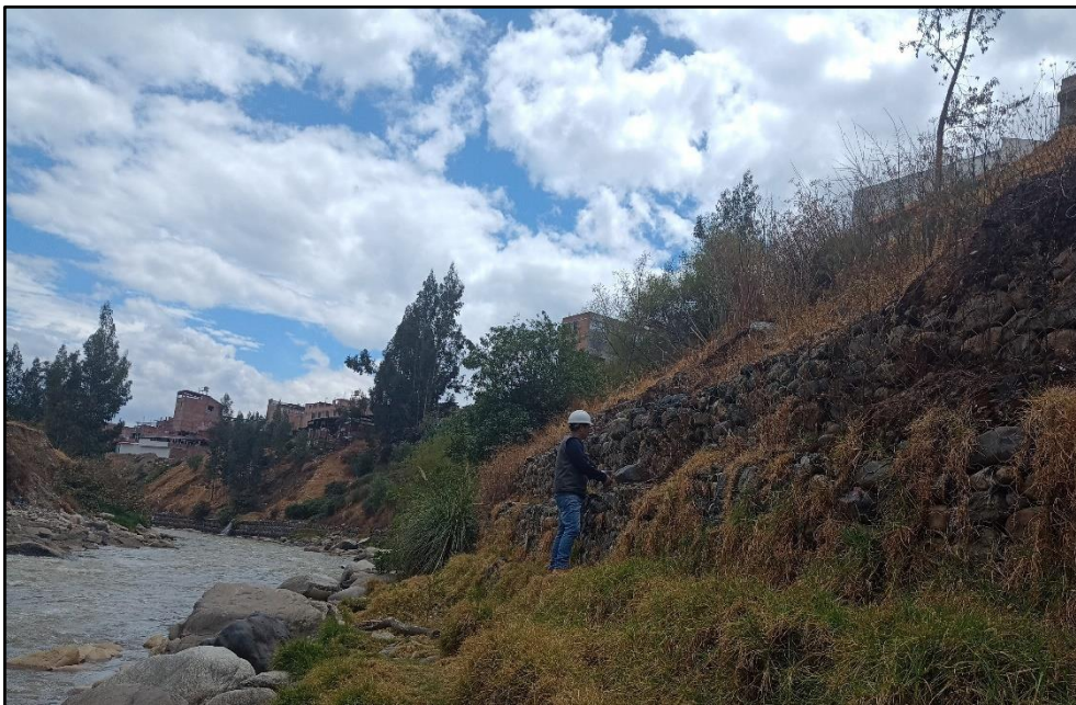
Aparentemente la presencia del pasto crecido hace que los muros tiendan a falla y deformarse, progresiva 0+550
