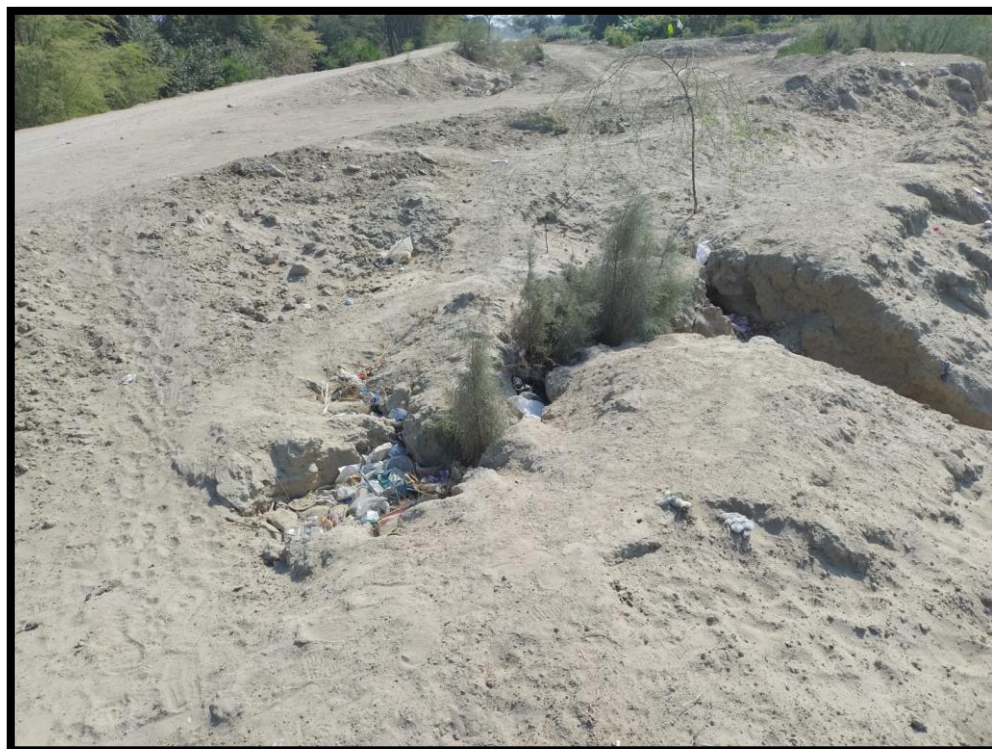
Figura 22: Visualización de grieta en el dique con presencia de basura
