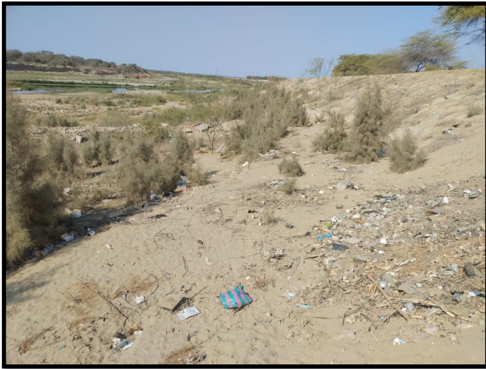
Figura 23: Se visualiza vegetación y residuos sólidos en la ladera de la defensa ribereña
