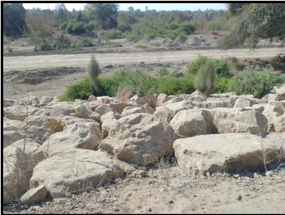
Figura 26: Rocas mal colocadas y sueltas en la ladera del dique
