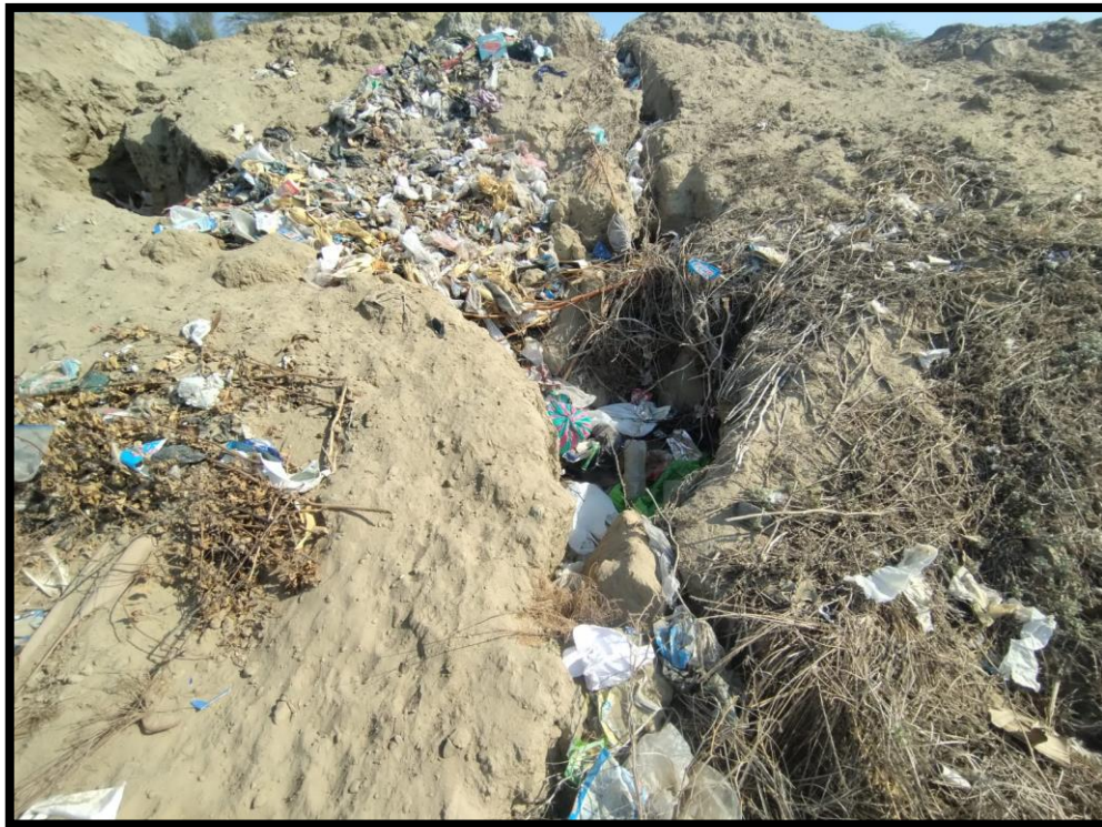
Figura 21: Falta de limpieza y mantenimiento del dique
