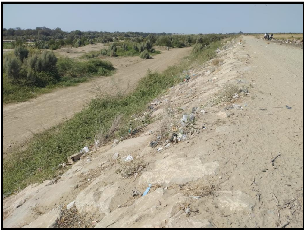
Figura 14: Vista del dique con presencia de vegetación en toda la zona
