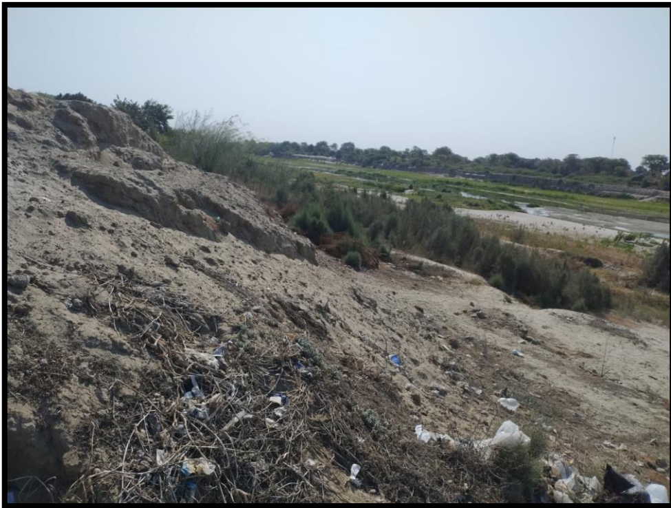
Figura 25: Presencia de residuos sólidos y vegetación cerca al dique
