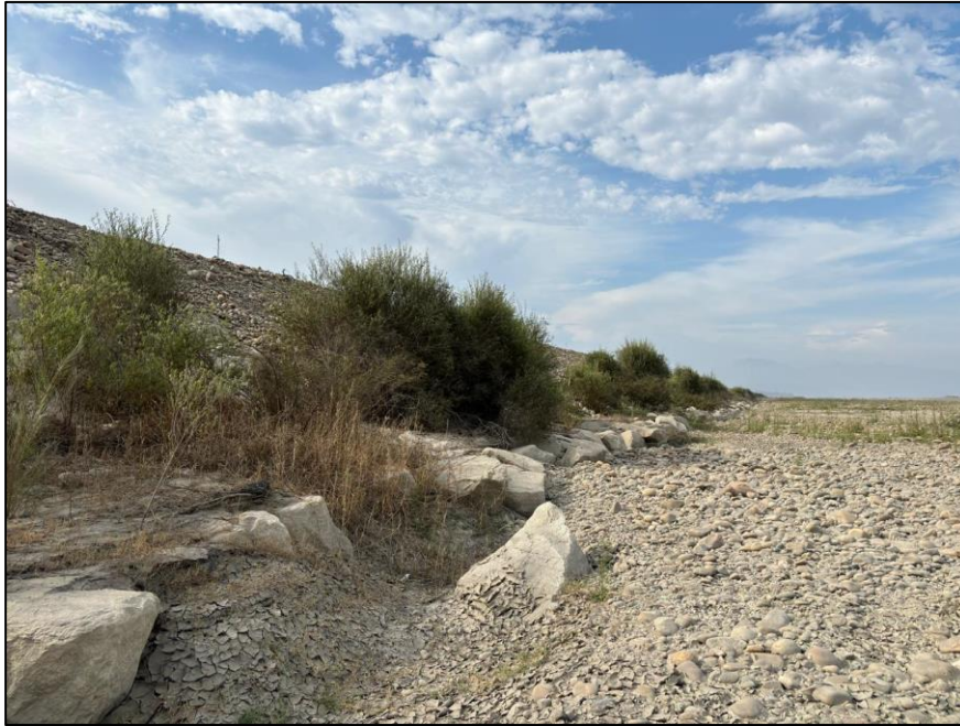
Figura 11: Discontinuidad del enrocado
