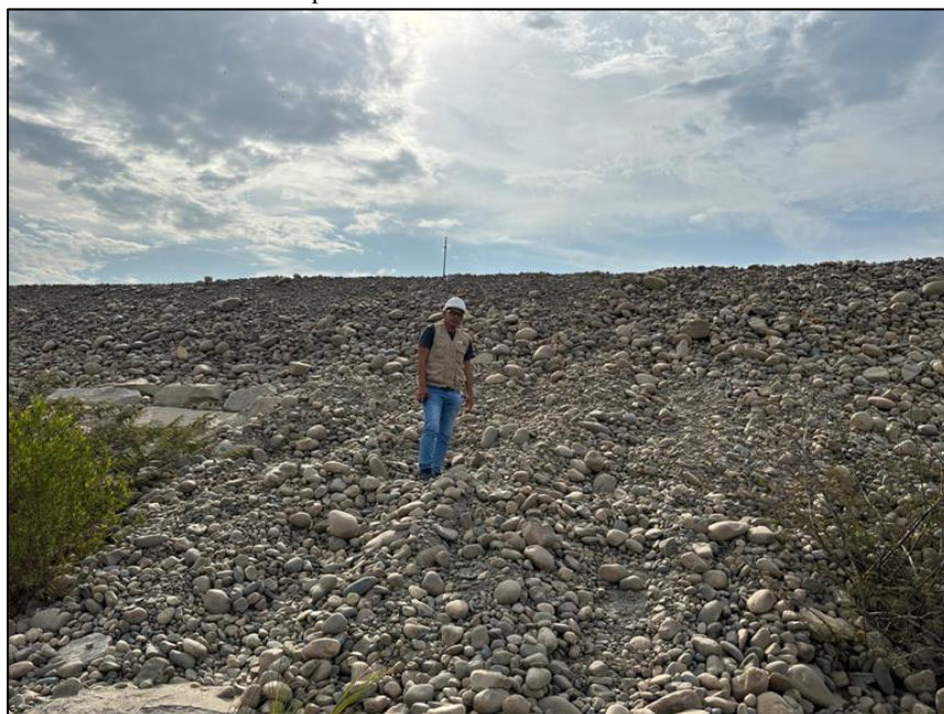
Figura 8: Se visualiza la falta de enrocado en la margen derecha del río Chicama
