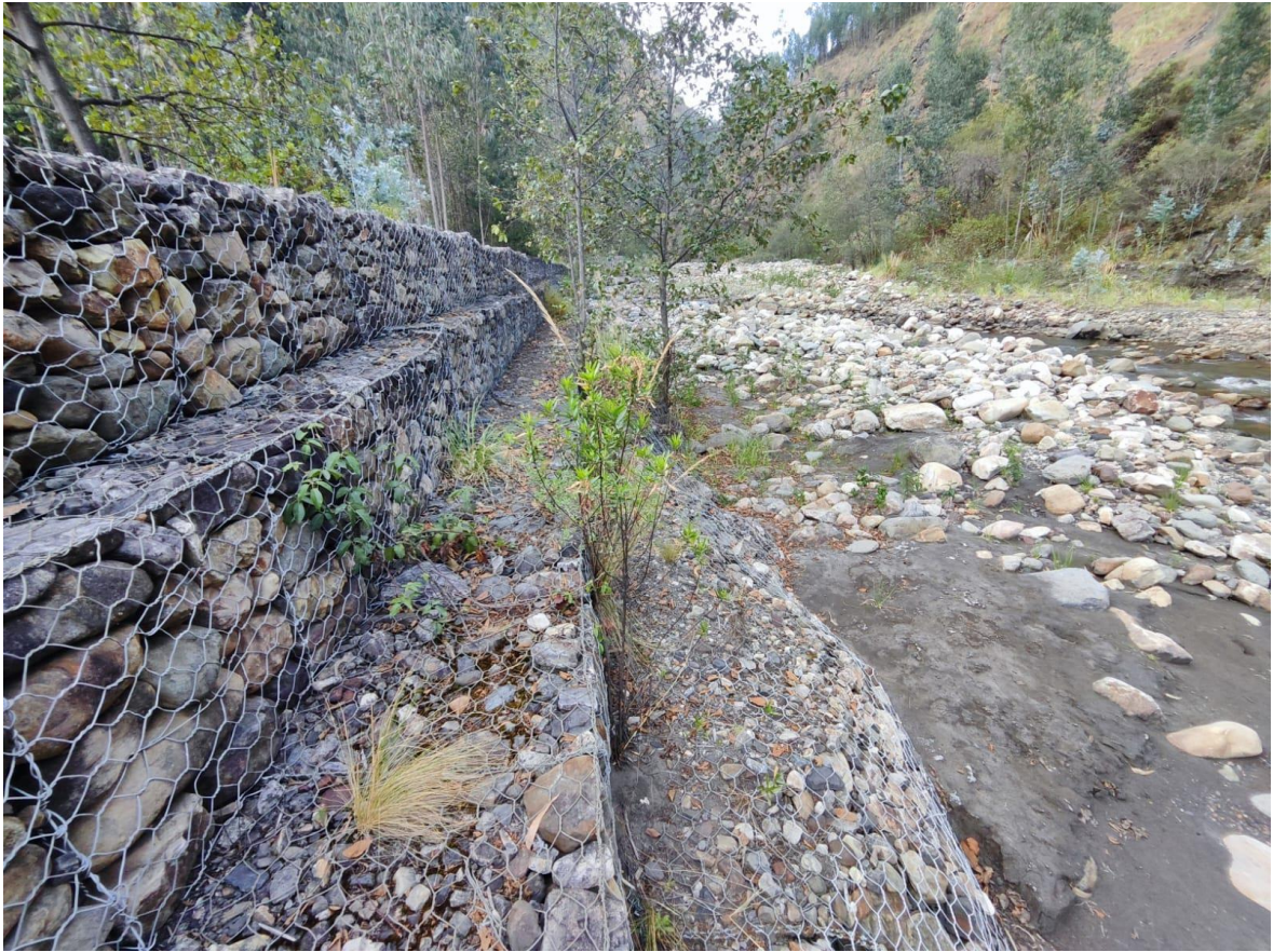
Fotografía 4. Vista del estado situacional del Muro de Gavión de la defensa ribereña del río Grande del caserío de Manta Baja, distrito Ragash, provincia de Sihuas.
