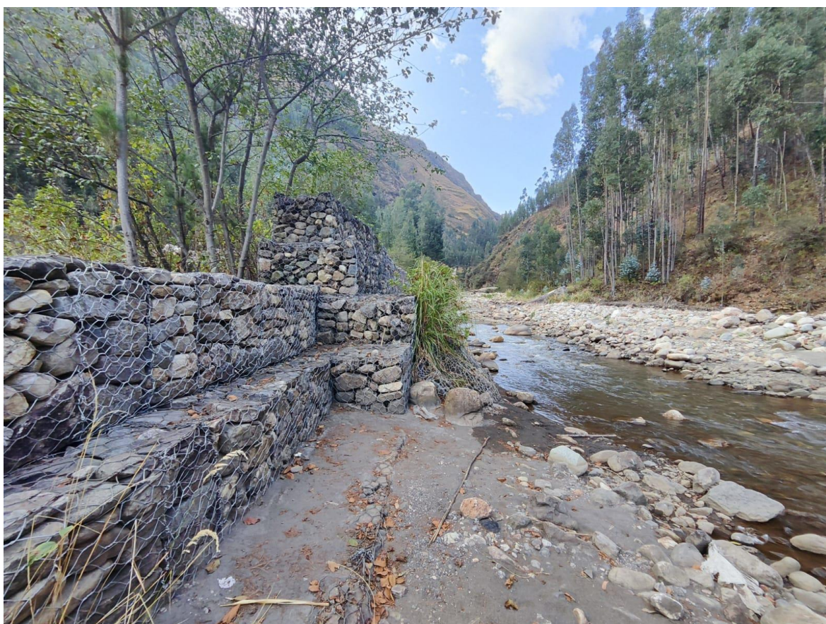
Fotografía 1. Muro de Gavión de la defensa ribereña del rio Grande del caserío de Manta Baja, distrito Ragash, provincia de Sihuas
