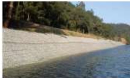
Figura 2. Gaviones para contención fluvial. Fuente: (A. Bianchini, 2017).
