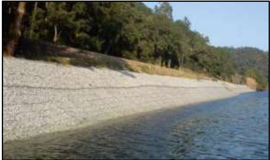
Figuras 2: Gaviones para contención pluvial
