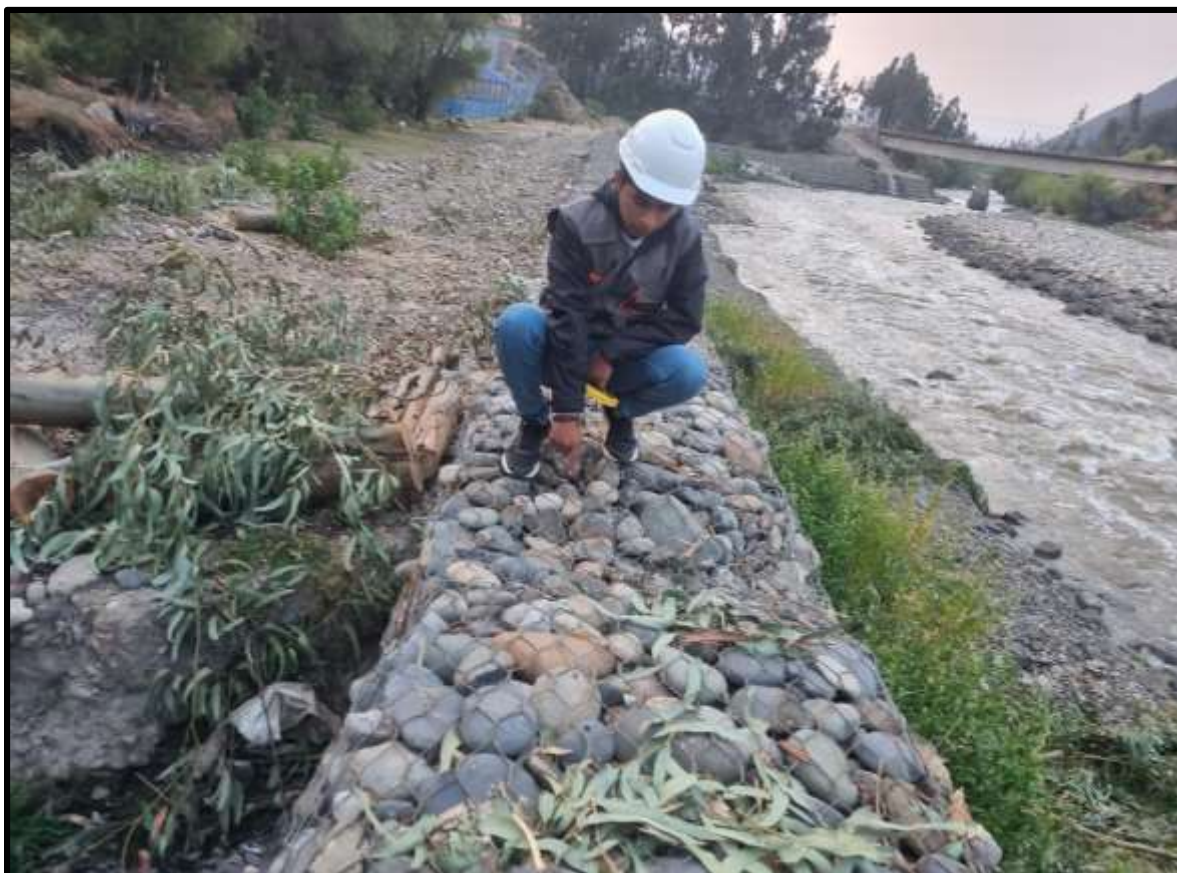
Figuras 15: Fallas de asentamiento Fuente: Elaboración propia
