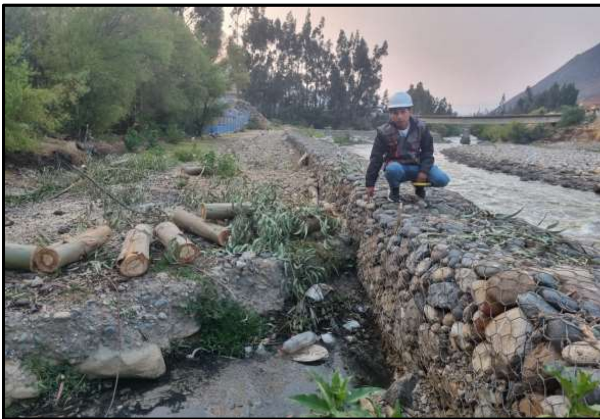
Figuras 16: Vista de uno de los factores de socavación o empuje Fuente: Elaboración propia
