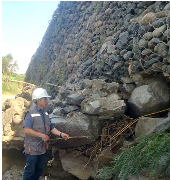
Figura 18. Prog. 0+ 300 se aprecia la presencia de rocas en la base del muro, también se aprecia el hundimiento del tercer nivel del muro de gavión.
