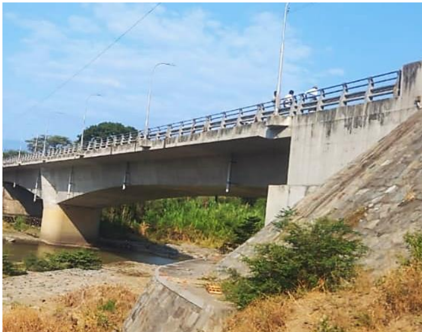
Figura 14. Prog. 0 + 000 se aprecia la ubicación del muro gavión el cual está ubicado en el río Calvas puente Internacional Macará.
