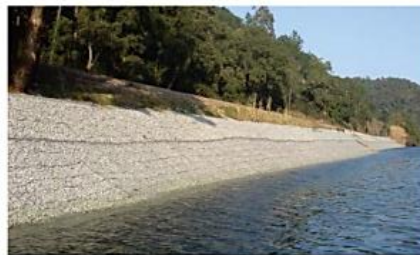
Figura 2. Gaviones para contención fluvial. Fuente:(A Bianchini, 2017).
