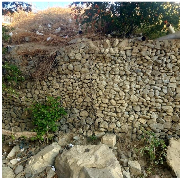
Figura 16. Prog. 0+150 se aprecia el desprendimiento de la malla y a la misma vez el desplazamiento y vegetación en la base del muro gavión.
