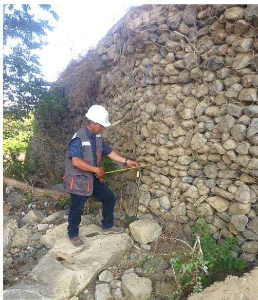
Figura 22. Prog .0 + 900 identificando el déficit de inclinación del muro gavión también se aprecia la vegetación y rocas en la base del gavión
