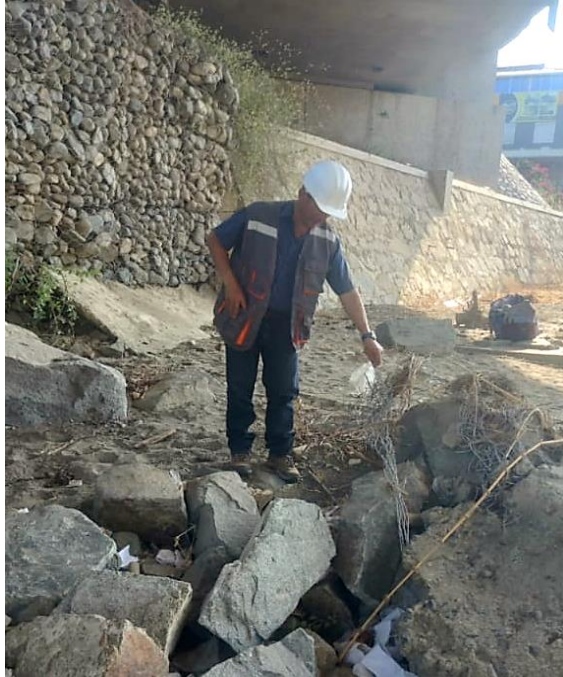
Figura 15. Prog. 0+100 se aprecia el déficit que presenta en la base del muro gavión.
