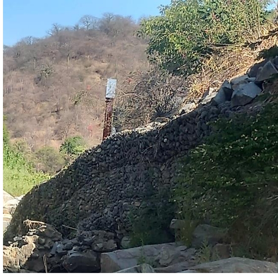
Figura 17, Prog. 0+200 se aprecia el volteo del muro de gavión.
