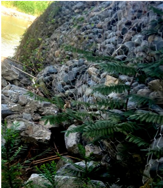
Figura 20. Prog. 0 + 550 Se aprecia el hundimiento y vegetación en el segundo nivel del muro de gavión.
