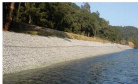
Figura 2. Gaviones para contención fluvial. Fuente: (A Bianchini, 2017).
