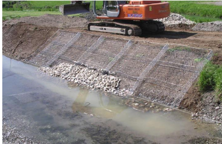
Figura 5. Muro de gaviones tipo colchón
