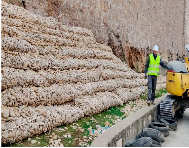
Figura 3. Muro de gaviones tipo saco
