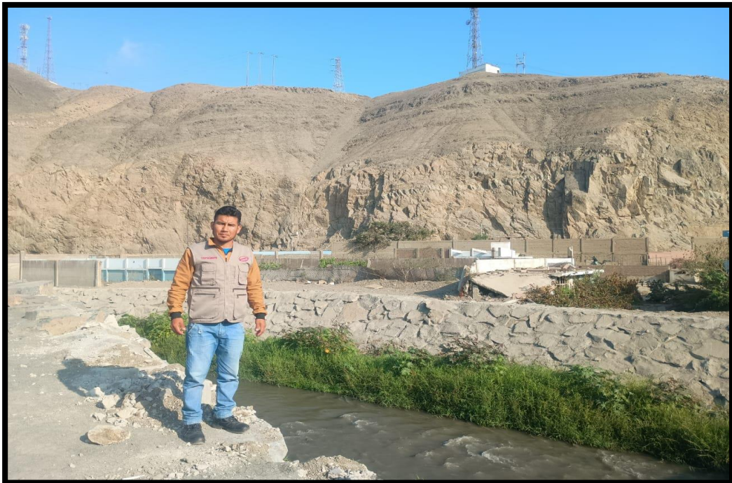
Figura 15: Enrocado con presencia de maleza
