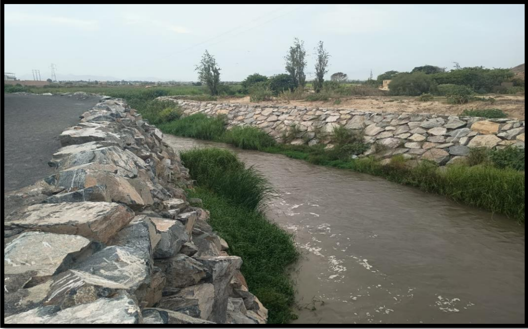
Figura 16: Estado del enrocado del río
