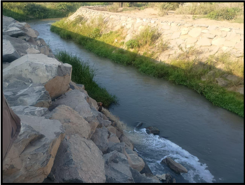
Figura 24: Socavación del enrocado y desprendimientos de rocas
