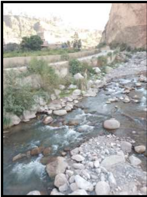
Figura 32: Vegetación en loma de muro de contención. Fuente: Evidencia de campo
