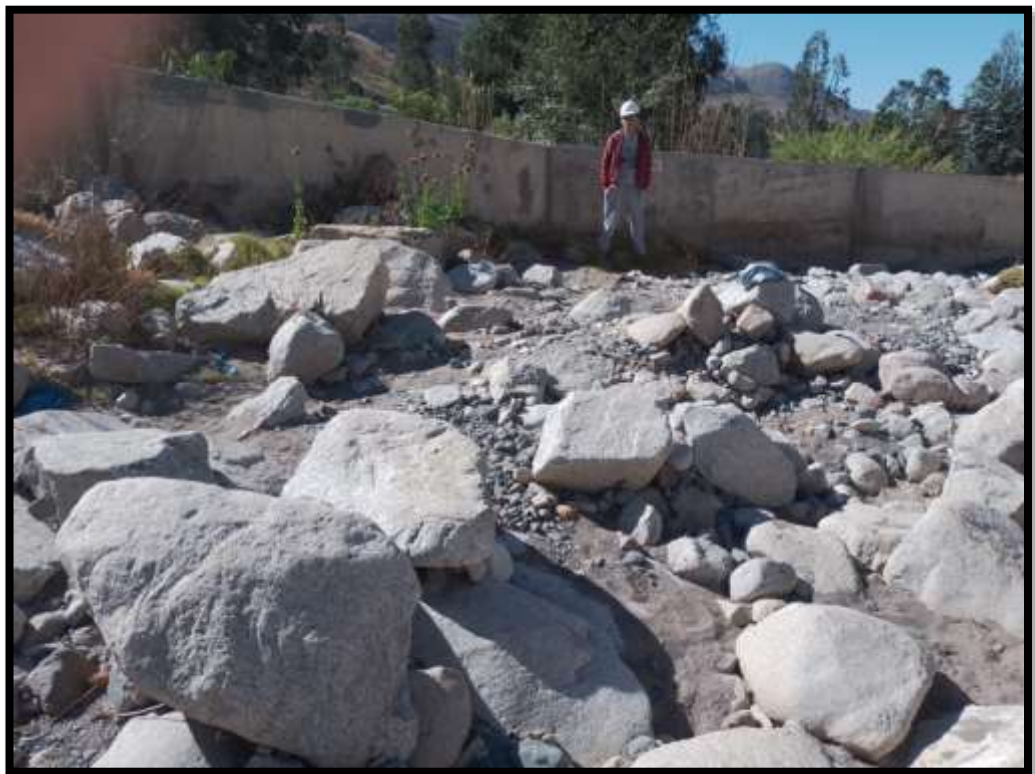
Figura 27: Altura de Muro sin descolmatar margen izquierdo progresiva 0+050. Fuente: Evidencia de campo
