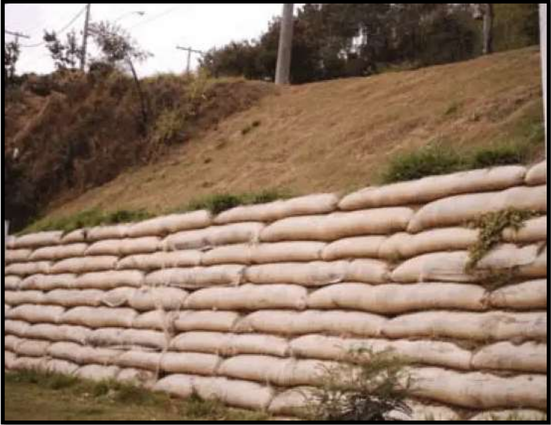
Figura 7: Muro de contención de saco y suelo. Fuente: Extraído de canal de diseño Hidráulico.
