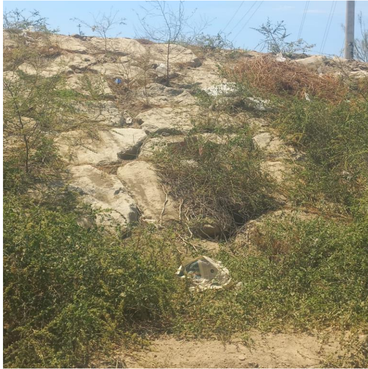
Figura N° 03: Se aprecia escombros de basura en el enrocado
