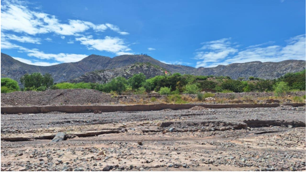
Figura 35. Ubicación de los gaviones con respecto al río Chillico. Fuente: Elaboración propia 2024
