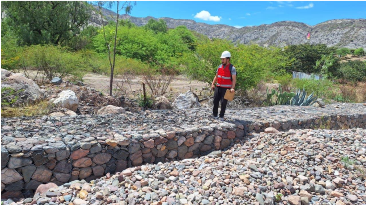
Figura 40. Evaluación del estado de la estructura del sistema de gaviones. Fuente: Elaboración propia 2024
