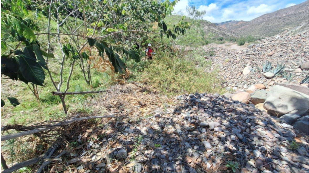
Figura 43. Evaluando si el material suelto de la zona afecta a la estructura de gaviones ya que lo cubre por completo.
