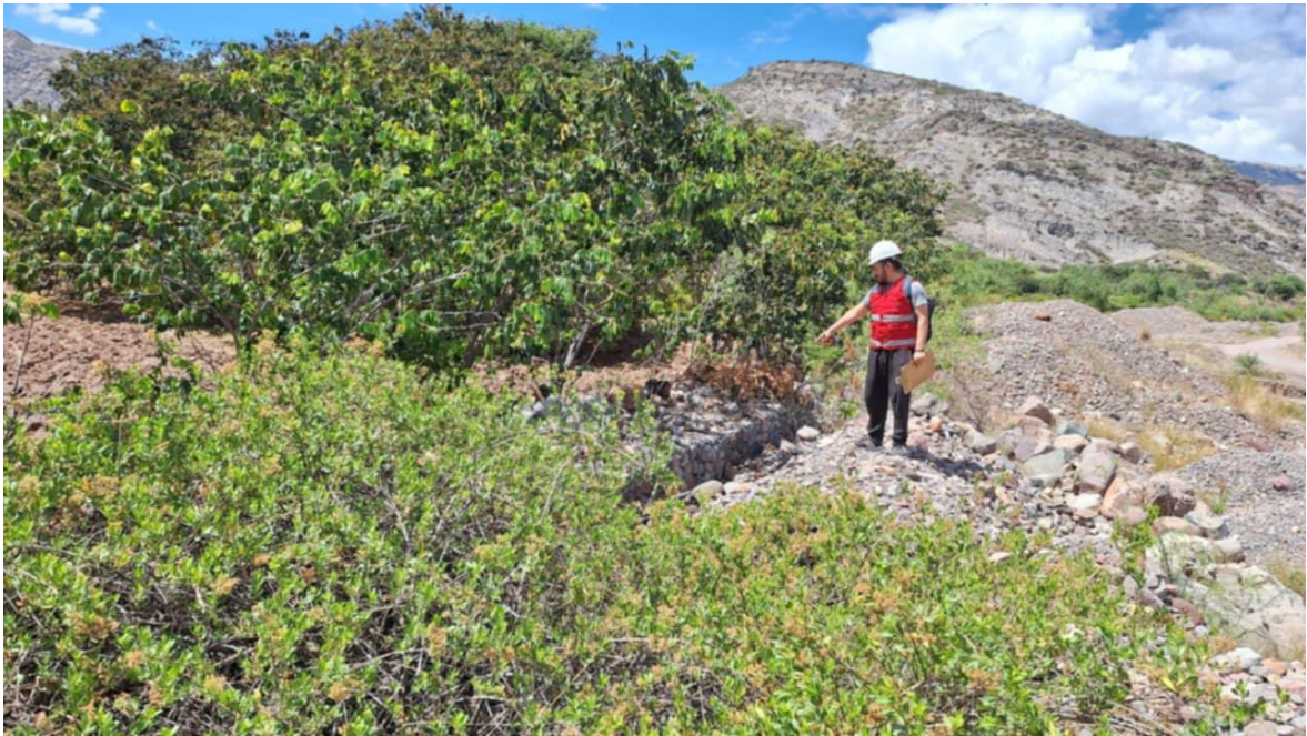
Figura 48. Determinación del estado actual de los gaviones que presenta asentamiento a causa del agregado que tiene sobre su estructura. Fuente: Elaboración propia 2024
