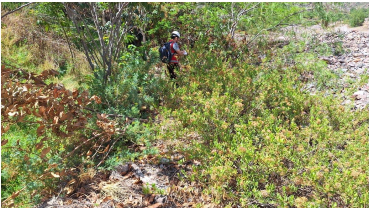
Figura 44. Evaluación del punto inicial del sistema de gaviones y su estado actual.
