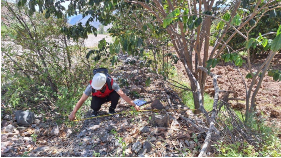
Figura 47. evaluación de la parte superior de los gaviones. Fuente: Elaboración propia 2024
