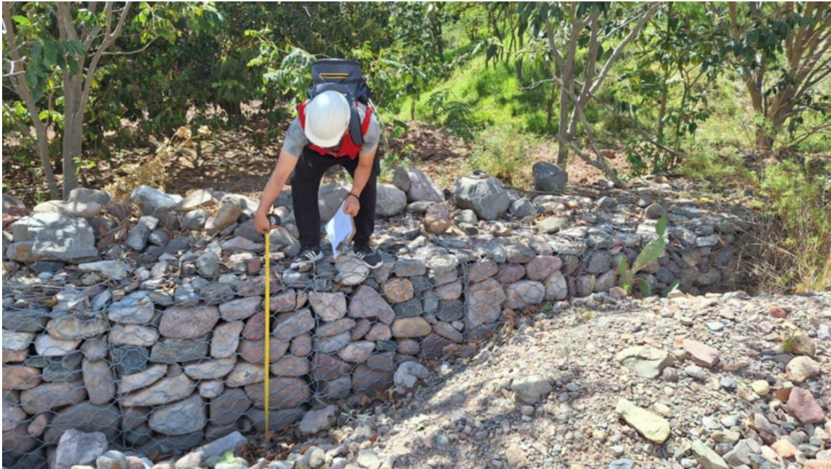
Figura 45. Determinando las dimensiones de las cajas de los gaviones y su relleno. Fuente: Elaboración propia 2024
