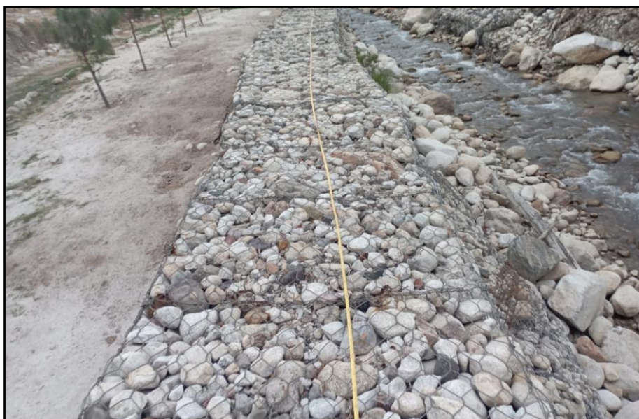
Figura 7: Tomando medidas de la longitud de la defensa ribereña.
