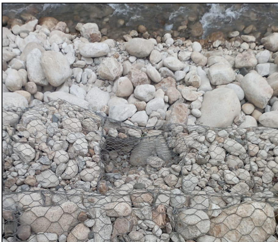
Figura 11: Malla del colchón antisocavante con deformación y pérdida de relleno.
