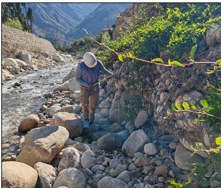
Figura 10: Socavación de 80 cm.
