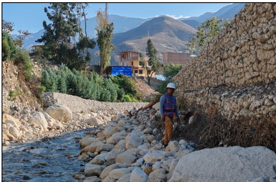
Fuente 2: Colchón antisocavante desplomado.
