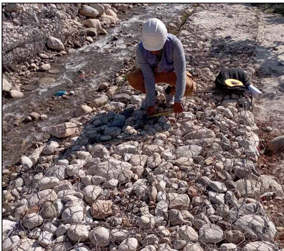
Figura 8: Piedra de relleno menor al dimensionamiento de la malla.
