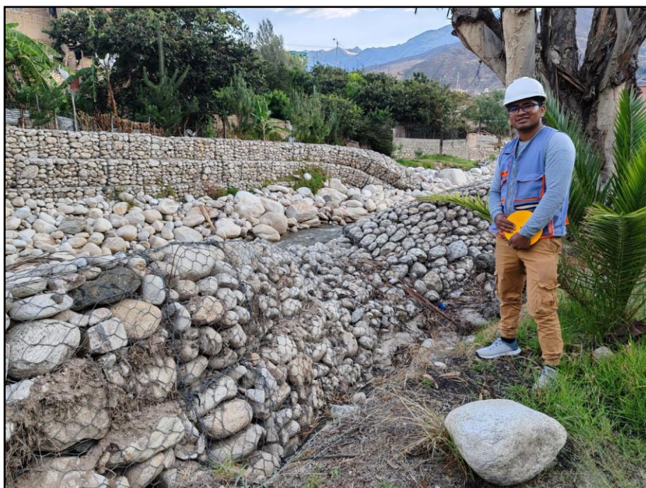
Figura 12: Asentamiento del muro de gavión.
