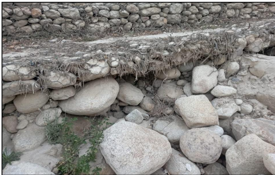
Figura 9: Socavación de 50 cm.
