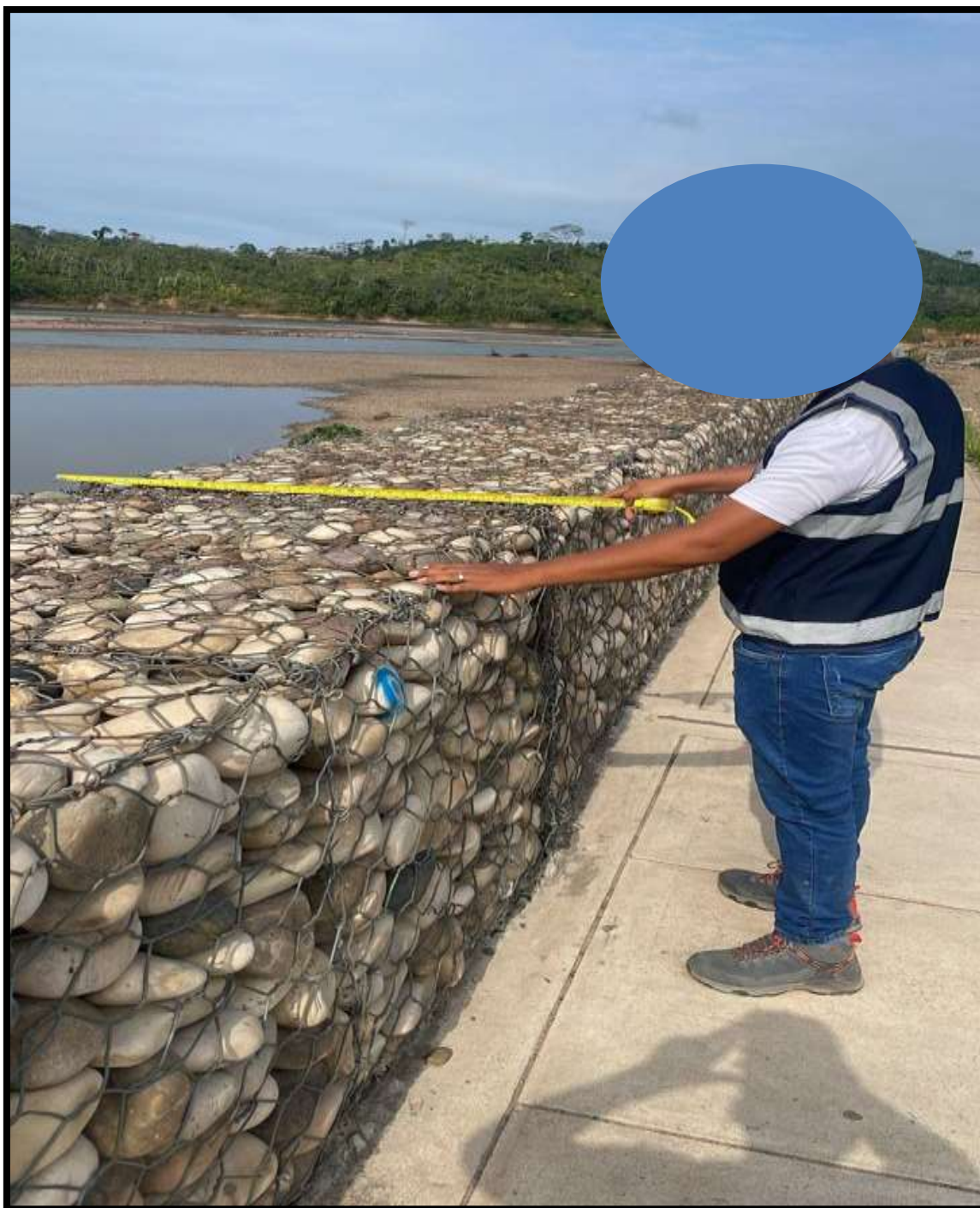
Figura 25: Medición del gavión
