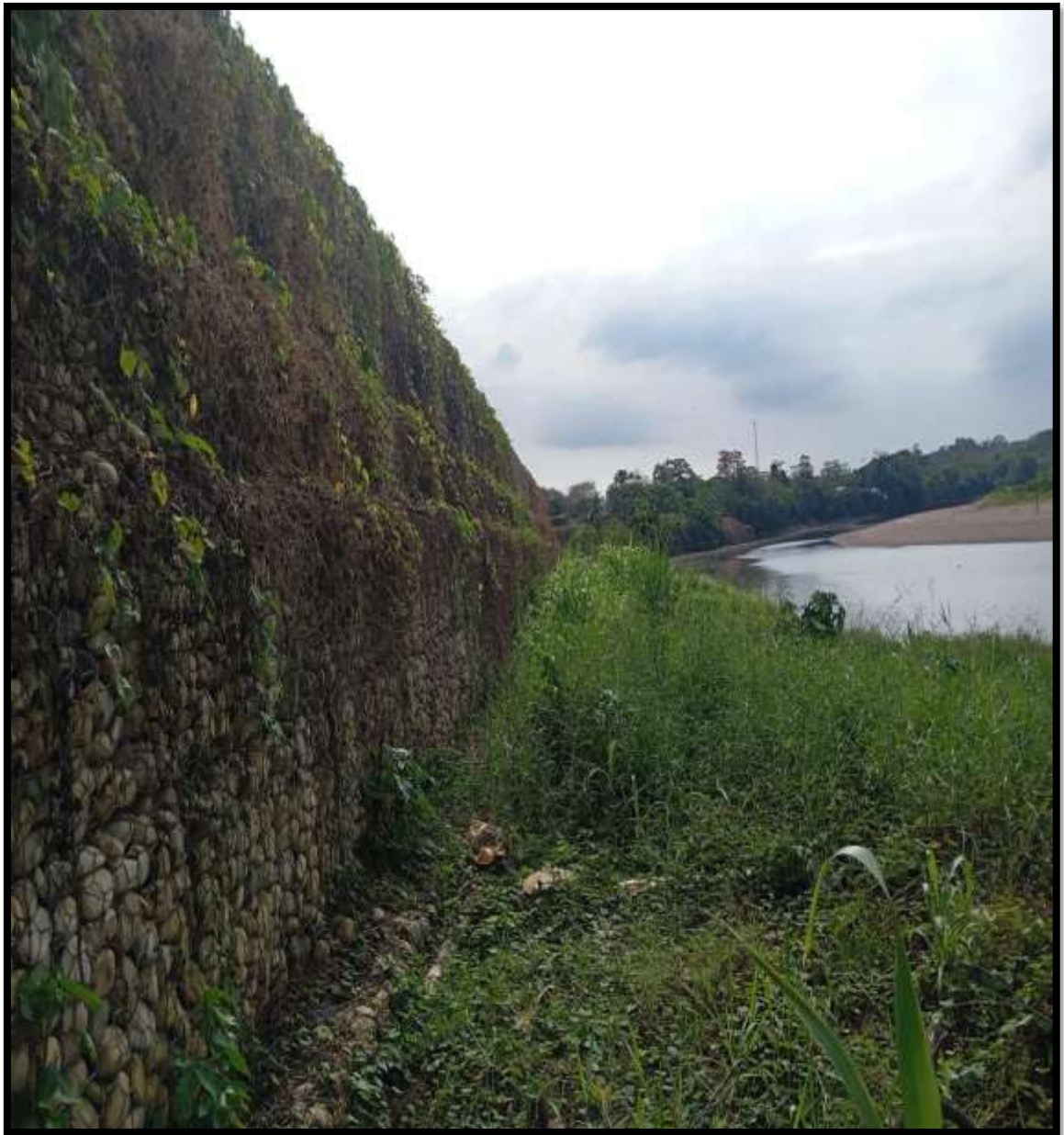
Figura 27: Muro de gaviones lleno de vegetación
