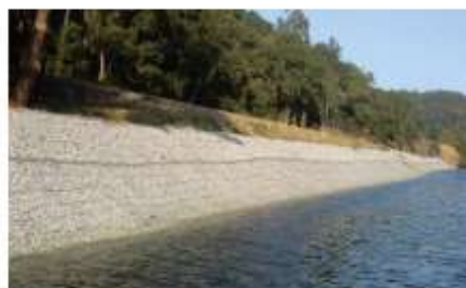
Figura 2. Gaviones para contención fluvial. Fuente: (A Bianchini, 2017).
