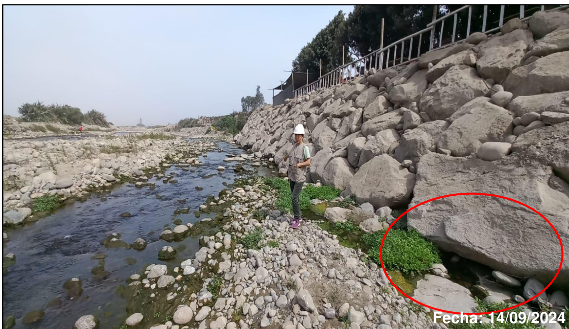
Foto 2: Socavación en el relleno del enrocado, margen derecha del río Chillón, aguas abajo del puente Trapiche
