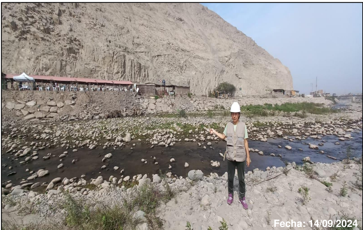
Foto 16: Deslizamientos, erosión y socavación de la uña del enrocado, margen izquierda del río Chillón, aguas arriba del puente Trapiche
