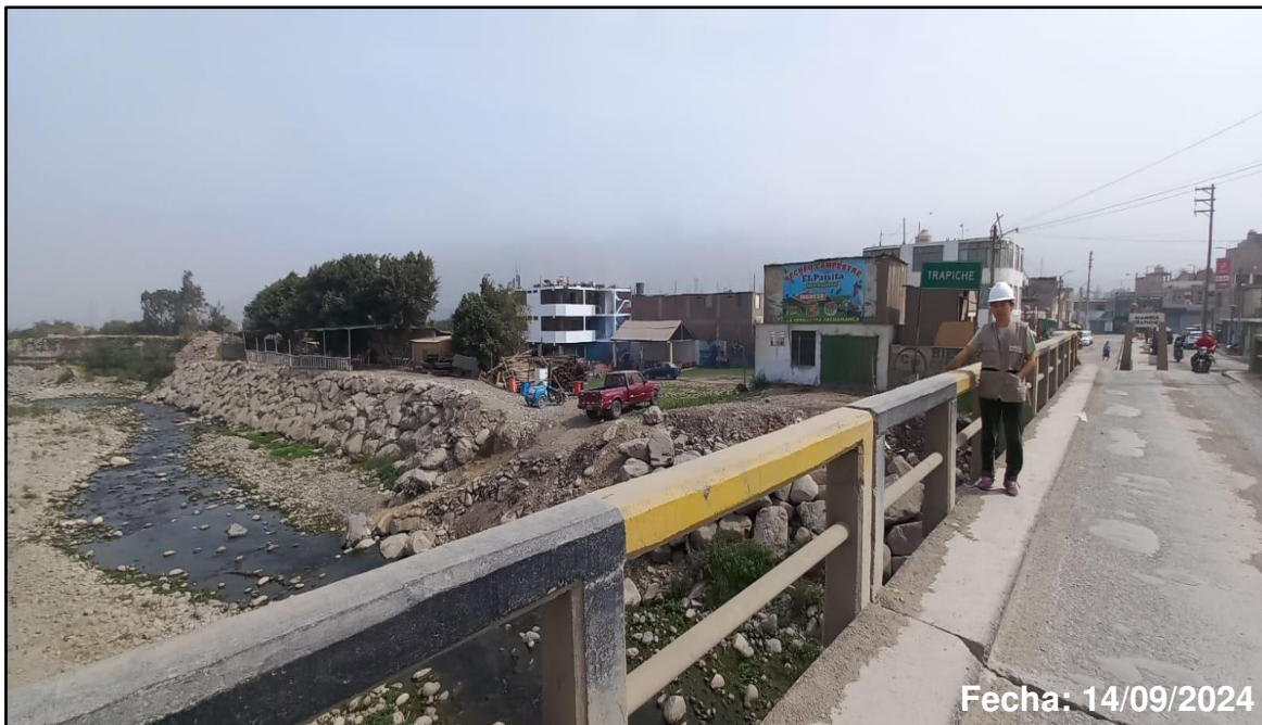
Foto 1: Enrocado del puente Trapiche, distrito de Santa Rosa de Quives, provincia de Canta, departamento de Lima - 2024
