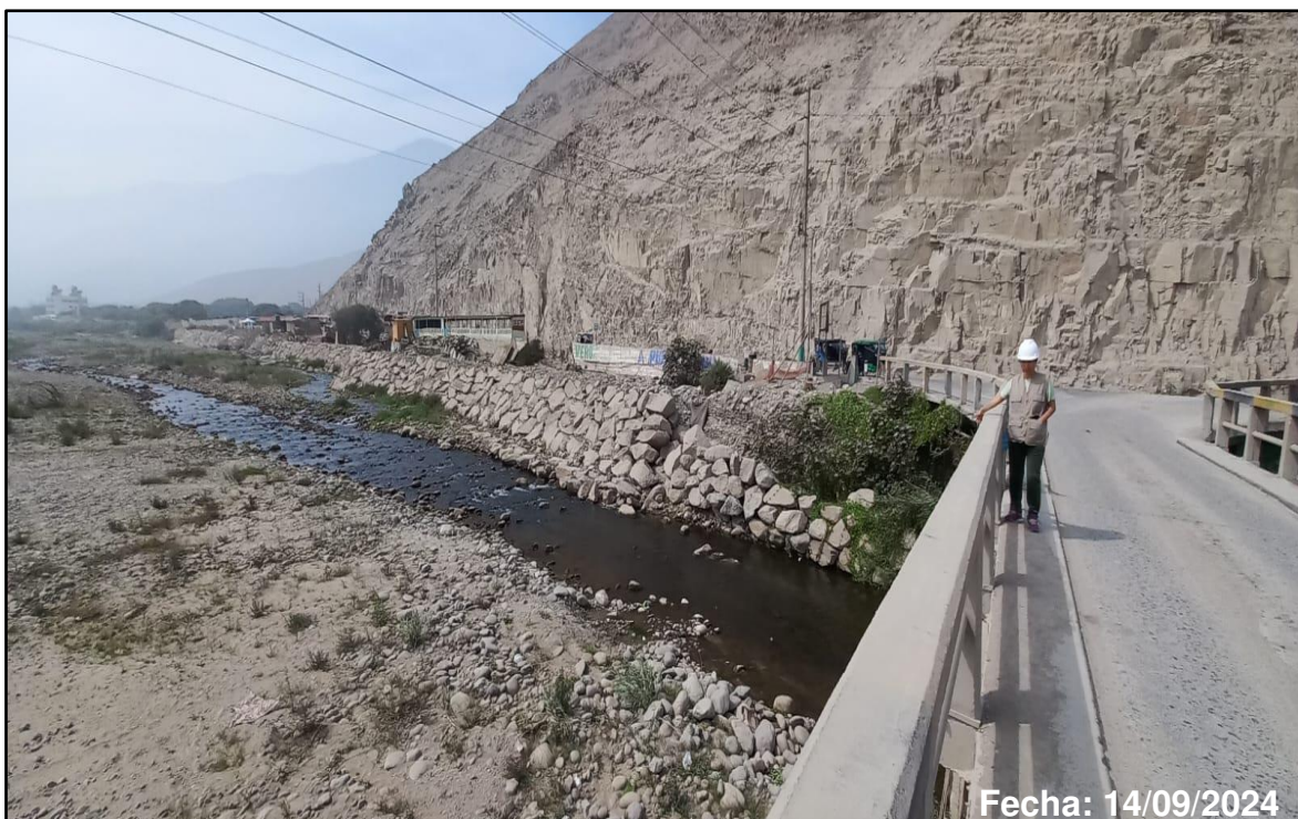
Foto 14: Se observa erosión y socavación de la ña, deslizamientos y falta de relleno en la parte superior del enrocado, margen izquierda del río Chillón, aguas arriba del puente Trapiche
