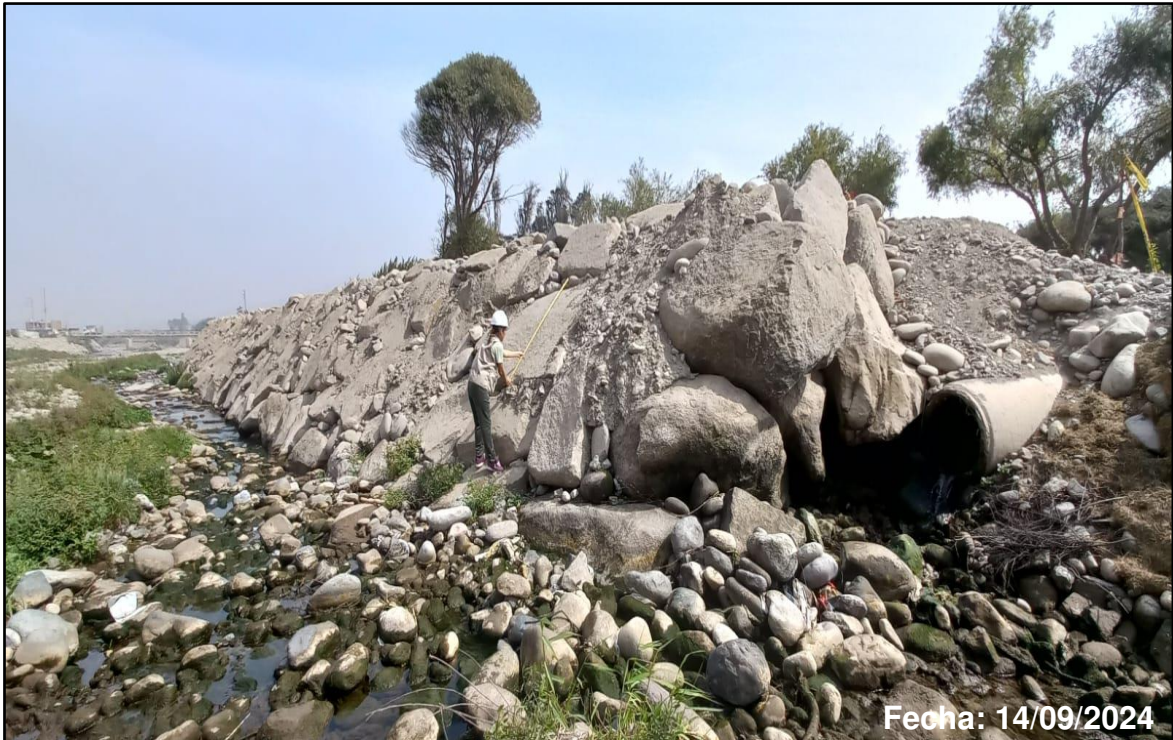
Foto 7: Medición del relleno del enrocado, margen derecha del río Chillón, aguas arriba del puente Trapiche
