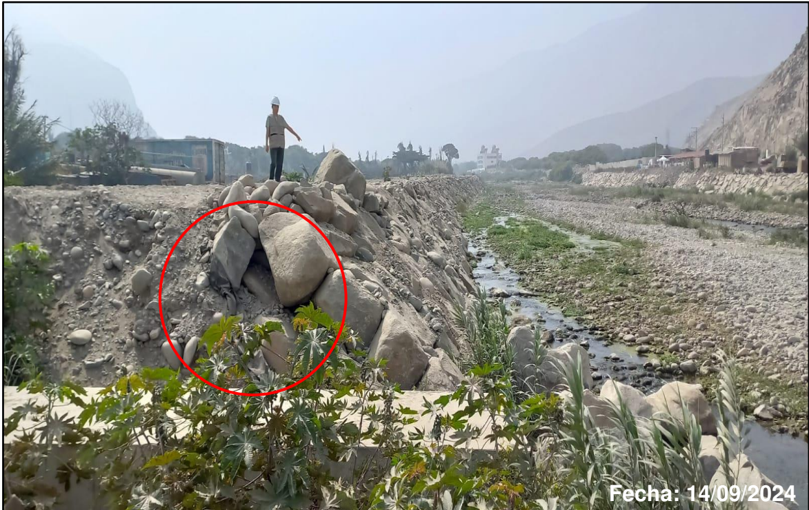
Foto 5: Exposición del geotextil, margen derecha del río Chillón, aguas arriba del puente Trapiche
