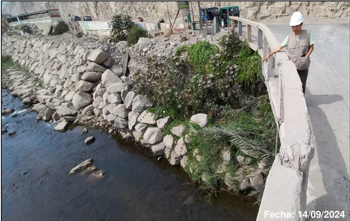
Foto 15: Vista de la erosión y socavación de la uña del enrocado, margen izquierda del río Chillón, aguas arriba del puente Trapiche
