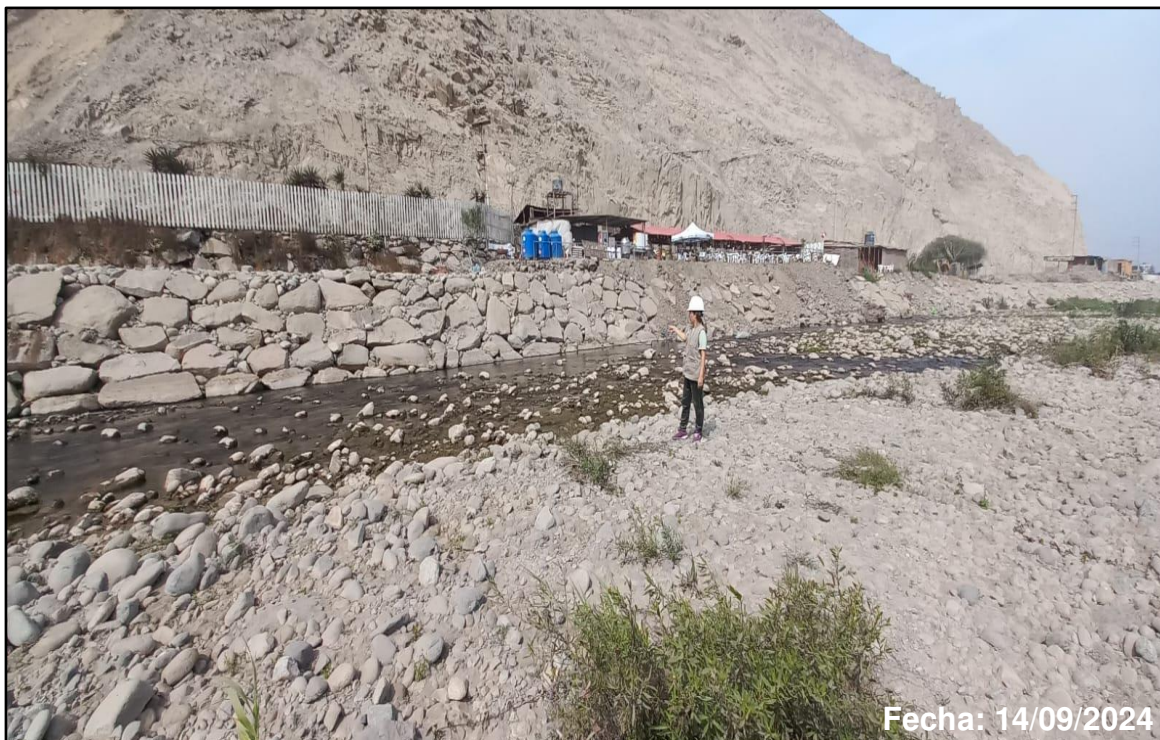
Foto 17: Erosión y socavación de la uña. En la última sección, donde la uña debería conectarse con el resto de la estructura, se aprecia únicamente material del enrocado levantado, sin que sea posible visualizar la uña
