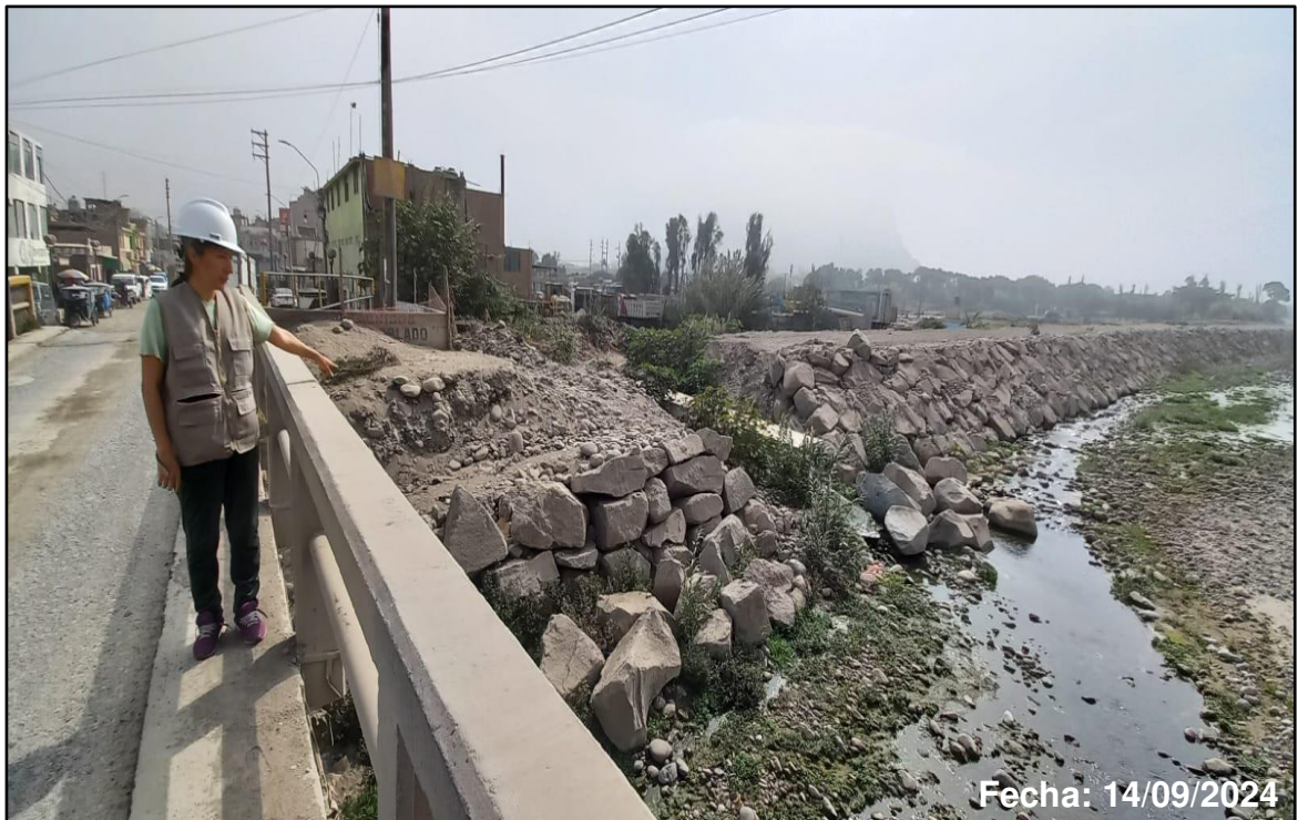
Foto 10: Deslizamiento del relleno de enrocado, margen derecha del río Chillón, aguas arriba del puente Trapiche
