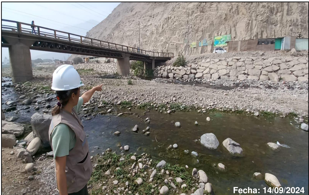
Foto 12: Se visualiza falta de relleno en la parte superior del enrocado y socavación en su base, margen izquierda del río Chillón, aguas abajo del puente Trapiche
