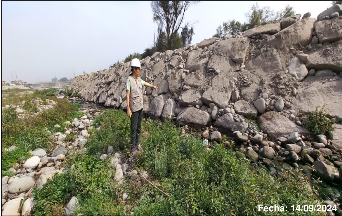
Foto 9: Se observa que la uña ha sufrido un proceso de erosión significativo. En la última sección, donde la uña debería conectarse con el resto de la estructura, se aprecia únicamente material del enrocado levantado, sin que sea posible visualizar la uña
