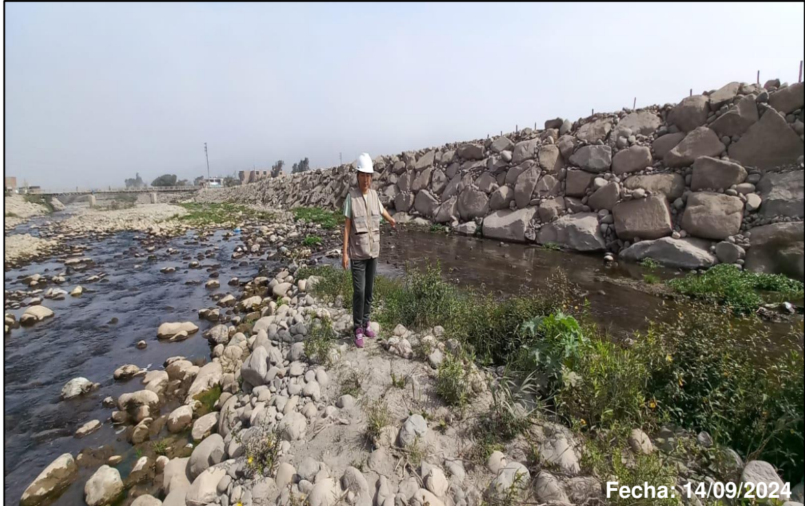
Foto 8: Se identificó que las juntas entre las rocas presentan aberturas notables, margen derecha del río Chillón, aguas arriba del puente Trapiche
