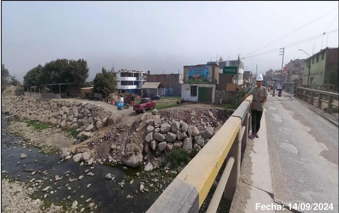
Foto 4: Deslizamiento del relleno del enrocado, margen derecha del río Chillón, aguas abajo del puente Trapiche
