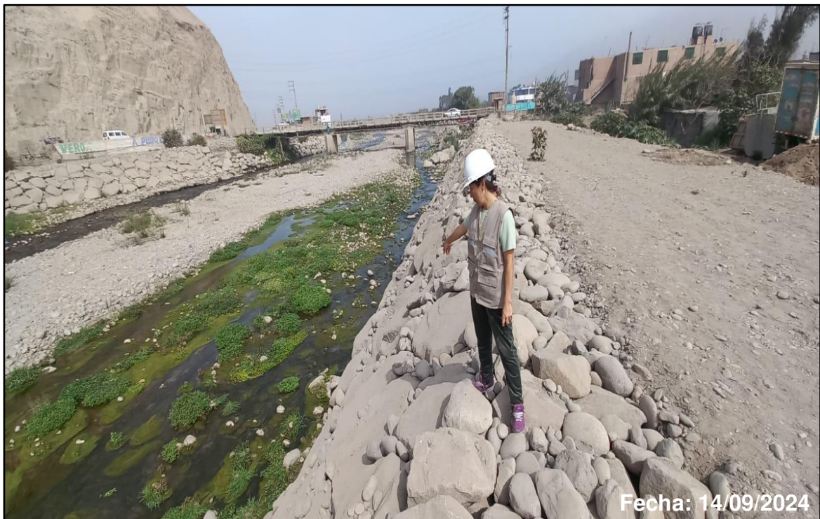
Foto 6: Deslizamiento y tamaño de relleno inadecuado del enrocado, margen derecha del río Chillón, aguas arriba del puente Trapiche
