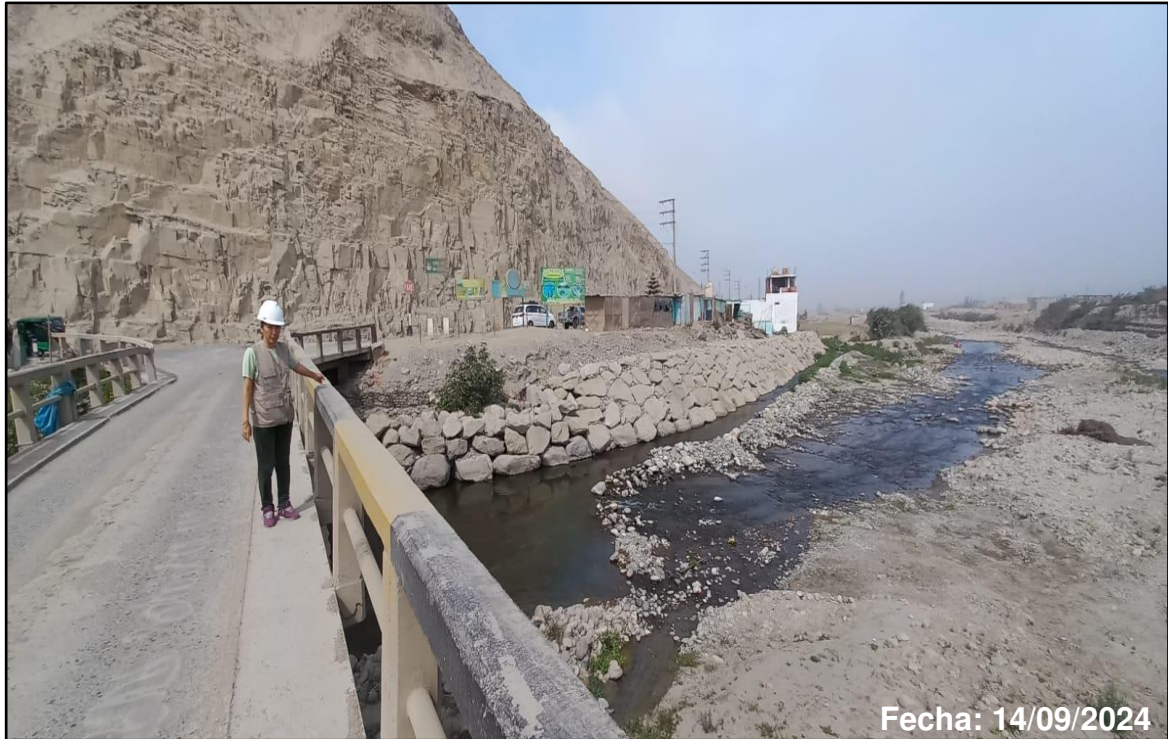
Foto 13: Se aprecia erosión y socavación en la base del enrocado, margen izquierda del río Chillón, aguas abajo del puente Trapiche
