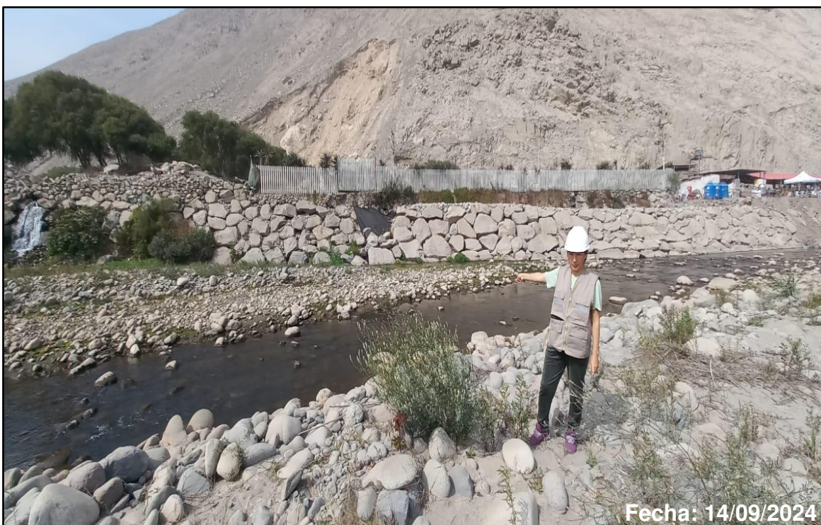
Foto 18: Se observó que las juntas entre las rocas presentan aberturas notables, margen izquierda del río Chillón, aguas arriba del puente Trapiche
