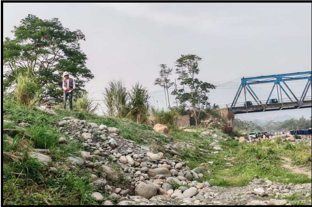
Figura 25: Defensa ribereña relleno con piedras y arenas desde el río.
