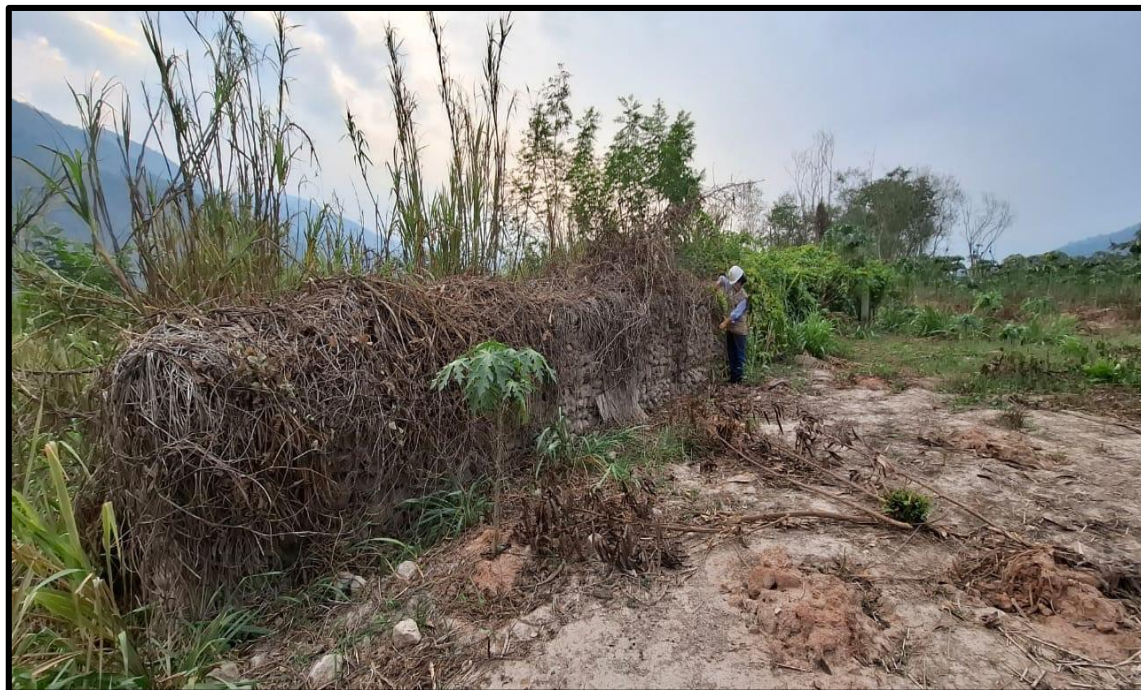
Figura 7: Maleza muro de gaviones
