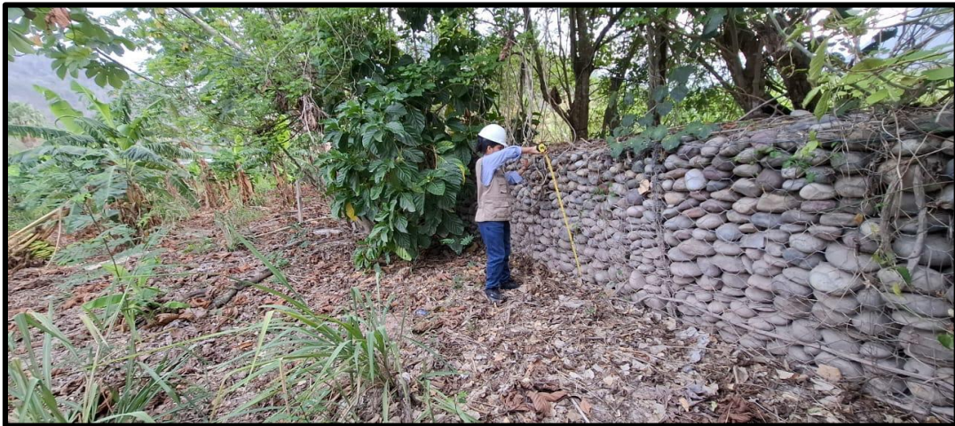
Figura 2: Muros de gaviones con presencia de maleza
