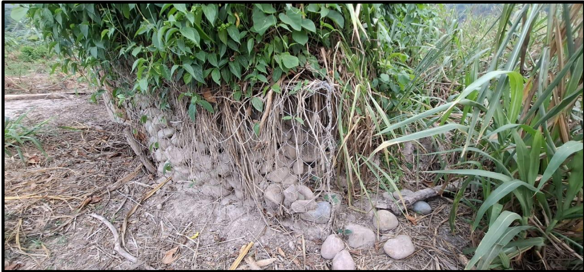
Figura 4: Muros de gaviones desprendidos
