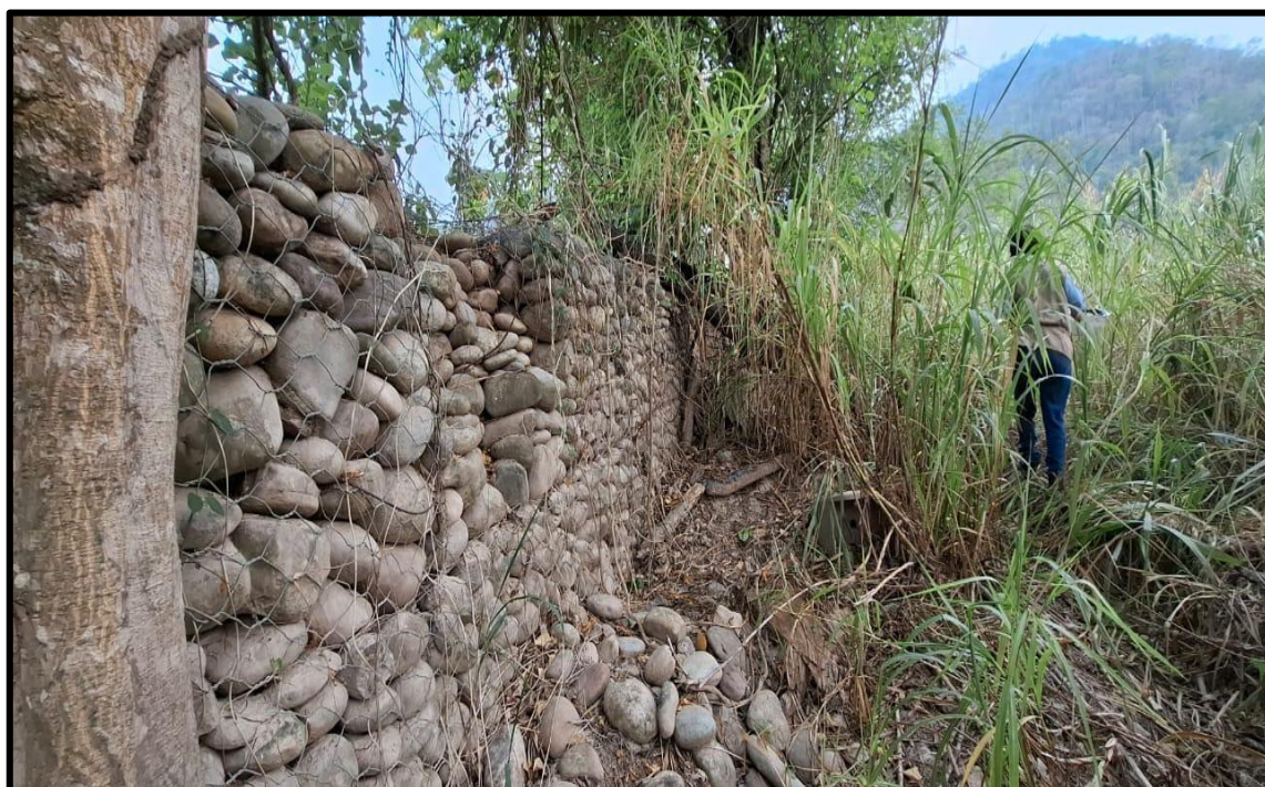
Figura 18: muros de gaviones desprendidos y con pérdida de rocas
