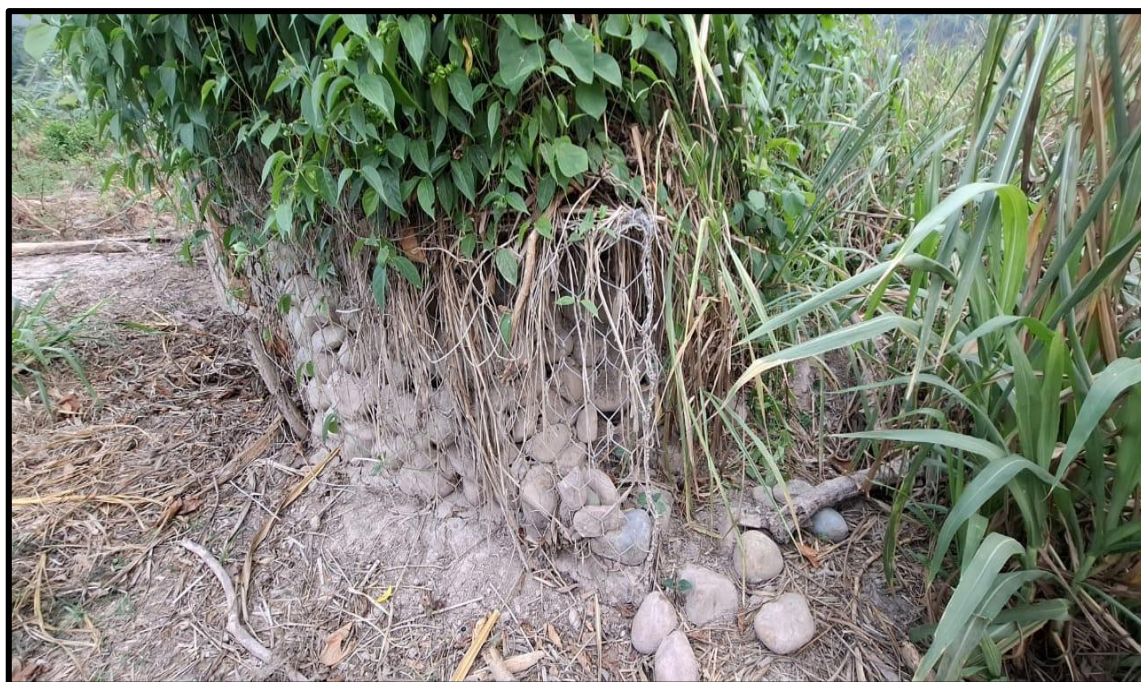
Figura 6: Desplome de muro de gaviones y rotura de malla Fuente: Evidencia de campo
