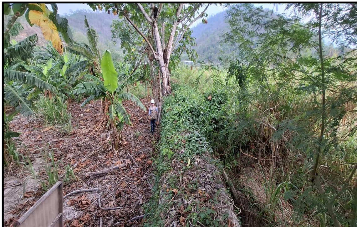
Figura 17: evidencia deformación por el mal llenado de rocas
