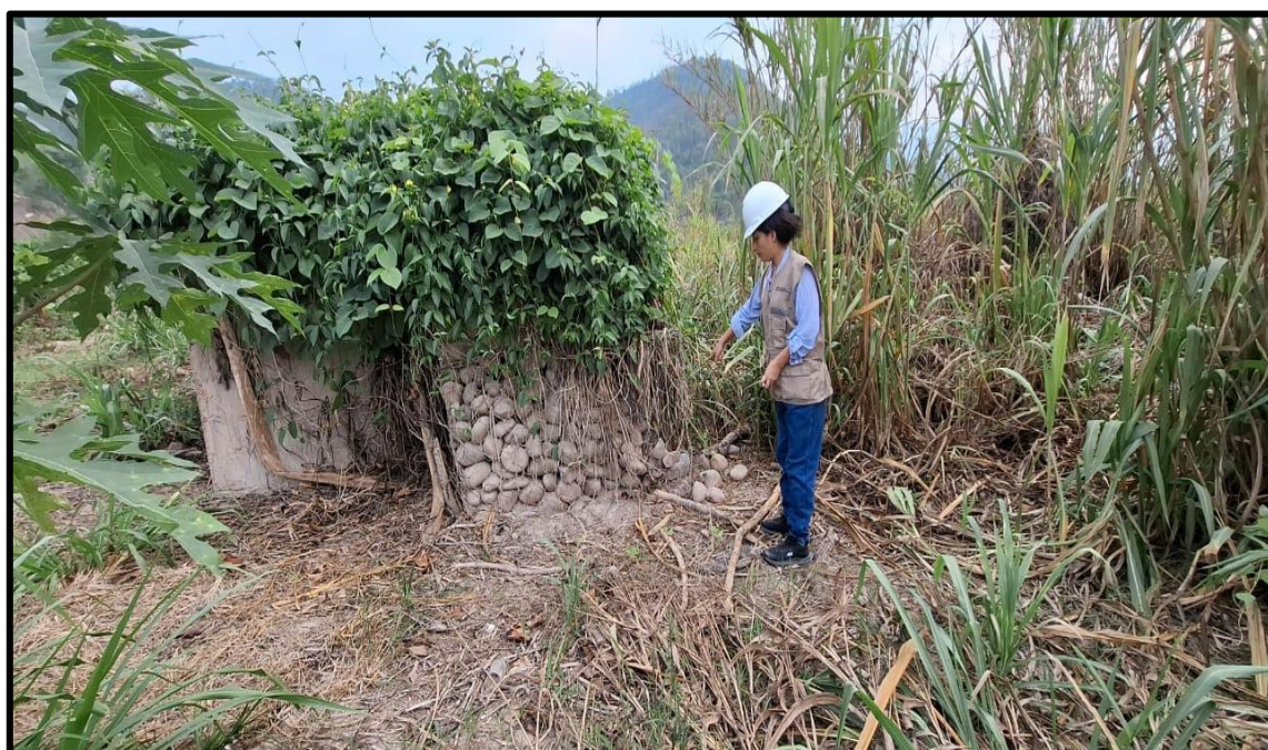
Figura 12: muros de gaviones desprendidos
