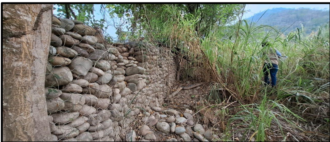
Figura 3: Muros de gaviones desprendidos
