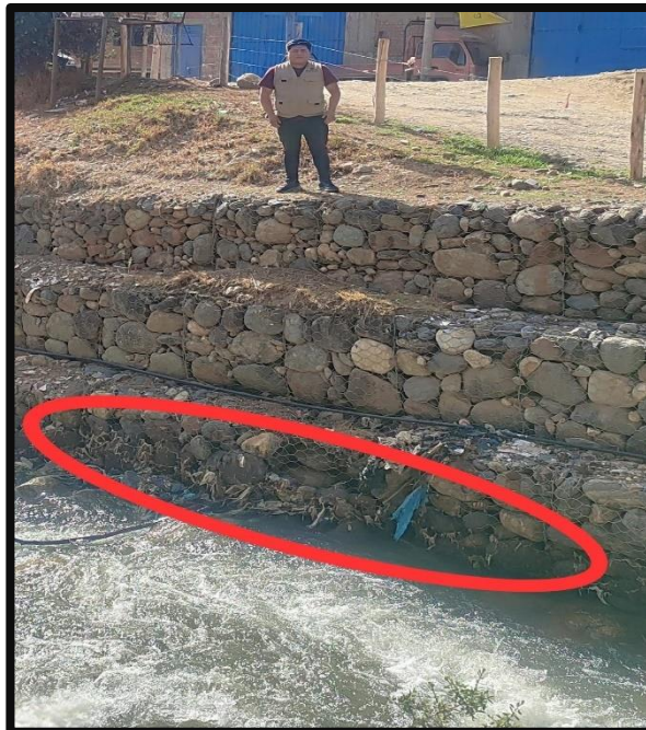
Figura 16: Vista de socavación en el muro de gavión.
