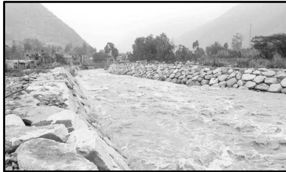
Figura N° 12: Defensa ribereña de enrocado.
