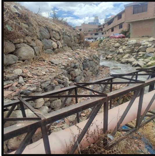
Figura 11: Se observa desechos en el primer y segundo nivel del muro de gavión.
