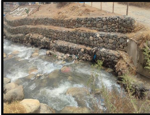
Figura 13: Vista de desalineamiento en el muro de gaviones.
