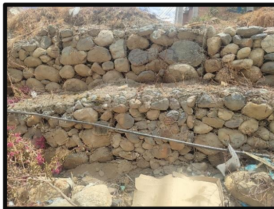
Figura 12: Deformaciones del muro de gavión.
