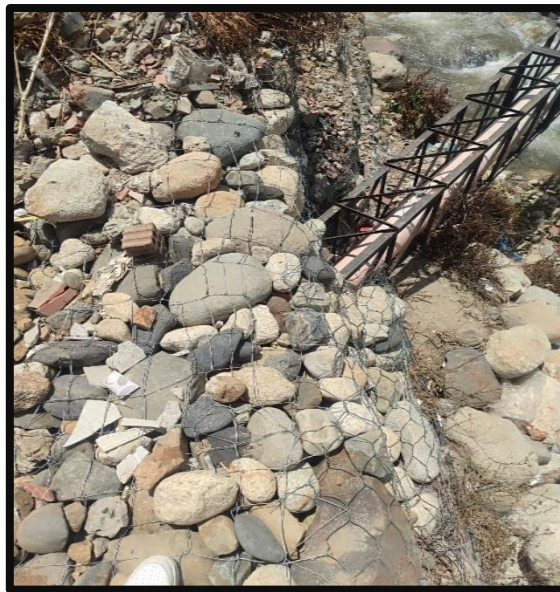
Figura 8: Roturas de la malla en la corona del muro de gaviones.
