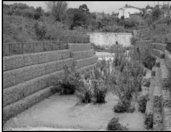
Figura N° 08: Muro gavión en ríos.
