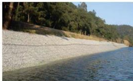
Figura 2. Gaviones para contención fluvial. Fuente: (A Bianchini, 2017).
