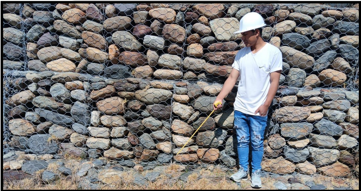
Figura 12: Medición de la obstrucción de base . Fuente: Elaboración propia.
