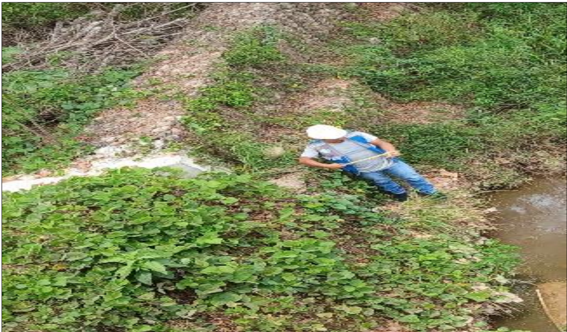
Figura 35: Se observa vegetación por encima de la estructura
