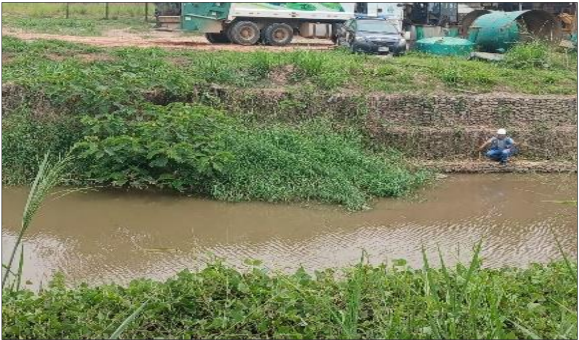
Figura 41: Se observa socavación y vegetación de 20 m lineales
