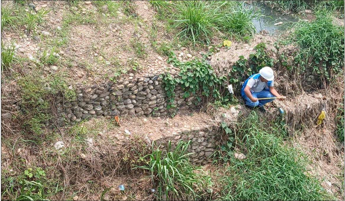
Figura 34: Se observa mucha vegetación en el tramo 0+200 a 0+300
