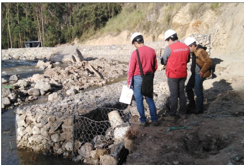
Figura 10: Fallas estructurales en el muro de gaviones
