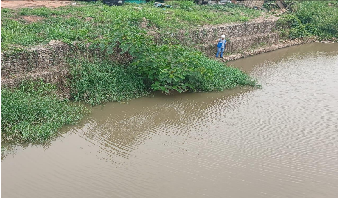
Figura 38: Se aprecia socavaciones de 10 m lineales
