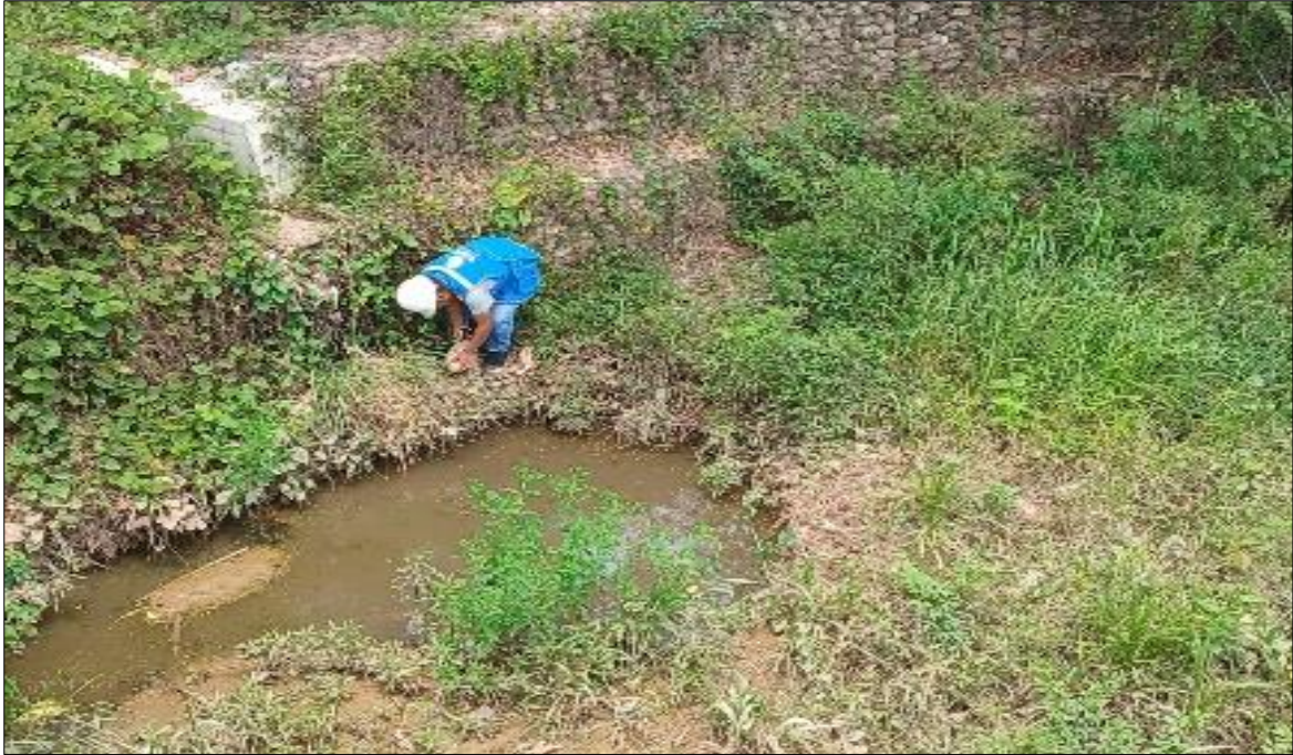
Figura 36: Se observa socavación en el tramo 0+400 a 0+500
