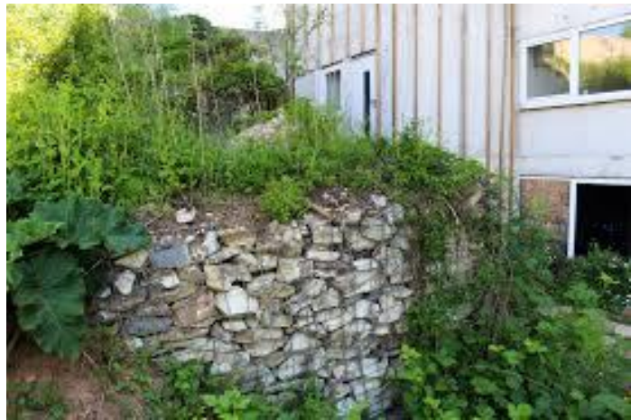
Figura 7: Estado de muro de gavión Fuente: Extraído de la página de Rotfuss (30)
