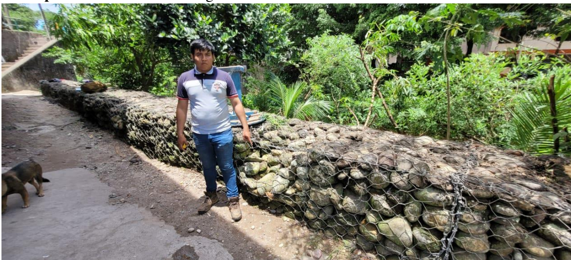
Figura 20: Evidencia de campo - Segunda zona vulnerable
