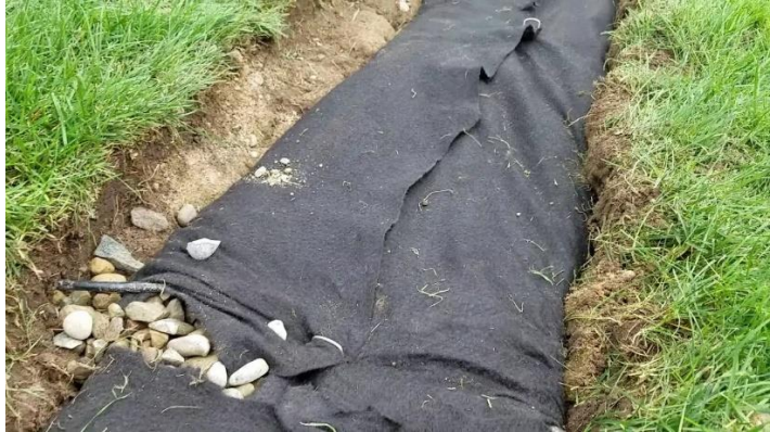
Figura 12: Estado de geotextil
