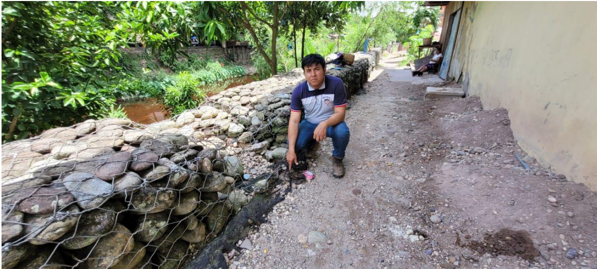
Figura 21: Evidencia de campo – Primera zona vulnerable
