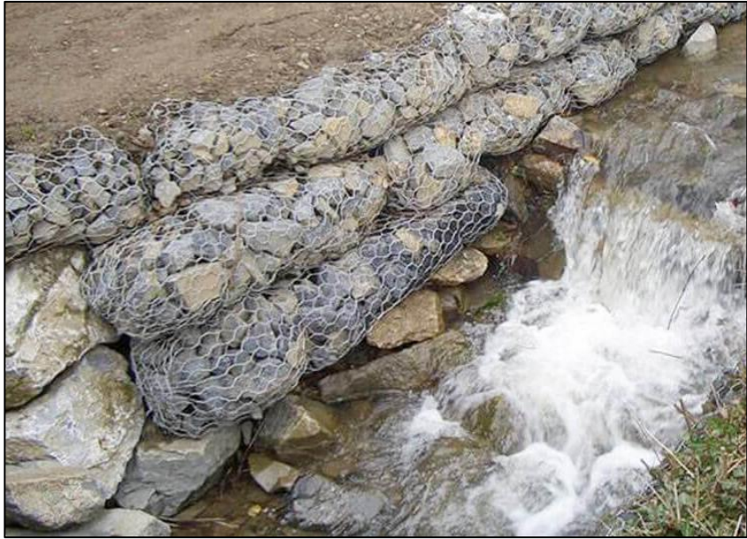
Figura 5: Saco de Gaviones
