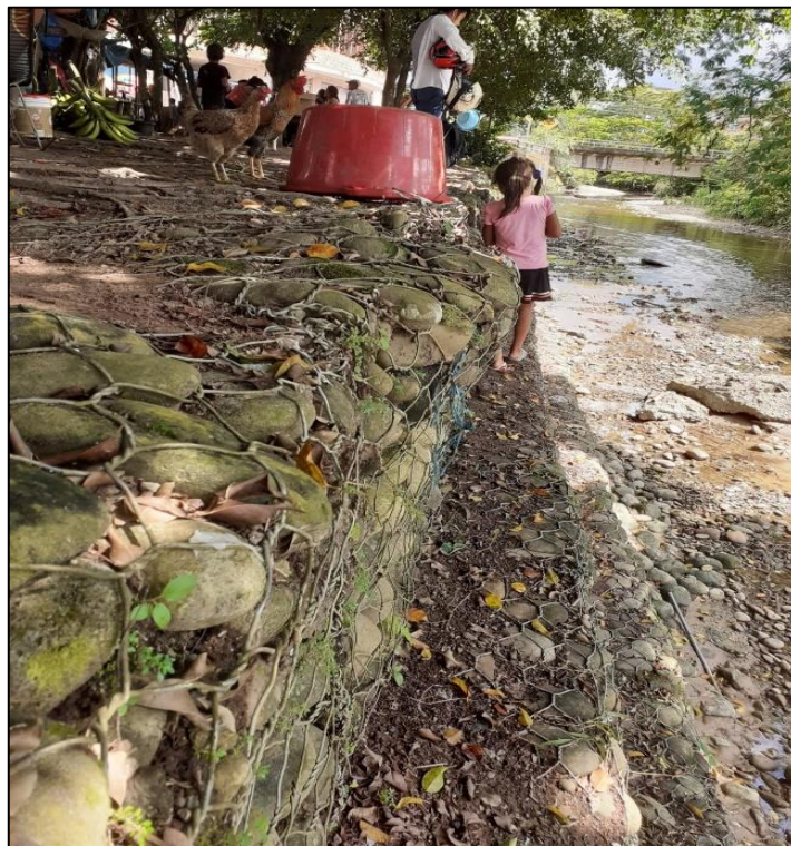
Figura 15: Tercera zona crítica del Muro de Gaviones de la defensa ribereña del Rio Negro.
