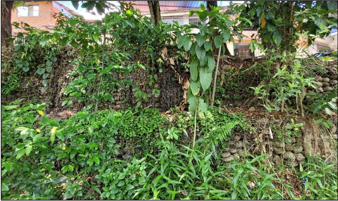
Figura 20: Vista panorámica de la presencia de vegetación excesiva en el muro de gaviones de la defensa ribereña del Río Negro.
