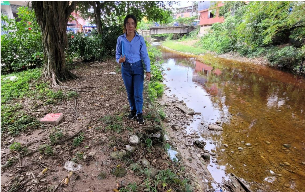
Figura 27: Identificación de la cuarta zona crítica del muro de gaviones de la defensa ribereña del Río Negro.
