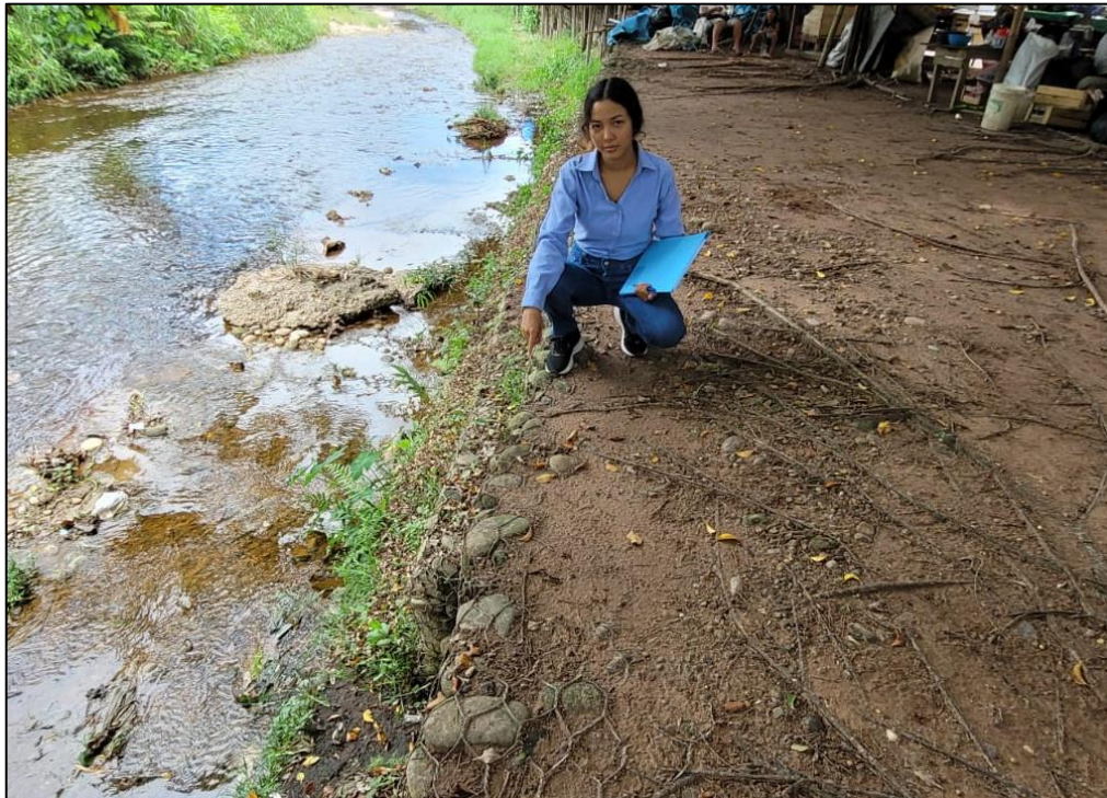
Figura 25: Identificación de la tercera zona crítica del muro de gaviones de la defensa ribereña del Río Negro.
