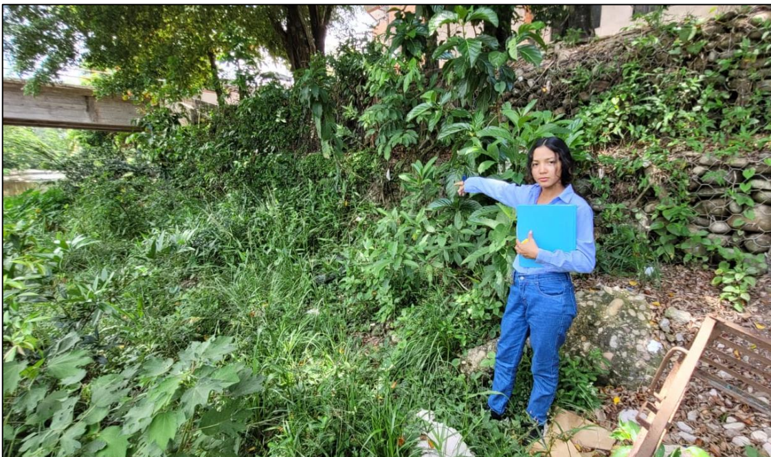
Figura 21: Identificación de la primera zona crítica del muro de gaviones del Río Negro.
