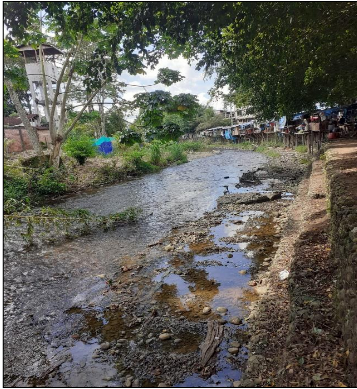
Figura 12: Vista panorámica del muro de gavión en el Río Negro al final de la progresiva 0+500.
