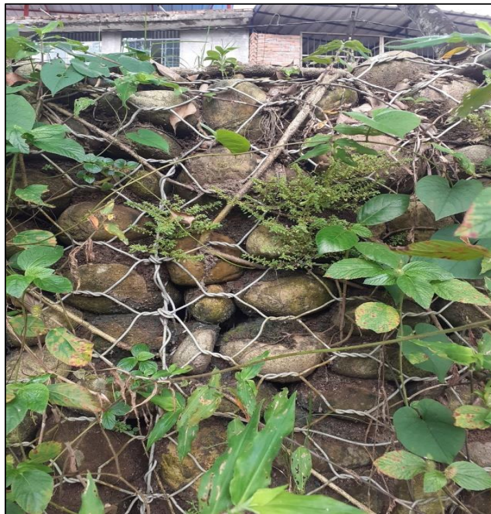
Figura 13: Primera zona crítica del Muro de Gaviones de la defensa ribereña del Río Negro.
