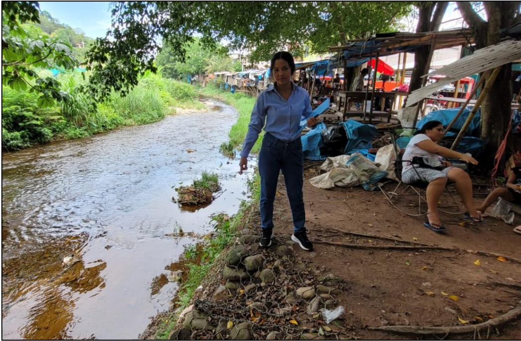
Figura 26: Identificación de la cuarta zona crítica del muro de gaviones de la defensa ribereña del Río Negro.
