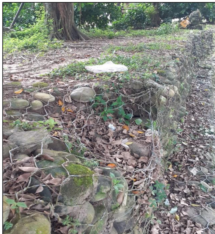
Figura 17: Quinta zona crítica del Muro de Gaviones de la defensa ribereña del Rio Negro.
