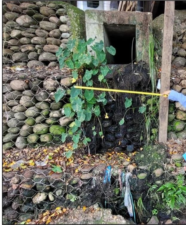
Figura 14: Segunda zona crítica del Muro de Gaviones de la defensa ribereña del Rio Negro.
