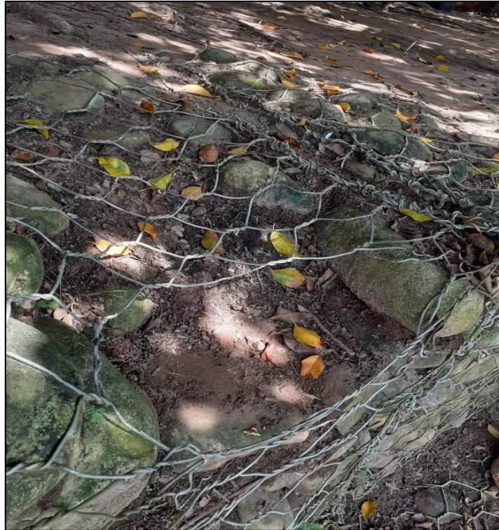
Figura 16: Cuarta zona crítica del Muro de Gaviones de la defensa ribereña del Rio Negro.
