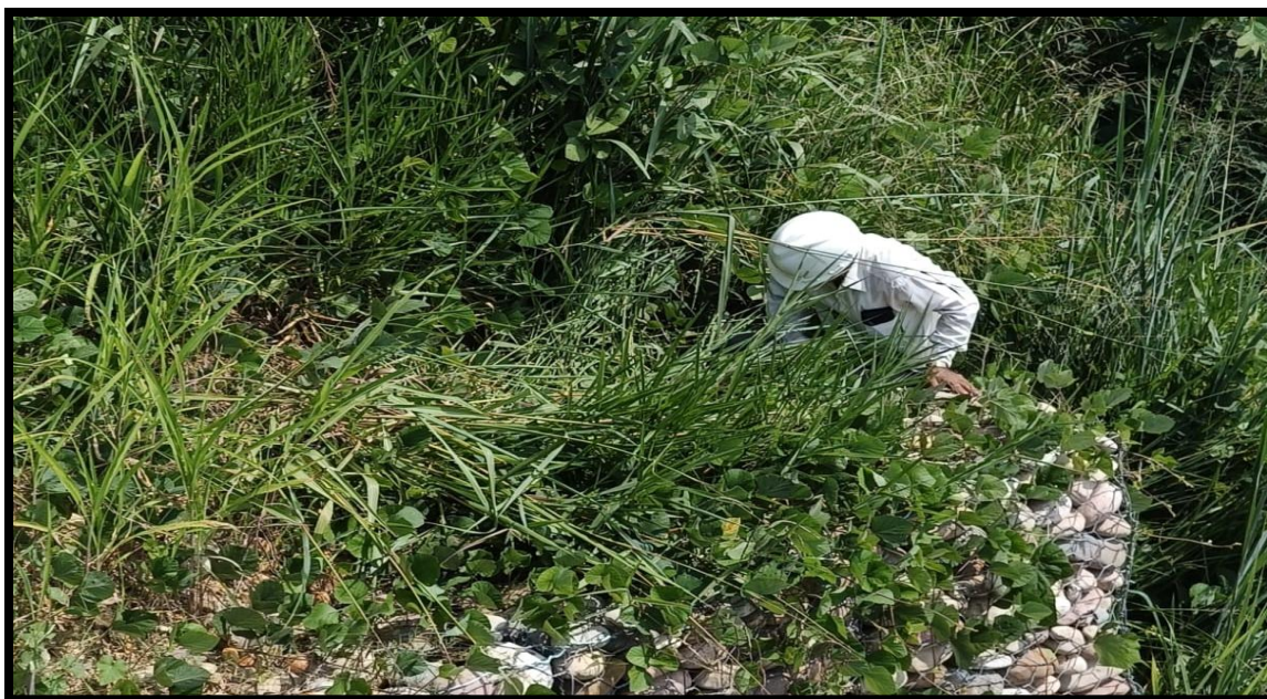
Fotografía 5. Se observa mucha vegetación en los diferentes niveles de muro de gaviones en el talud de tierra en el río Wipungo
