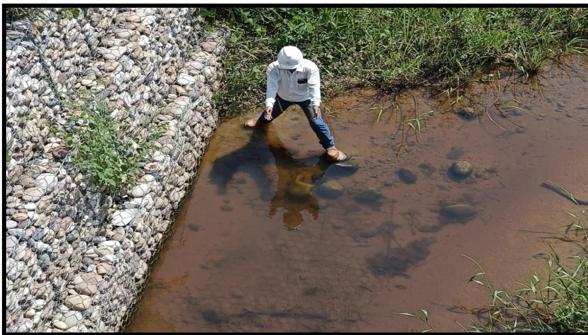
Fotografía 7. Se observa poca presencia de afluente del río en la base del gavión sobre cochón reno
