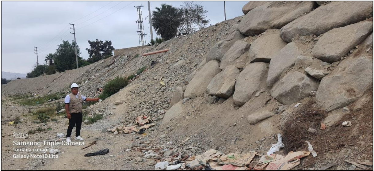
Figura 20: Deterioro de juntas del enrocado del río Solivín
