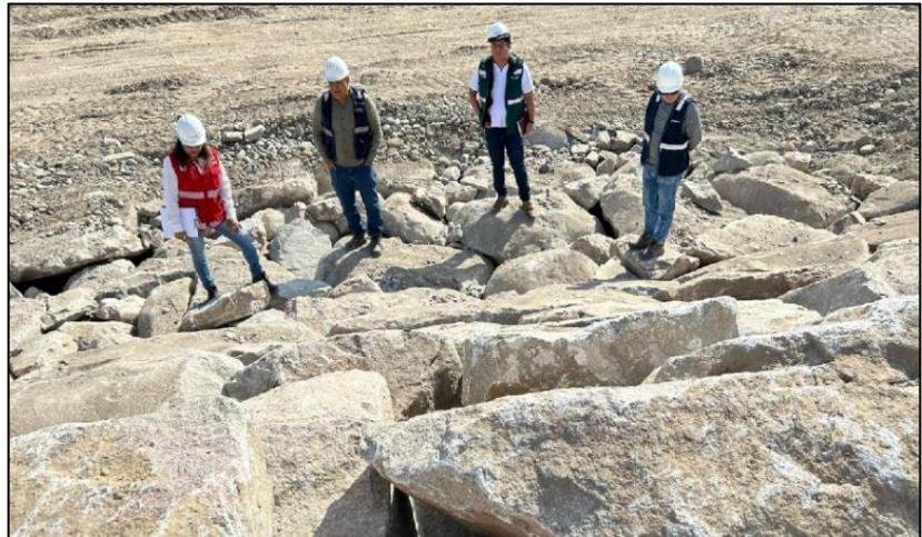
Figura 2. Evaluación de deterioro de juntas
