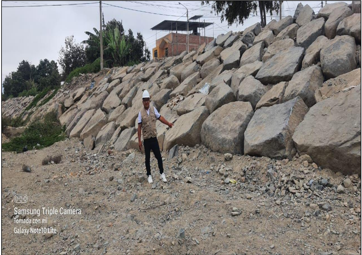
Figura 22: Pérdida de integridad del enrocado en el río Solivin
