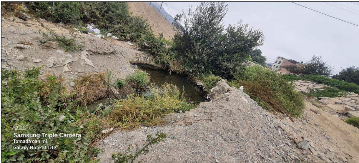
Figura 21: Erosión del enrocado del río Solivín
