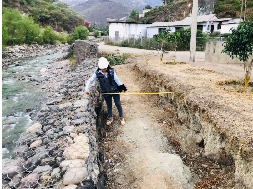
figura 9: Los tres niveles de gaviones presentan deformaciones debido al empuje que ejercerá el terreno
