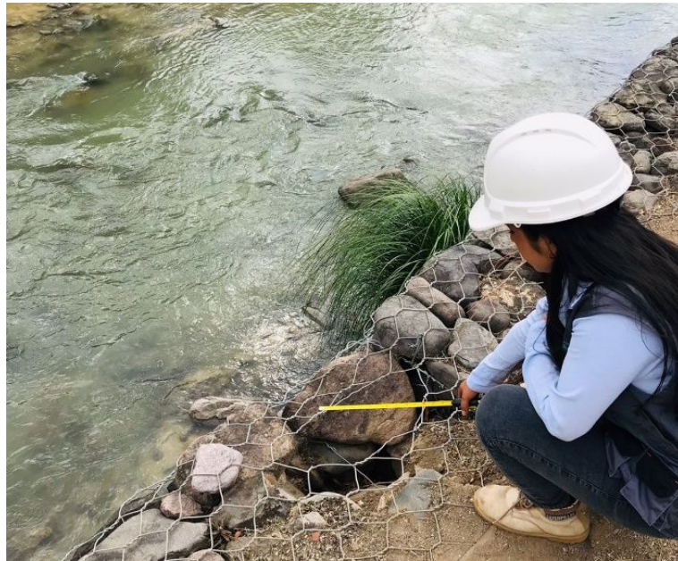
figura 10: se observó que existe rotura de la malla en el primer nivel de la progresiva 0+200 a 0+220, afectando el encajonado de cubos con una longitud de 12 cm, en consecuencia, le falta material de relleno
