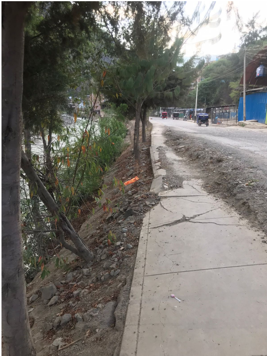
Ilustración 13: Los tres niveles de gaviones presentan deformaciones debido al empuje que ejercerá la pista, además la presencia de vegetación y la presencia de basura
