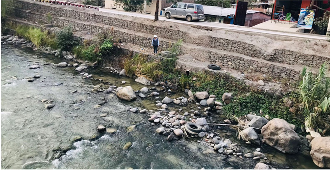
figura 11: Se observa la presencia de vegetación en los bordes de los muros de gaviones en toda la construcción así como también la deformación de los muros de gaviones en la progresiva 0+260 a 0+280
