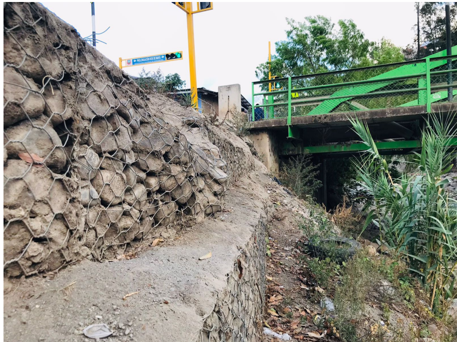
figura 12: Se observa la rotura de la malla de los 2 niveles así como también la presencia de vegetación
