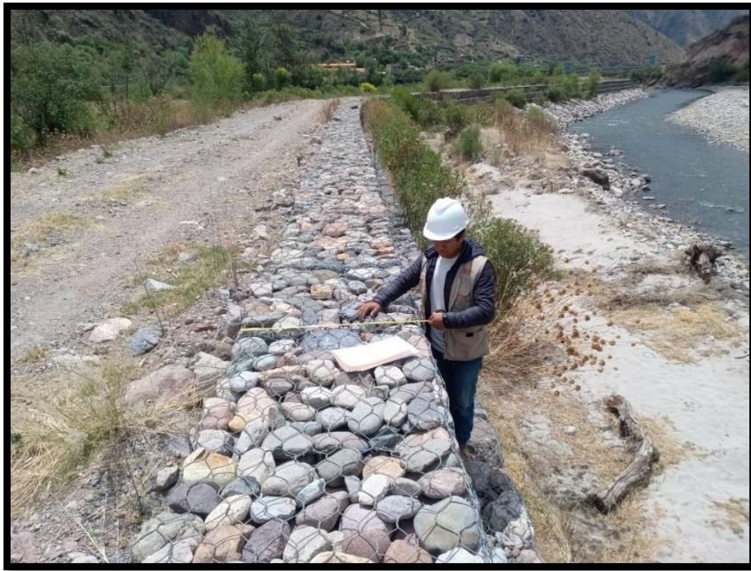
Figura 34: Evaluación de los anchos del muro de gavión
