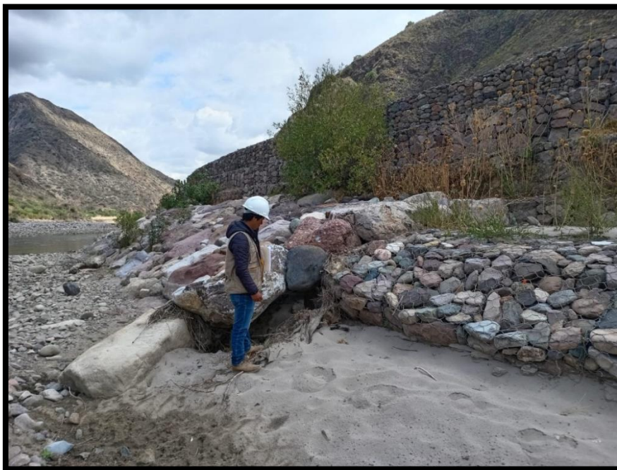
Figura 41: evaluación de la socavación del Colchón Reno
