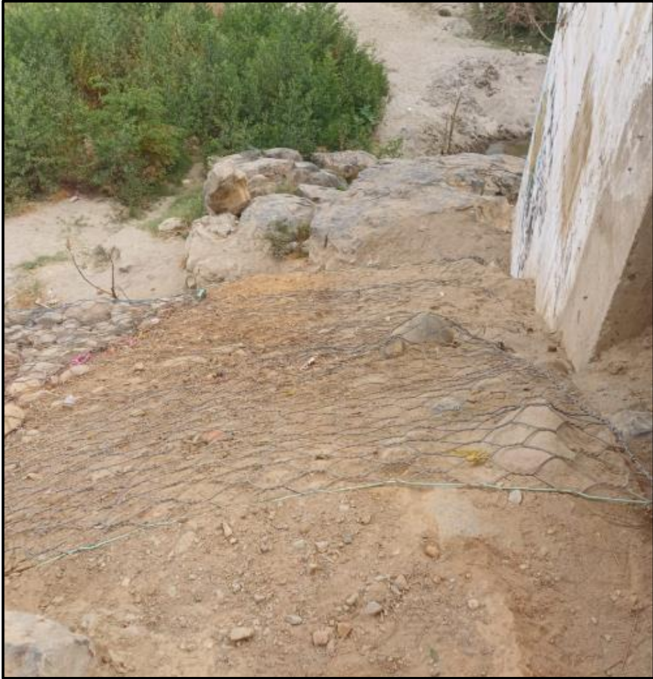
Figura 9: observaciones sobre la rotura de la malla
