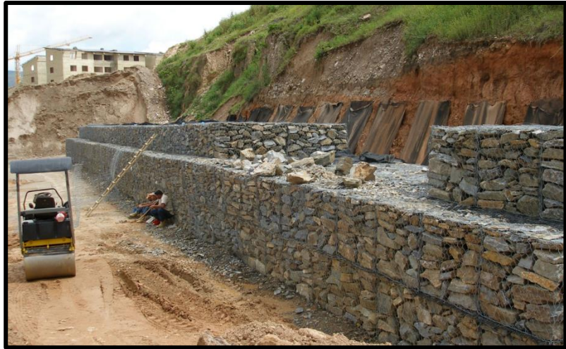
Figura 11: Deslizamientos de muro Fuente: COMISUR-Eco Green Construcciones
