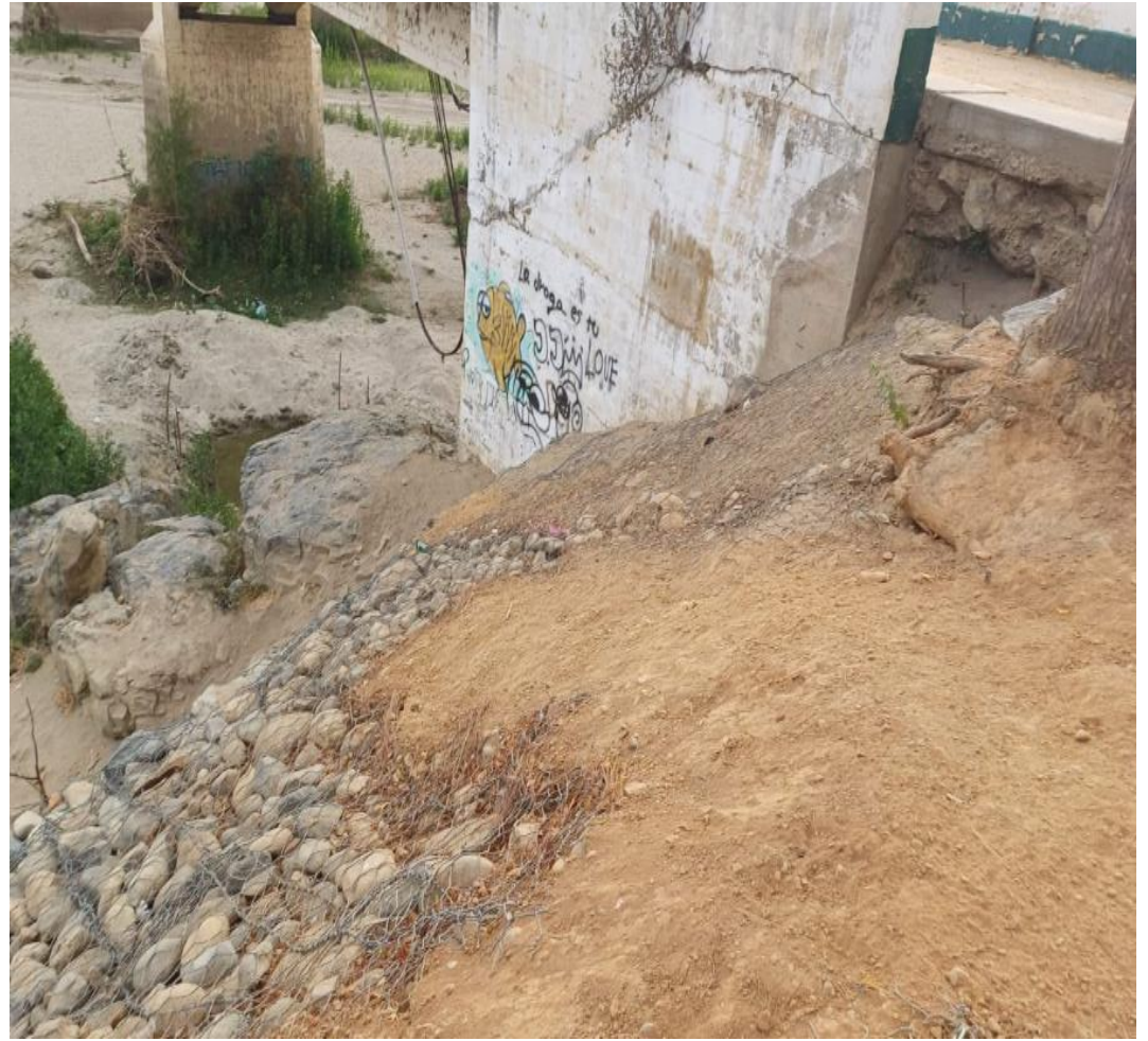
Figura 10: Observaciones de las condiciones que se encuentra la malla
