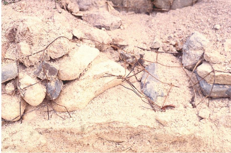
FOTOGRAFÍA 7.3 La corrosión es el principal problema de las mallas.
