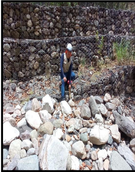
Figura 14: Muro de Gavión con daños en la base
