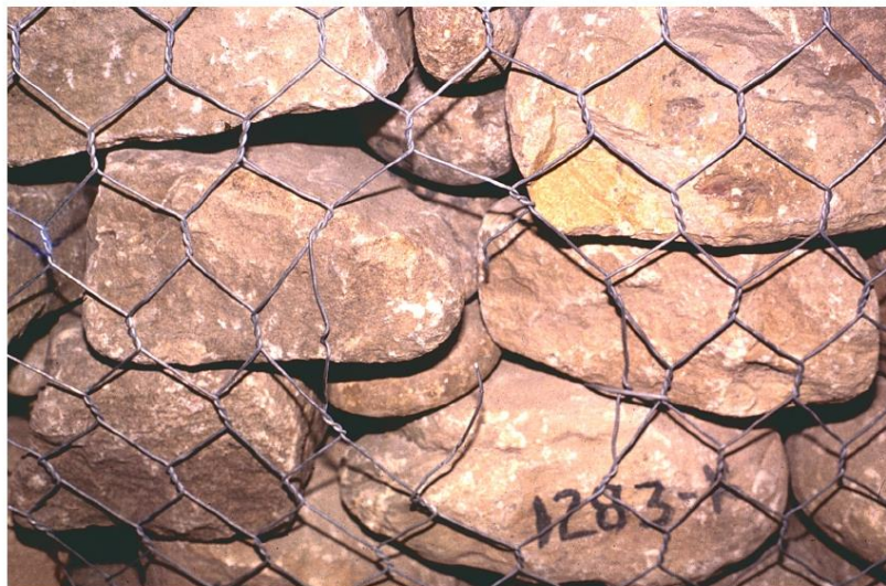
FOTOGRAFÍA 7.2 La malla se rompe por los puntos de entorclamiento o torsión.
