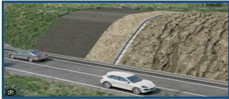
Figura 05 : Erosión de taludes
