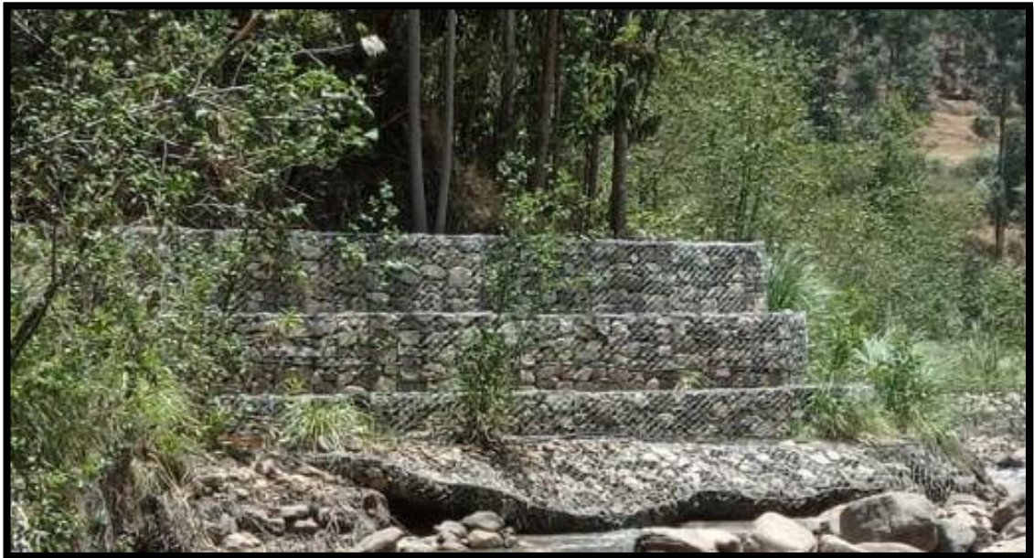
Figura 16: Pequeña deformación de 35 cm en la base del muro
