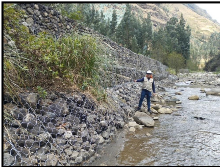
Figura 08: Indicios de socavación en la base del muro de gavión
