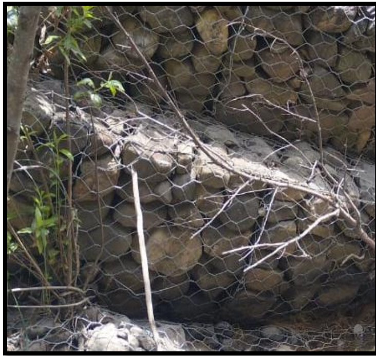
Figura 18: Deformación del muro de Gavión por socavación
