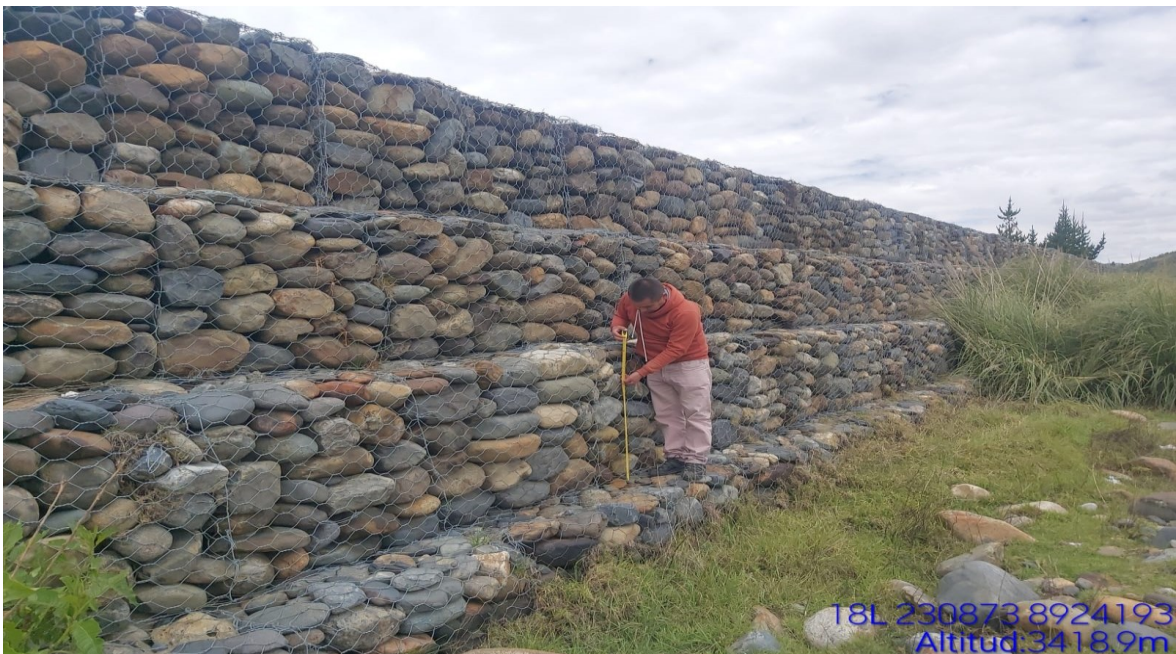
Figura 8: Evaluación del muro de gaviones Fuente: Elaboración propia
