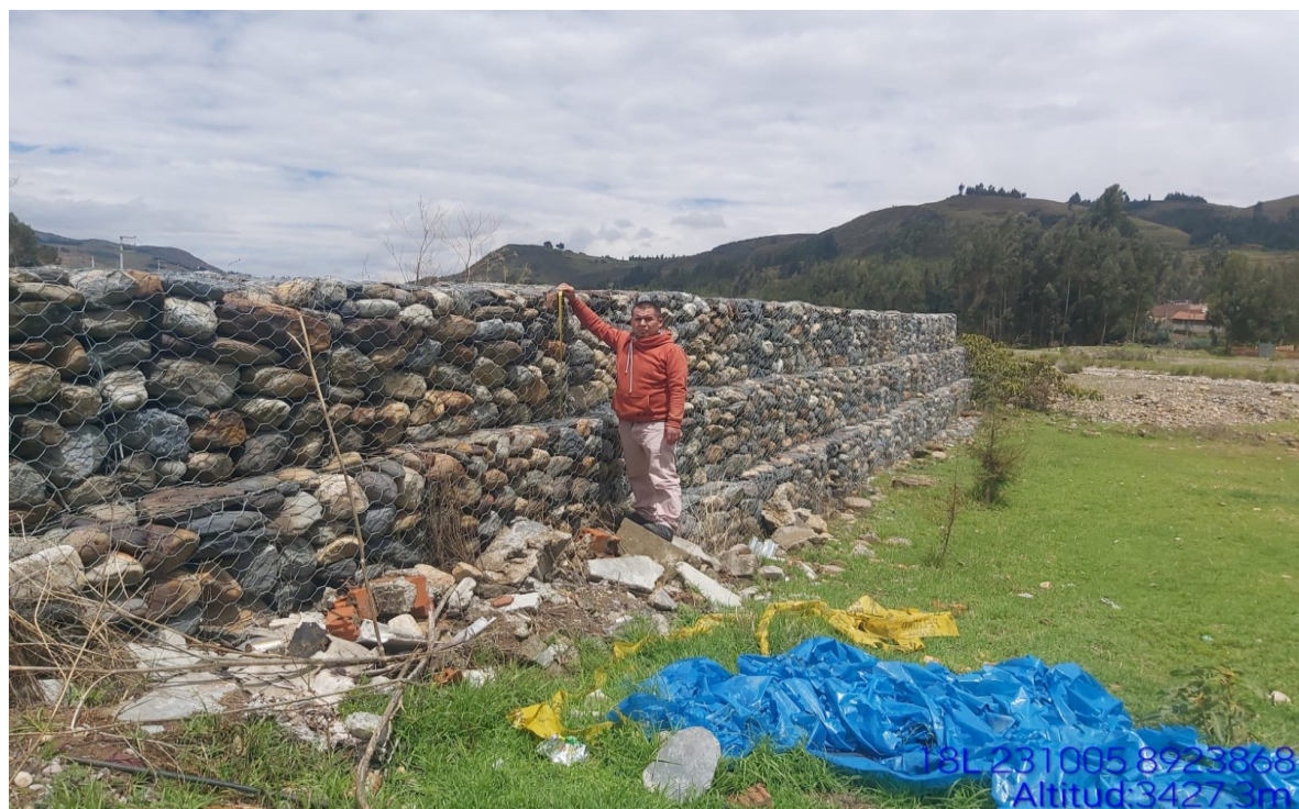
Figura 4. Escombro en los gaviones
