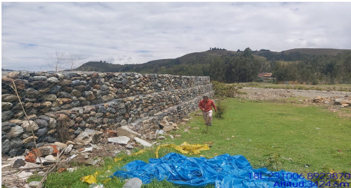
Figura 3. Muro de gaviones
