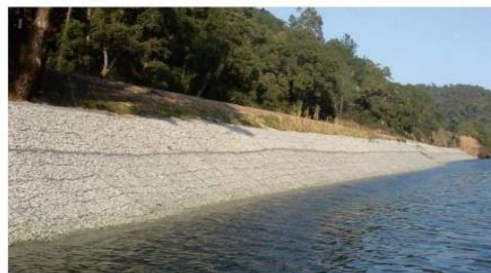
Figura 2. Gaviones para contención fluvial. Fuente:(A Bianchini, 2017).
