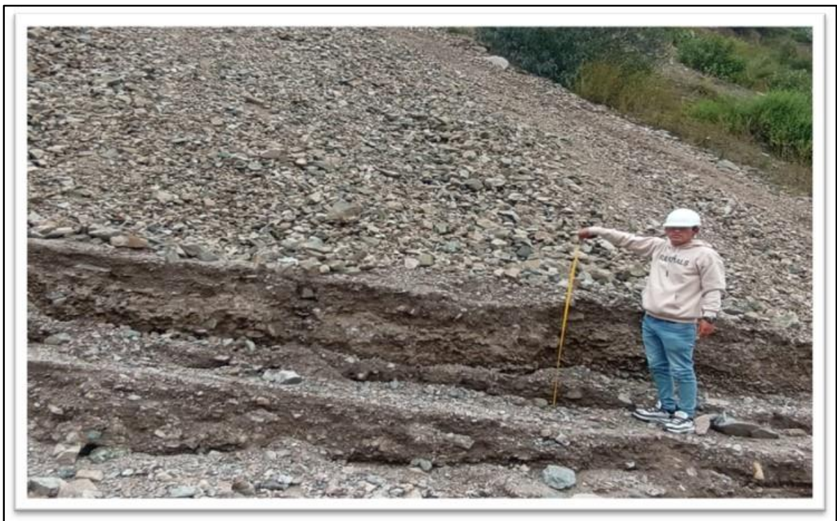
Figura 16: Altura de la socavación
