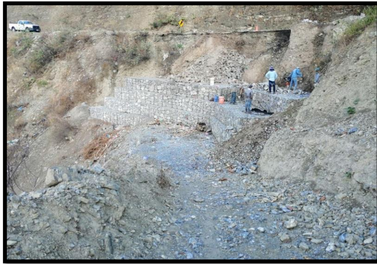
Figura 6: Deslizamiento de tierra
