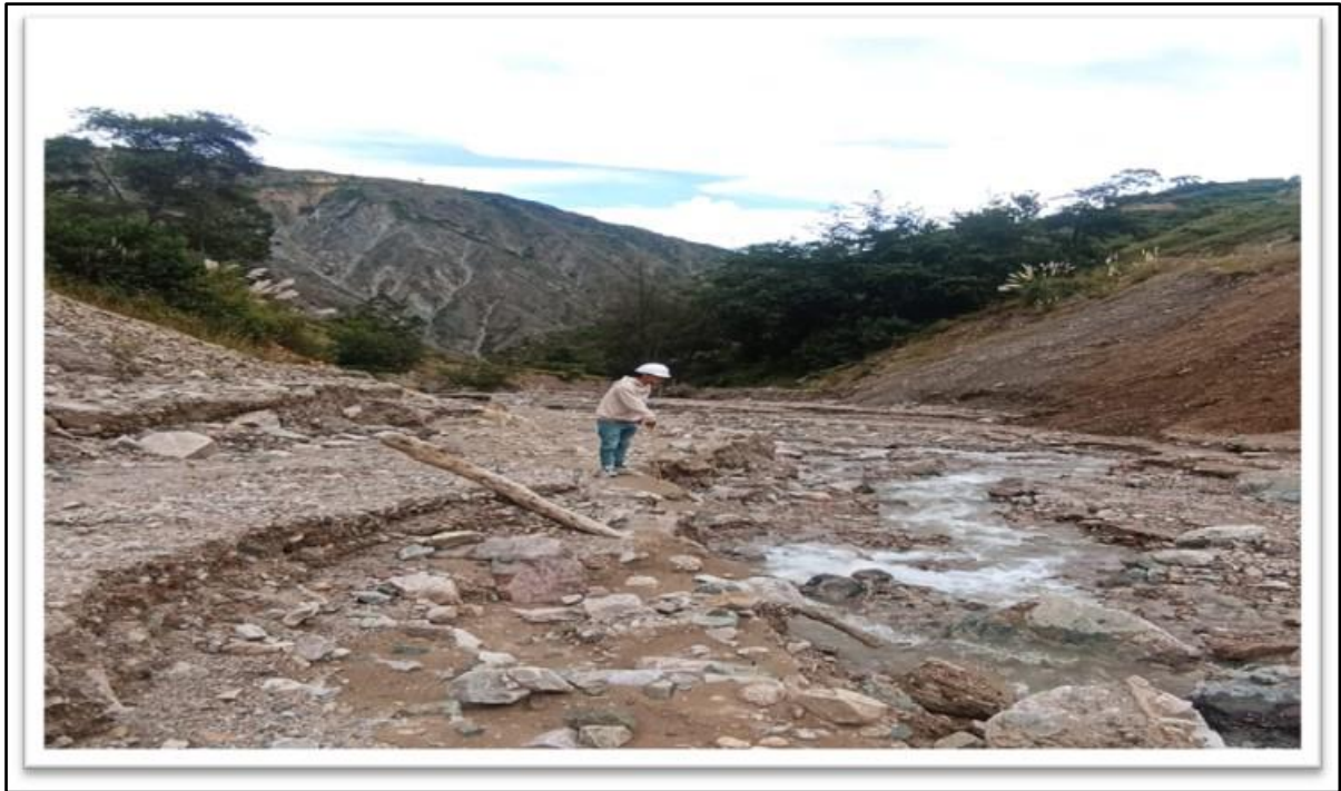
Figura 17: Socavación ocasionada por el río
