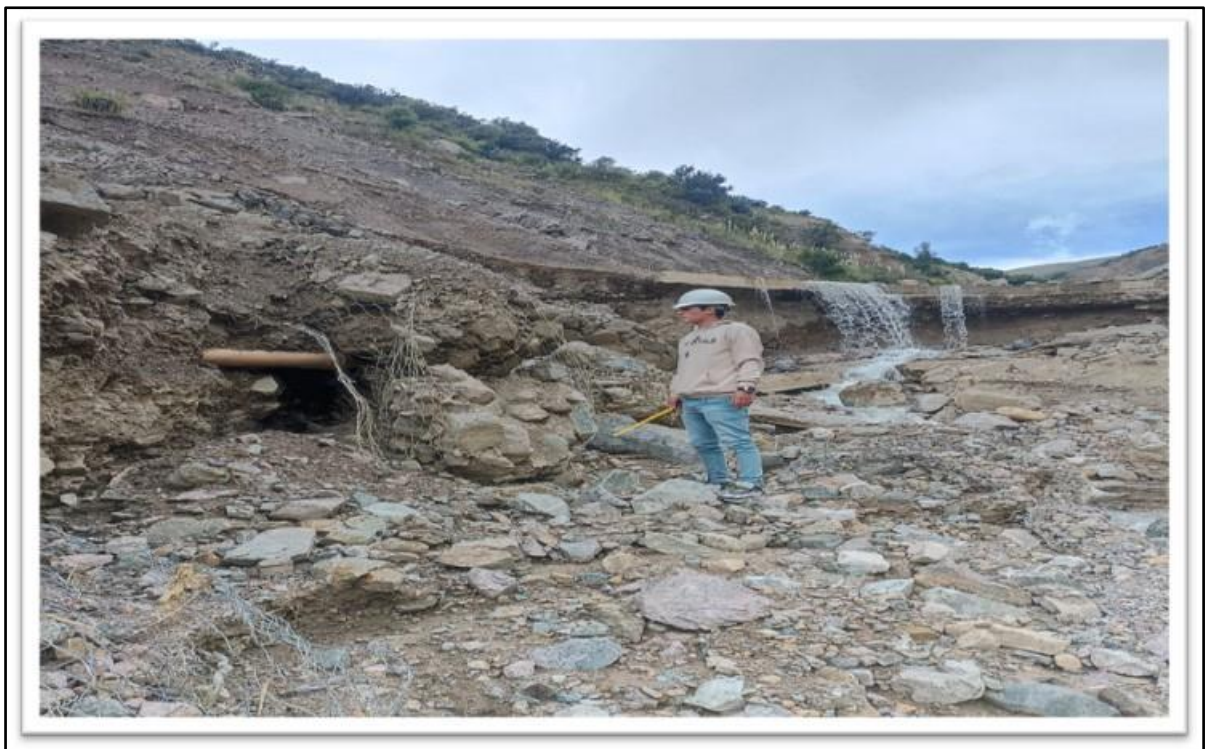
Figura 22: Muro de gavión afectado por la socavación
