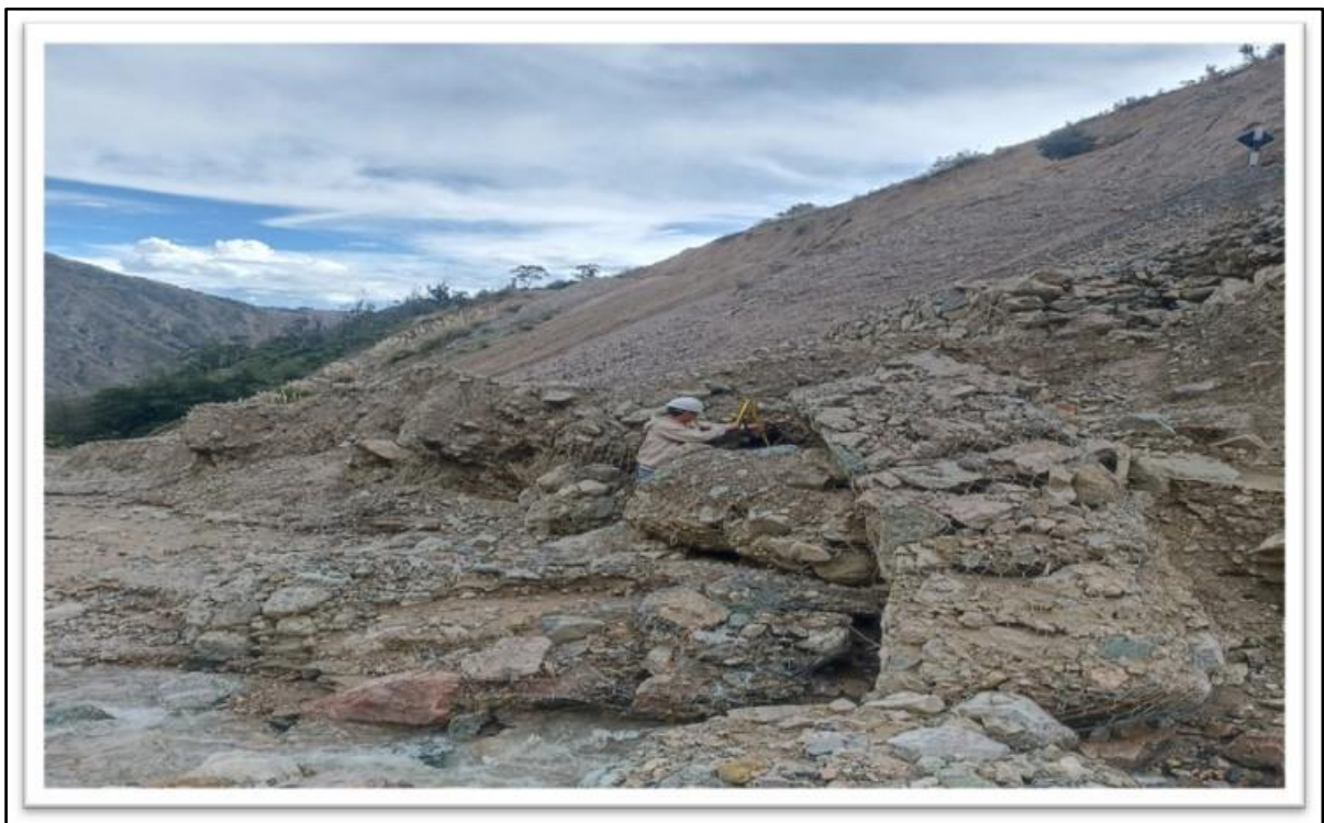
Figura 20: Perforación causada por el río
