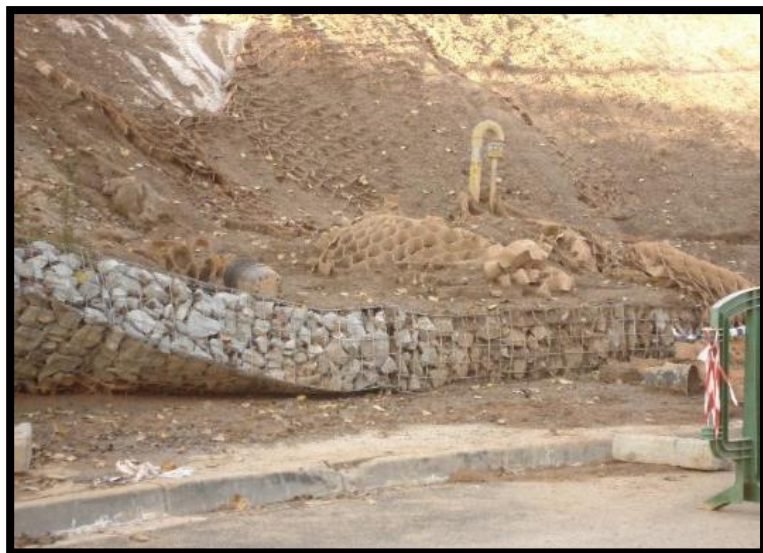
Figura 8: Volteo de un muro de gavión
