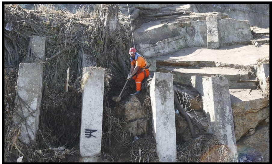
Figura 10: Escombros y vegetación
