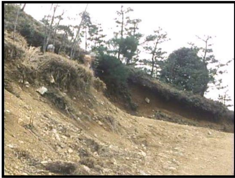
Figura 7: Socavación de un muro de gavión
