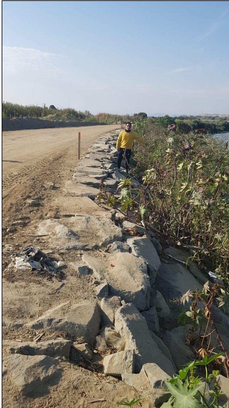
Figura 10. Observamos malezas en la defensa ribereña la cual puede causar fallas en la estructura.
