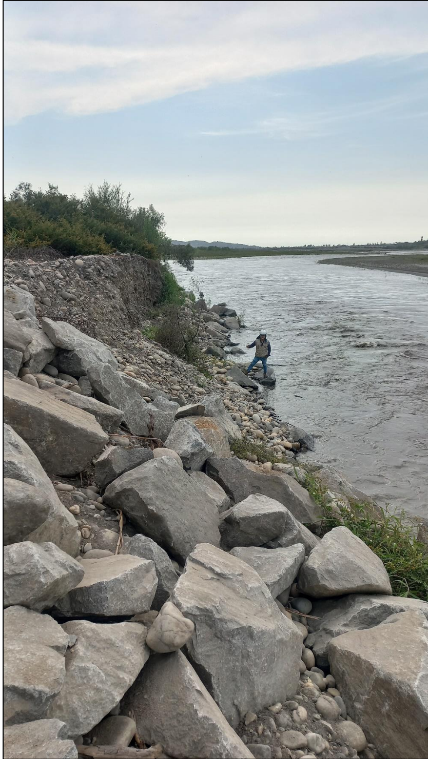
Figura 12. Observamos caída de rocas del km 14+153 al 14+180.
