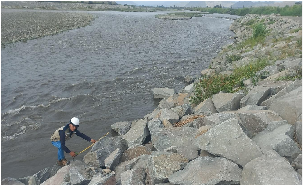
Figura 8. Vista panorámica de la defensa ribereña tipo enrocado en el centro poblado.
