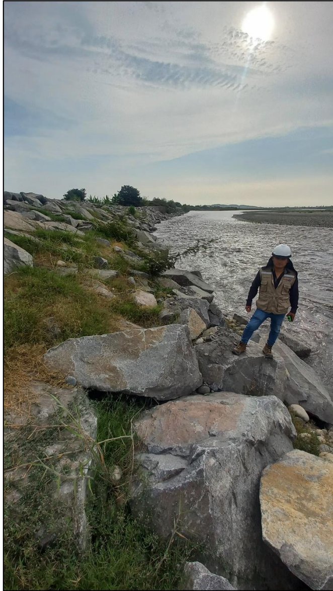
Figura 13. Observamos vegetación en medio del enrocado y el desprendimiento de rocas en el km 14 +030
