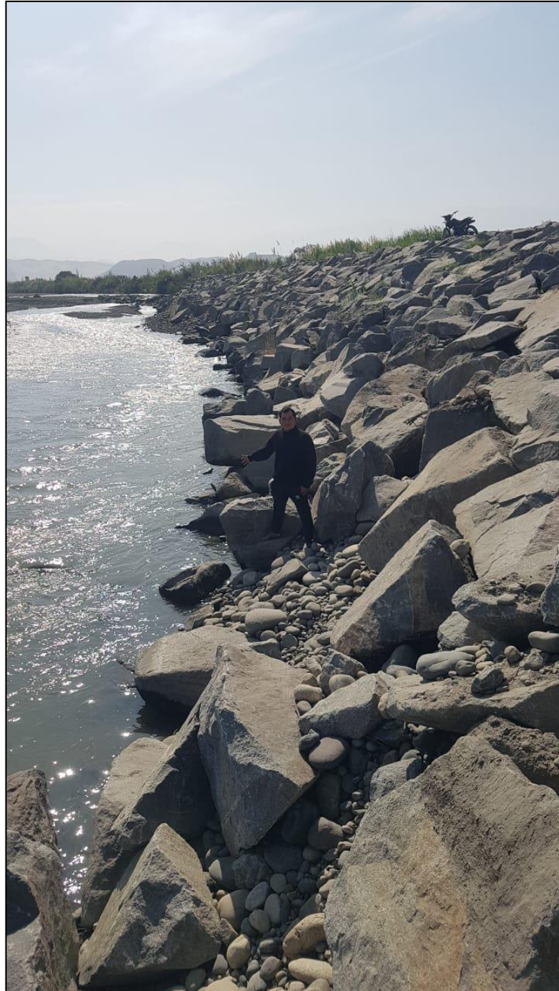
Figura 11. Observamos erosión en la parte baja del enrocado.
