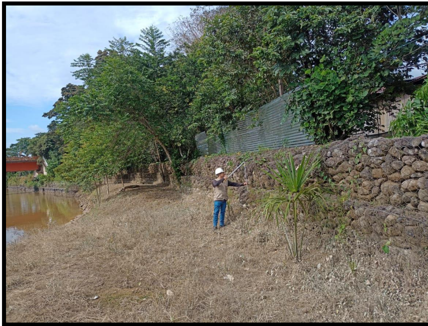
Figura 14: Maleza entre muros de gaviones
