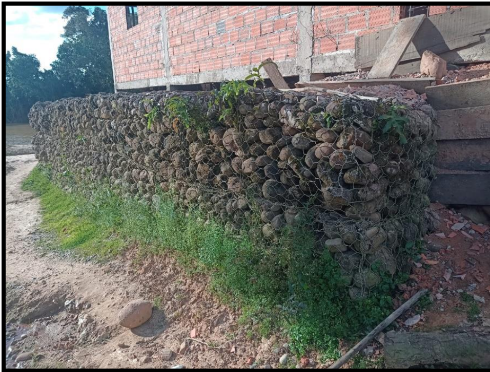
Figura 8: asentamiento de muro de gaviones
