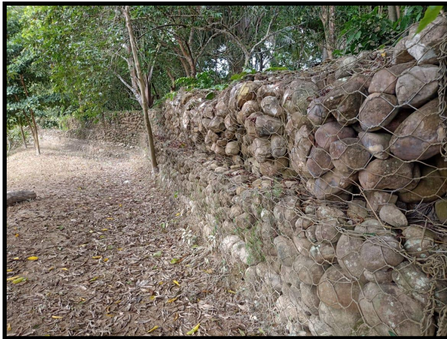
Figura 16: vacíos entre rocas y evidencia del mal llenado de rocas
