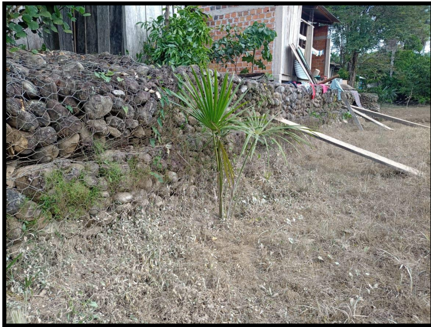
Figura 2: desplome de cajas de gaviones Fuente: Evidencia de campo
