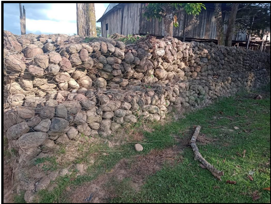
Figura 5: desplome de muro de gaviones y rotura de malla
