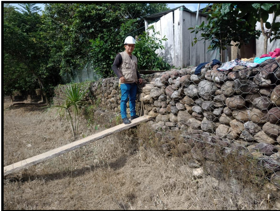
Figura 13: problemas de voltea en muros de gaviones
