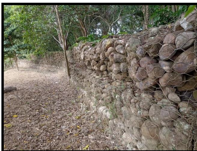
Figura 1: vacíos entre rocas y evidencia del mal llenado de rocas
