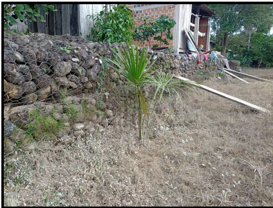
Figura 15: desplome de cajas de gaviones
