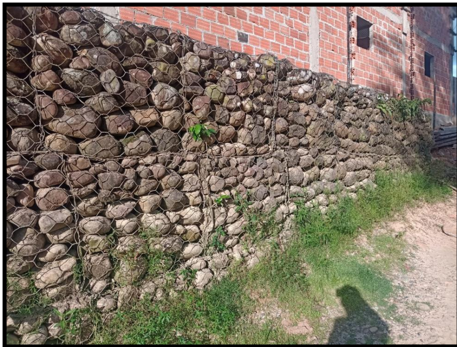
Figura 7: desnivel en base de muros de gaviones
