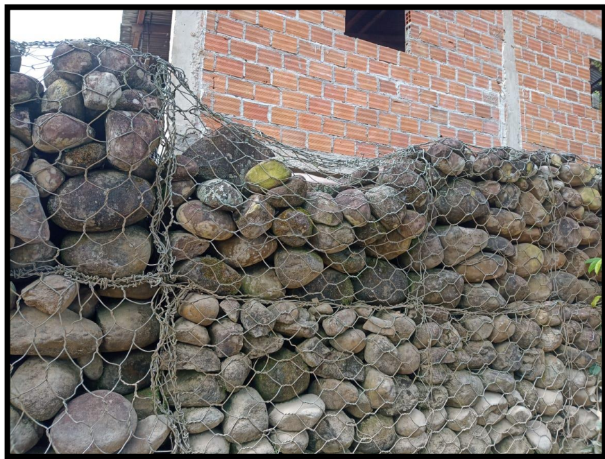
Figura 3: desplome de rocas y rotura de malla Fuente: Evidencia de campo
