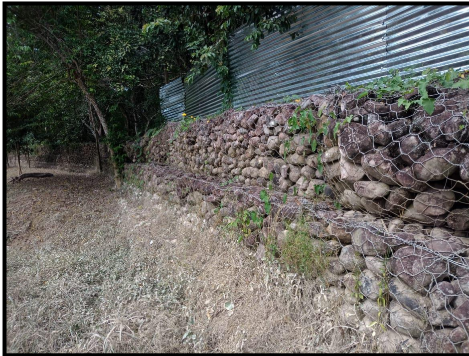
Figura 12: problemas de voltea en muros de gaviones
