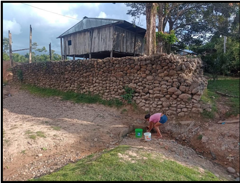
Figura 6: Desplome de muros de gaviones
