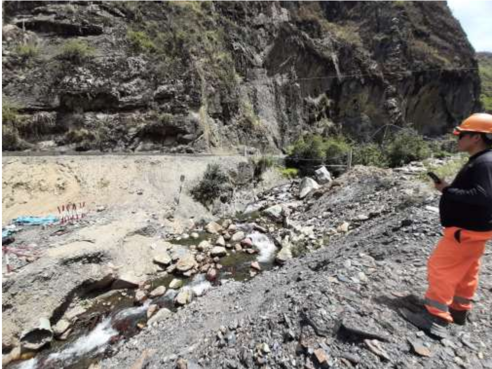
Imagen 9: Zona de Afectación por Erosión del Río Llactabamba
