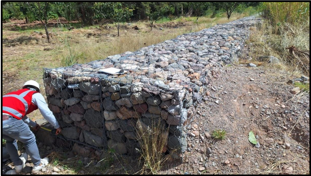
Figura 14: Se ve realiza la medición de las dimensiones del muro de gavión
