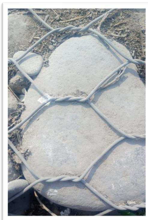
Figura 16: Uso del enmallado de tipo hexagonal con recubrimiento plastificado en el muro de gaviones del Río Chillón.
