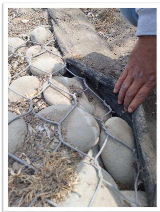
Figura 27: Soltura del geotextil en la progresiva 0+480 a 0+500 del Río Chillón.
