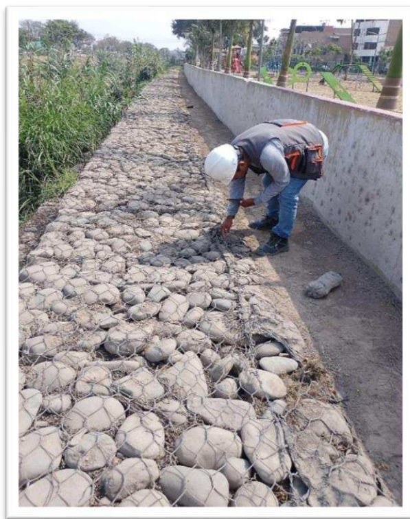
Figura 23: Destejido de la union del malla, en la progresiva+370 a 0+380 del Río Chillón.
