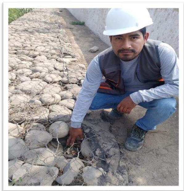
Figura 24: Vacio en el relleno petreo, en la progresiva+370 a 0+380 del Río Chillón.
