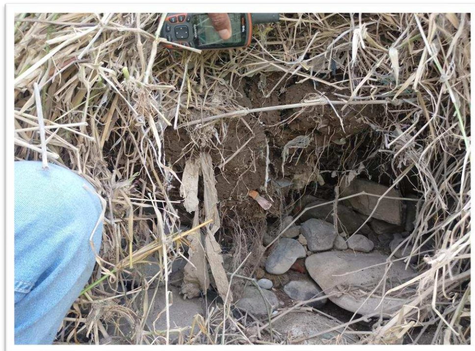
Figura 18: Socavación de la base del muro de gaviones en el margen derecho, progresiva 0+300 a 0+320 del Río Chillón.
