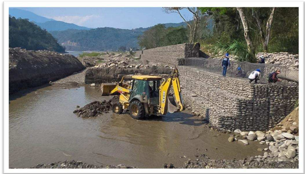
Figura 8: Defensa ribereña (Muro de gaviones)
