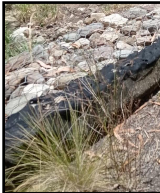
Figura 18: Geotextil de 2 mm, expuesto sin anclaje
