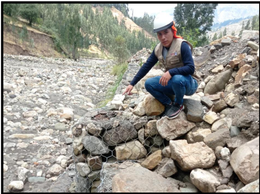
Figura 15: Muro de gabión con colchón amortiguador en mal estado
