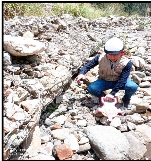
Figura 20: Muro de gavión colapsado por incremento del caudal del río
