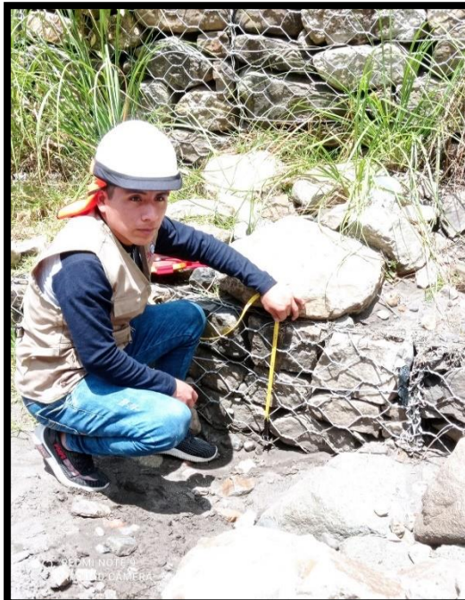
Figura 10: Acumulación de escombros y vegetación y altura de 0.45 m
