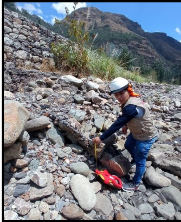
Figura 09: Malla expuesta y rota, medición del muro colapsado.
