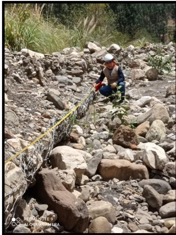
Figura 11: Acumulación de escombros y vegetación y altura de 0.45 m
