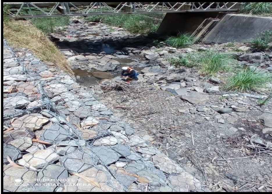
Figura 07: Escombros acumulados, vegetación, y medición de los diámetros de las piedras dentro del gavión.
