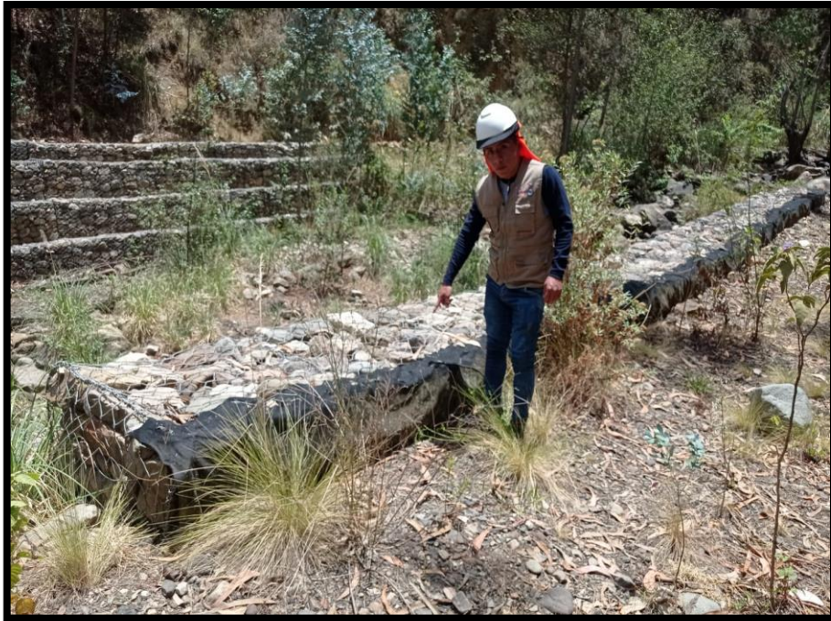
Figura 16: Geotextil para impermeabilizar el muro sin ningún tipo de anclaje
