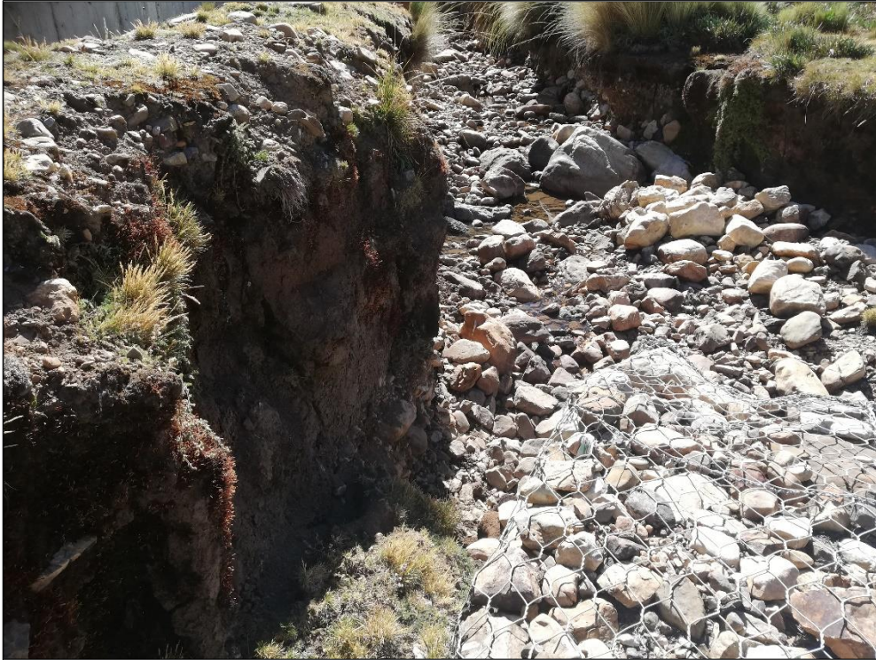
Fotografía 1. Se observa arrastre de sedimento con colapso de muro de gavion existente.
