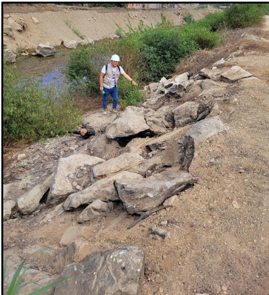
Figura 23: Desprendimiento de roca margen derecho.
