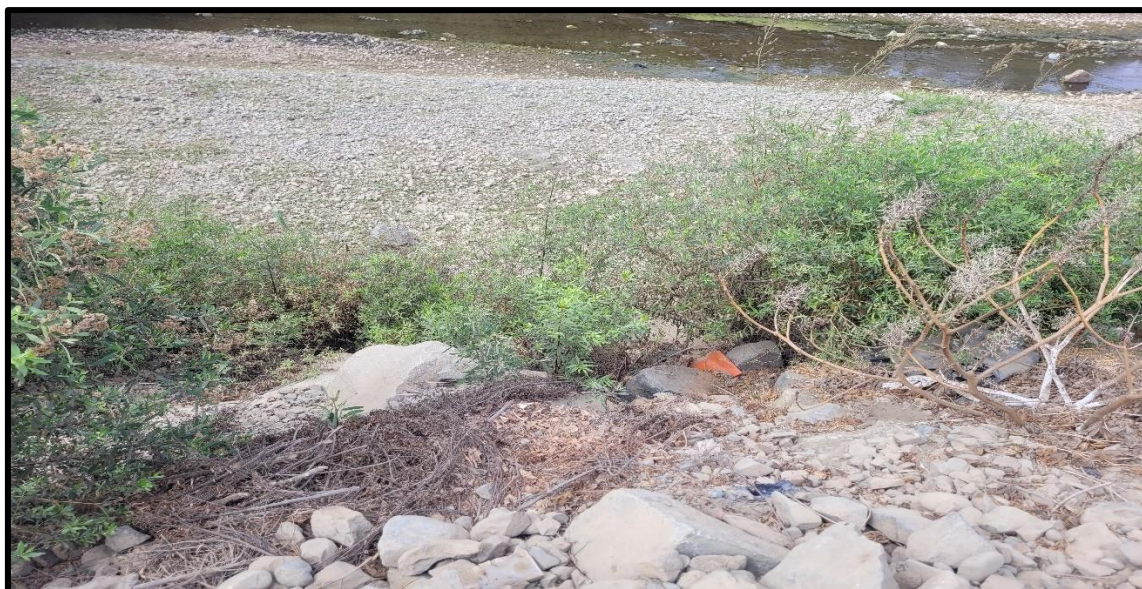
Figura 20: Vegetación y desprendimiento de rocas de menor diámetro.
