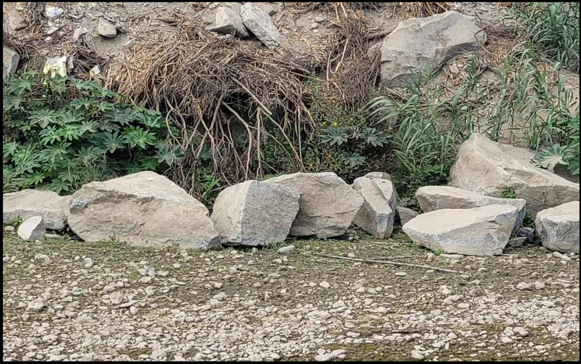
Figura 30: Caídas de rocas al cauce del río entre las progresivas 1+300 en la margen izquierda.
