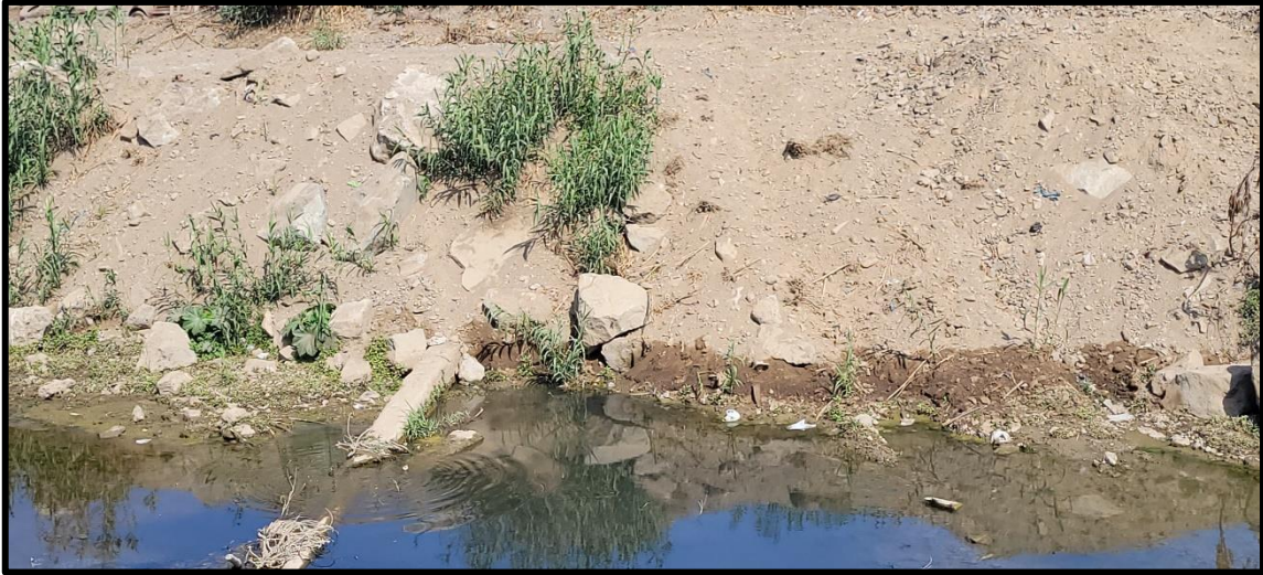
Figura 24: Desprendimiento de roca margen izquierdo.
