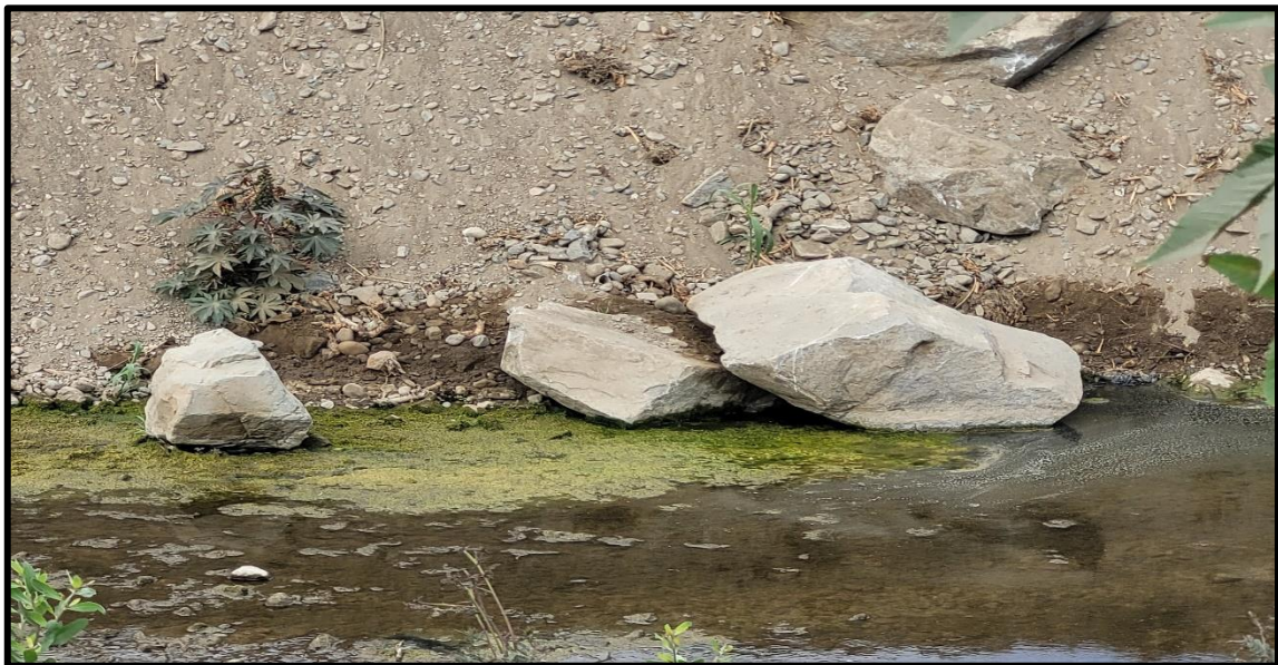
Figura 27: Socavación y rocas caídas al cauce del río y en la parte media del talud del margen izquierdo entre las progresivas 1+200 a 1+300.
