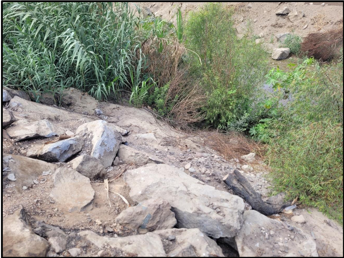
Figura 33: Desprendimiento de rocas en la progresiva 1+440 en la margen derecha.
