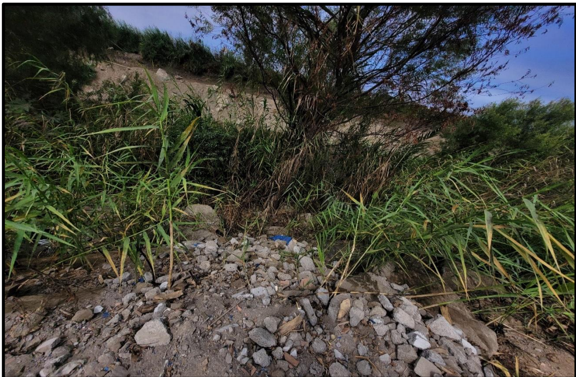
Figura 29: Presencia de material de desmonte y vegetación en el margen derecho entre las progresivas 1+312.
