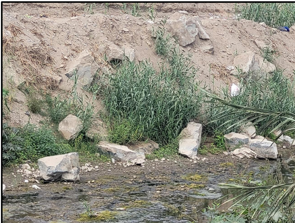
Figura 21: Vegetación y desprendimiento de rocas en la margen izquierda entre las progresiva 1+000 a 1+100.
