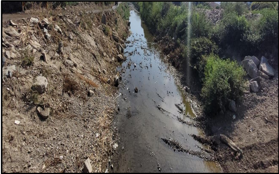
Figura 28: Cuarto tramo evaluado entre las progresiva 1+300 a 1+400.
