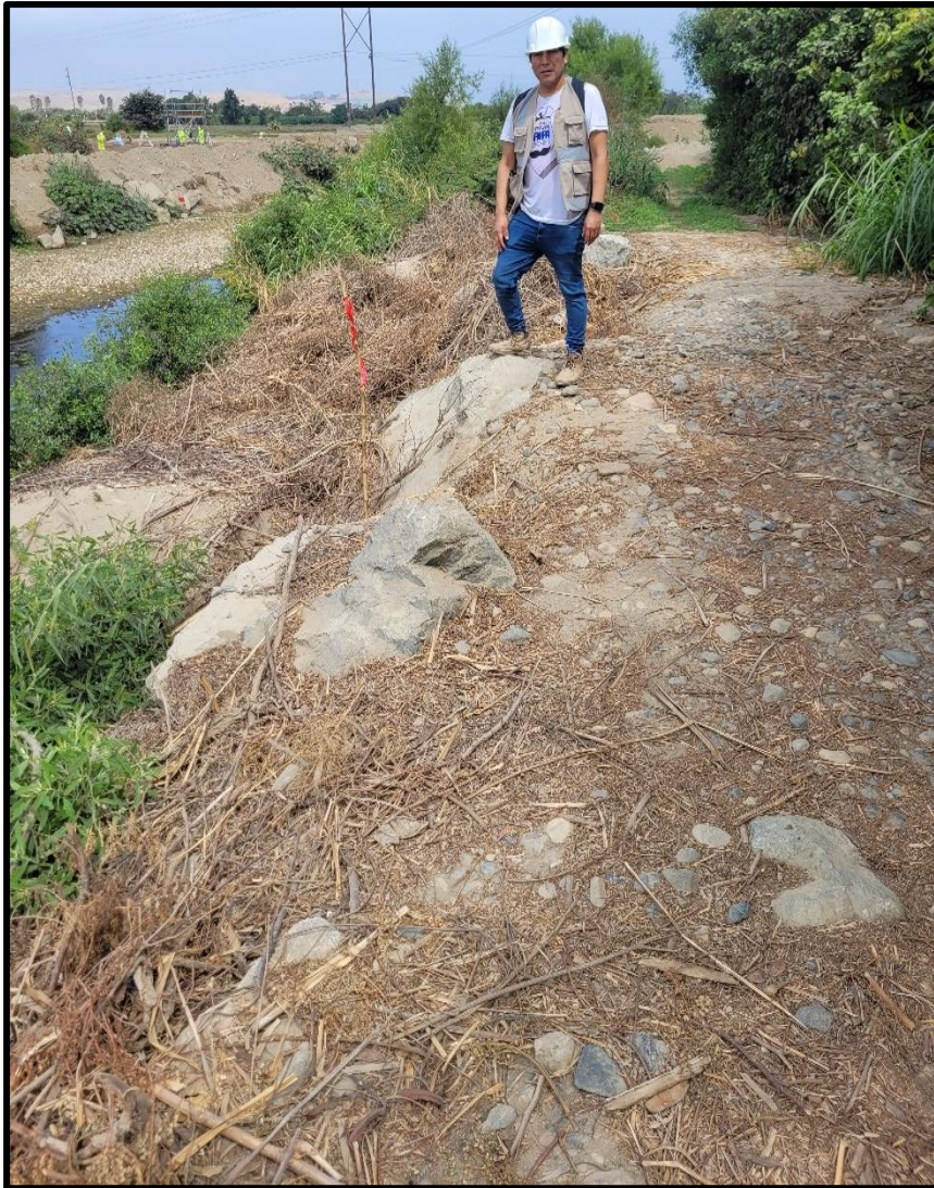
Figura 32: Vegetación y raíces secas en el enrocado en la progresiva 1+418.
