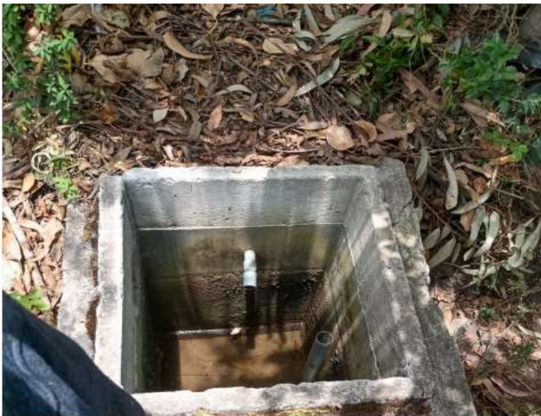
Figura 3 °Caja rompe presión se encuentra en mal estado (inoperativo)
