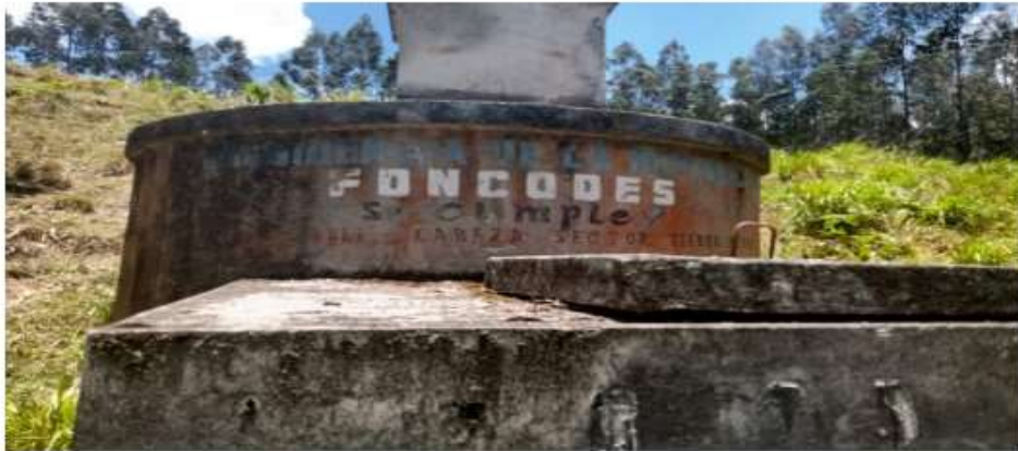
Figura 1 °Reservorio del sistema de agua potable (inoperativo)
