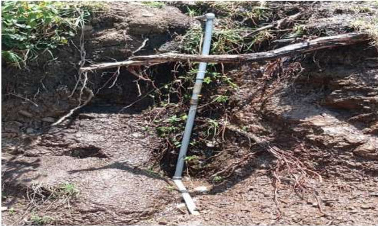
Figura 2 °tubería de conducción de PVC ¾ que se encuentra al aire libre en mal estado
